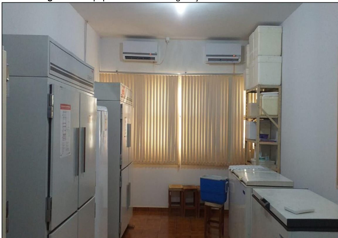
Figura 8 - Equipamentos de refrigeração da central de Vacinas
