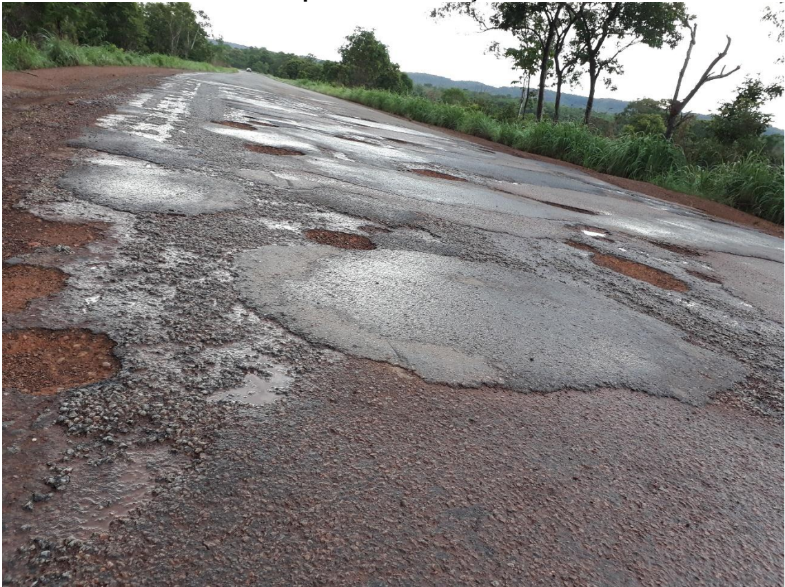
Figura 2: Trecho da rodovia TO 070 que liga Porto Nacional a Brejinho de Nazaré em péssimas condições de uso.
