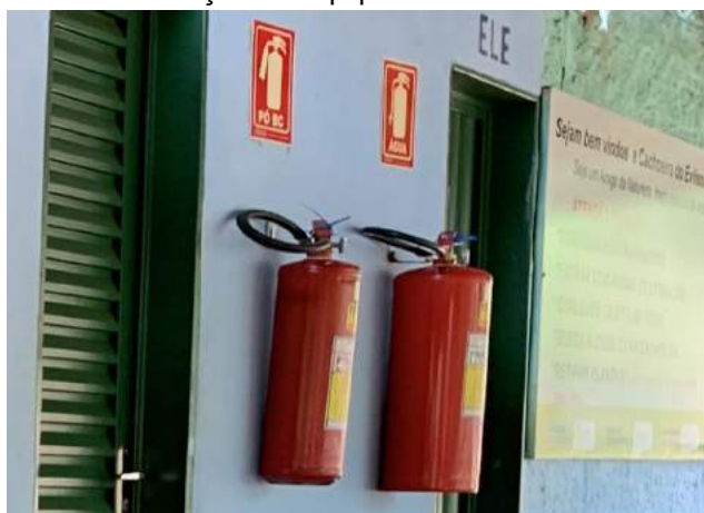
Figura 15 – Sinalização do Equipamento de Combate à Incêndio
