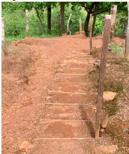
Figura 31 – Corrimão Invadindo a Escada
