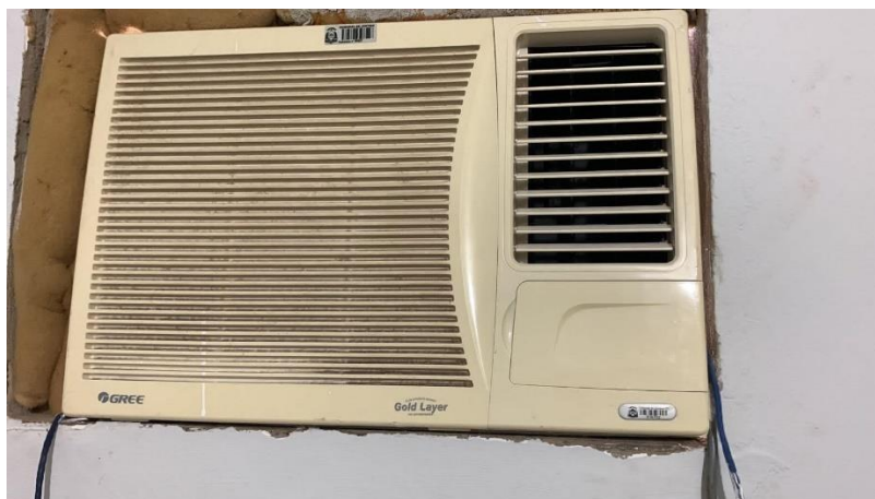
Figura 13 - Exemplo de ar-condicionado tipo Janela existente
