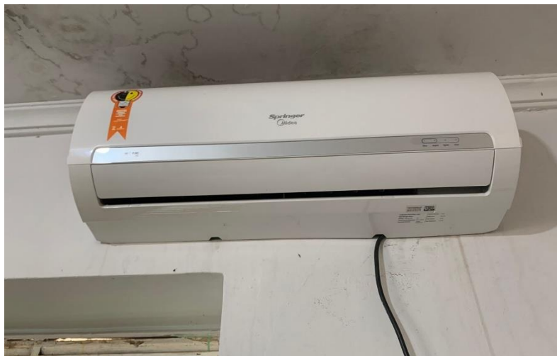
Figura 12 - Exemplo de ar-condicionado tipo Split existente
