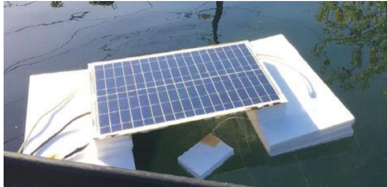
Figura 11 - Módulo FV instalado sobre água
