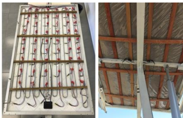
Figura 22 - Trocador de calor "Caso 1" acoplado ao módulo fotovoltaico e isolamento térmico
