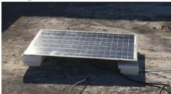
Figura 10 - Módulo FV instalado sobre o solo
