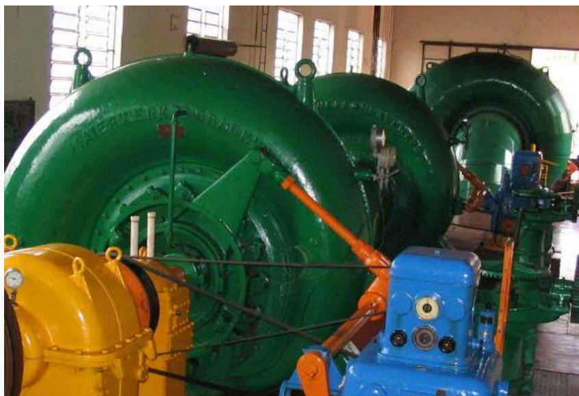
Figura 18: Turbinas da PCH Lajes.
