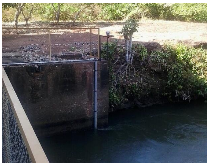
Figura 51: Sensor de nível de jusante.
