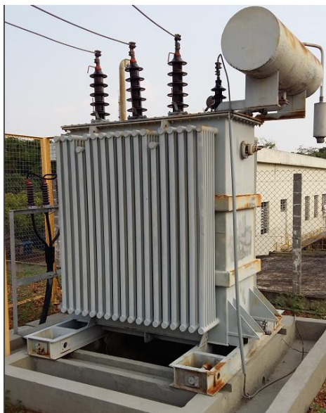
Figura 25: Transformador 1 da PCH Lajes.
