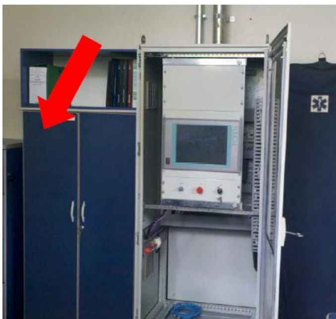
Figura 43: Local de instalação do painel de medições.
