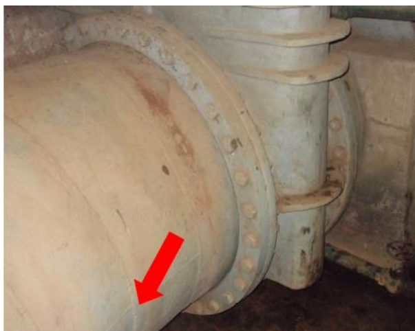
Figura 58: Local de instalação do transmissor de pressão UG1.
