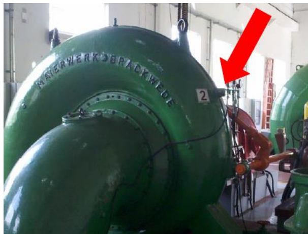
Figura 52: Local de instalação transmissor de pressão diferencial.
