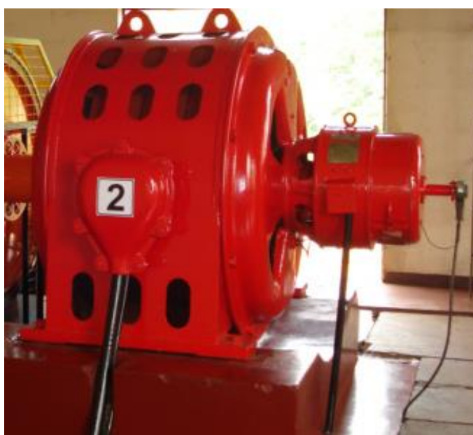
Figura 21: Gerador 2 da PCH Lajes.
