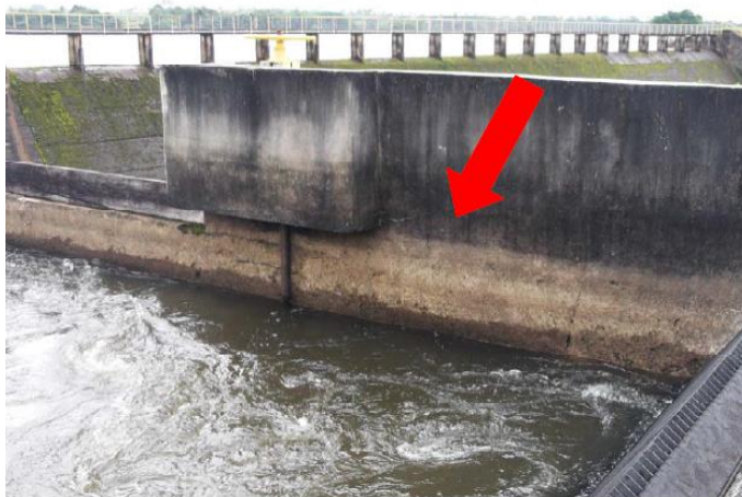
Figura 48: Local de instalação sonda câmara de carga.
