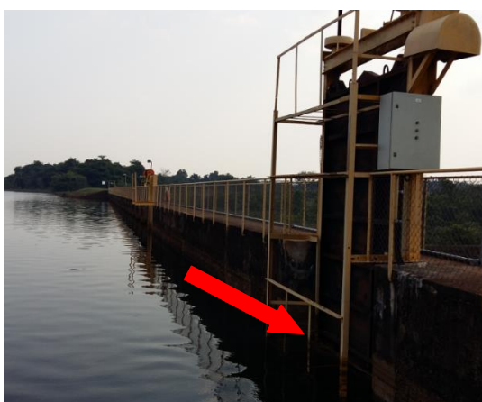
Figura 10: Comporta vagão da PCH Lajes.
