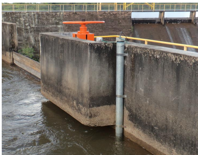
Figura 49: Sensor de nível da câmara de carga.
