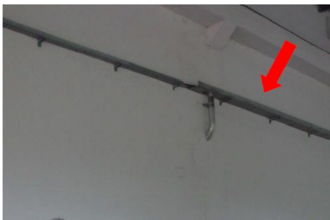
Figura 61: Local de passagem dos cabos de sinal.
