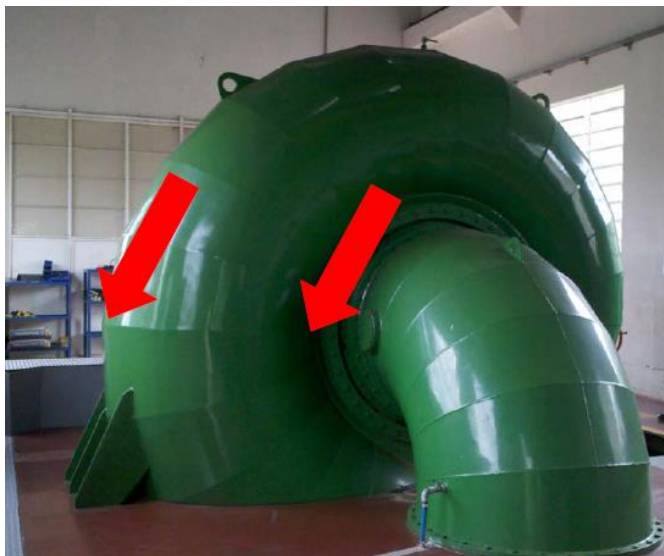
Figura 54: Local de instalação tomada de pressão.
