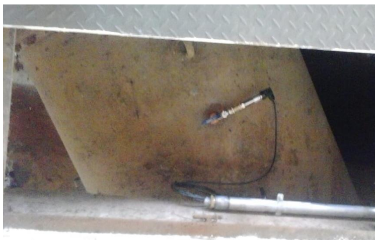
Figura 59: Transmissor de pressão UG1.
