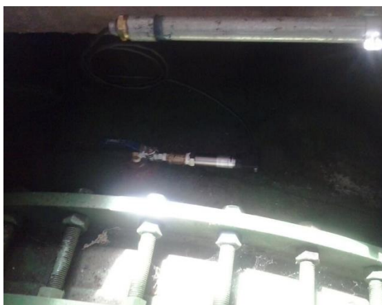
Figura 57: Local de instalação do transmissor de pressão UG3.
