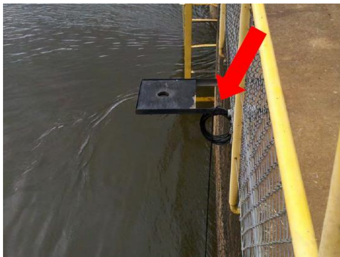
Figura 46: Local de instalação da sonda de montante.
