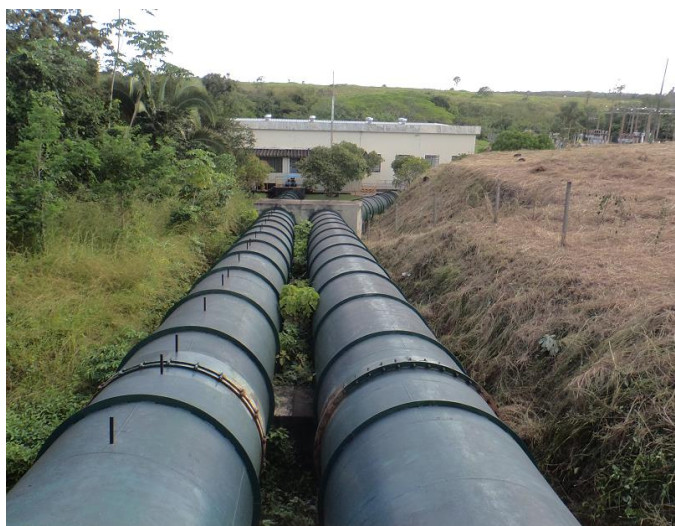
Figura 13: Condutos forçados da PCH Lajes.
