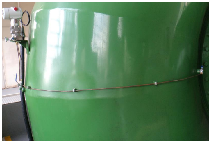
Figura 55: Tomadas de pressão.
