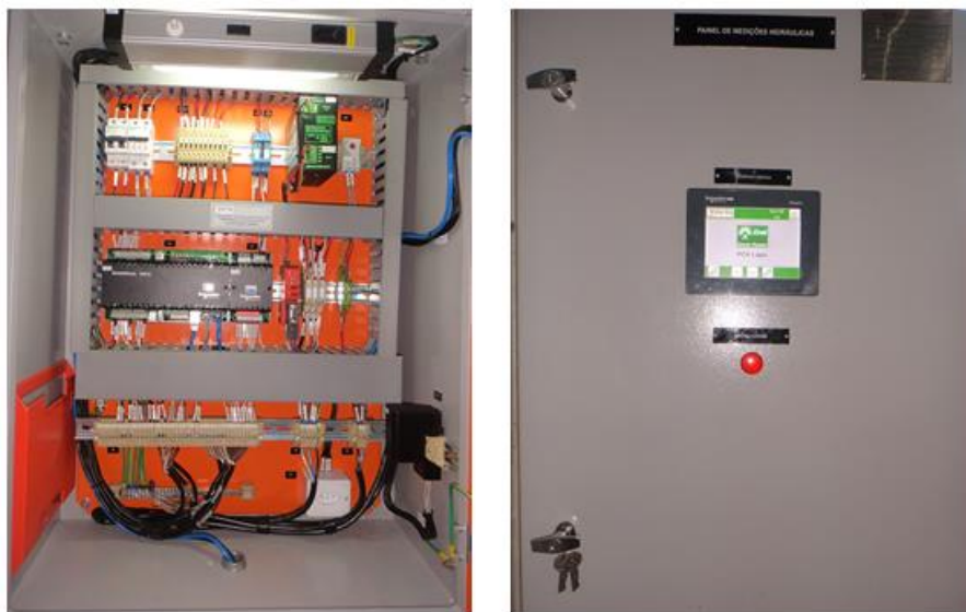
Figura 44: Painel de medições.
