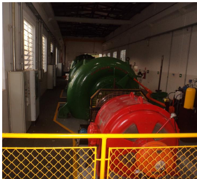
Figura 17: Visão interna da casa de máquinas da PCH Lajes.
