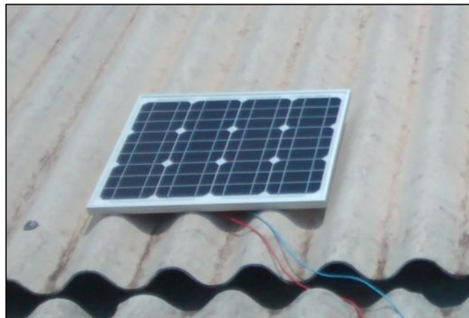
Figura 15 – Painel Solar Fotovoltaico Fixo (Convencional)
