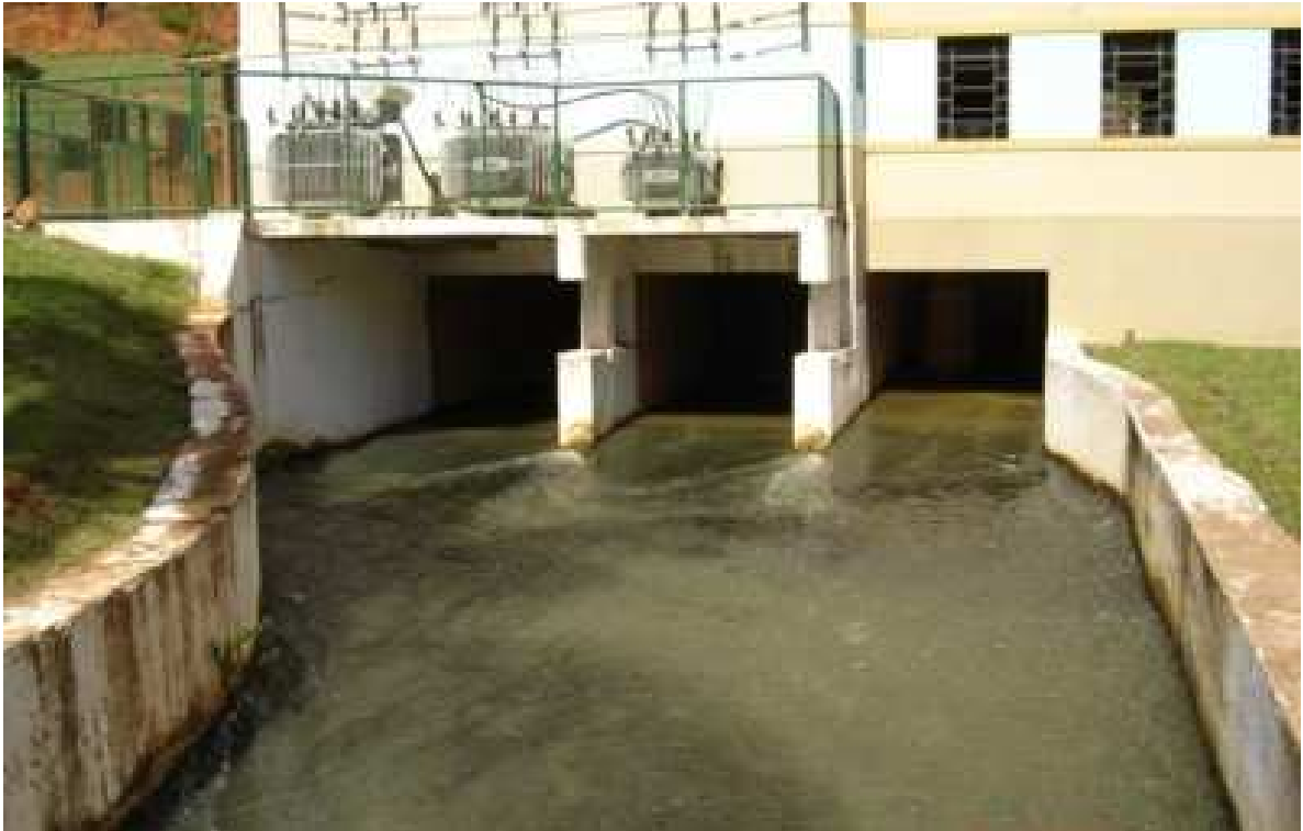
Figura 3.13: Canal de fuga.
