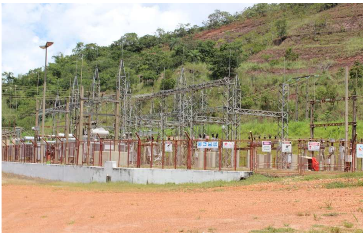
Figura 4.3: Subestação PCH Isamu Ikeda
