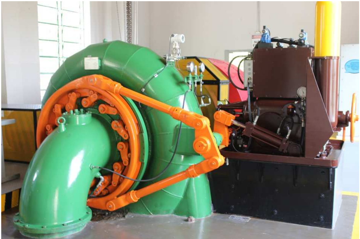
Figura 4.10: Turbina PCH Lajeado.
