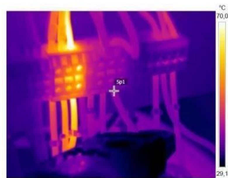
Figura 10 - Aquecimento de disjuntores de baixa tensão
