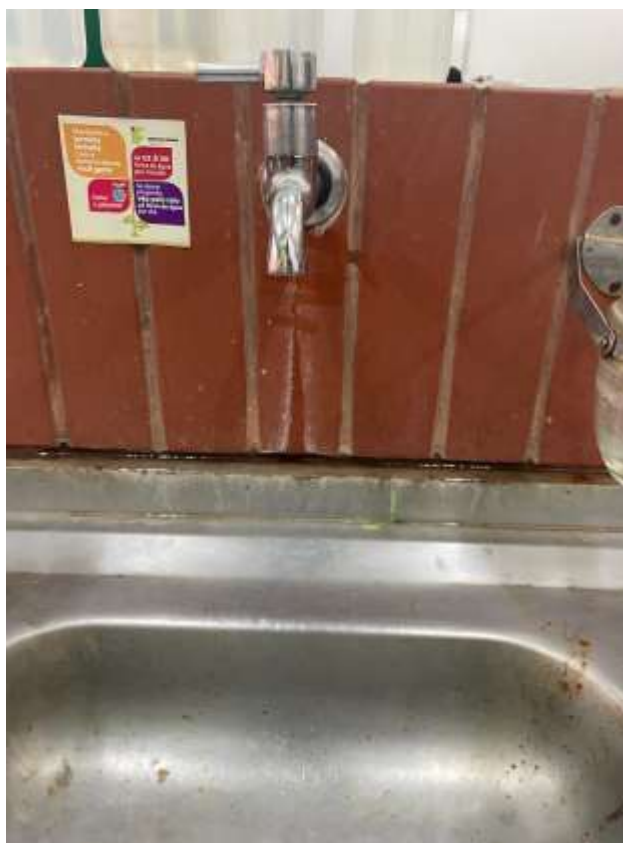
Figura 9 – Vazamento toneira laboratório bloco 7.
