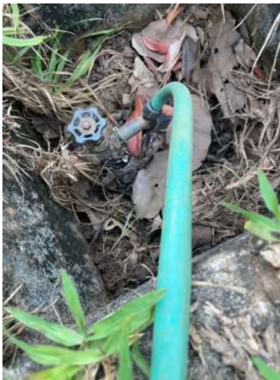
Figura 10 – Vazamento torneira de jardim bloco 11A
