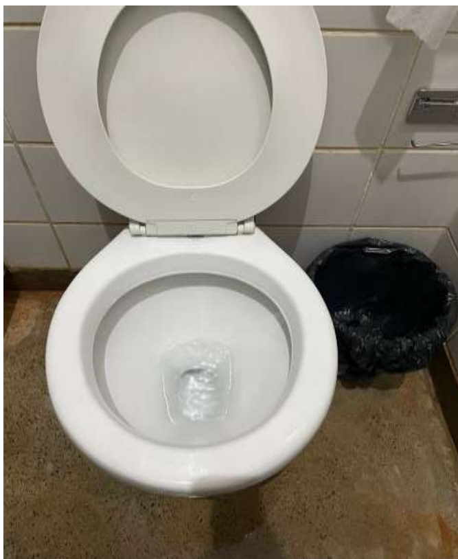
Figura 7 – Vazamento bacia sanitária vaso bloco 2.
