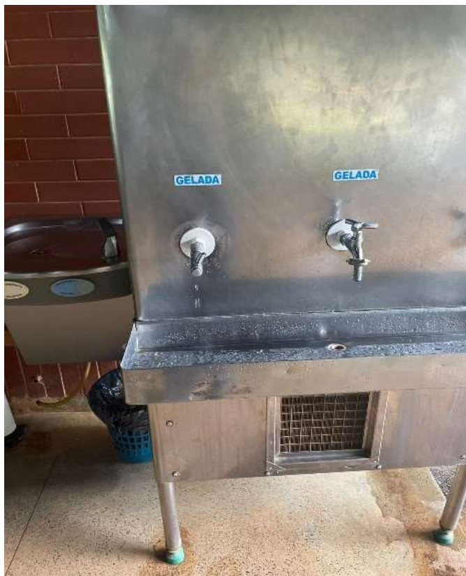
Figura 8 – Vazamento bebedouro bloco 2
