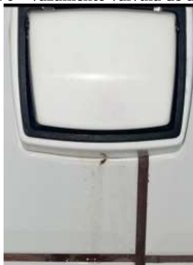
Figura 6 – vazamento valvula de descarga.
