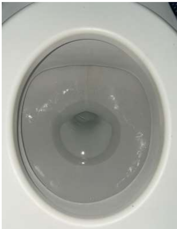
Figura 5 – vazamento bacia sanitária banheiro biblioteca
