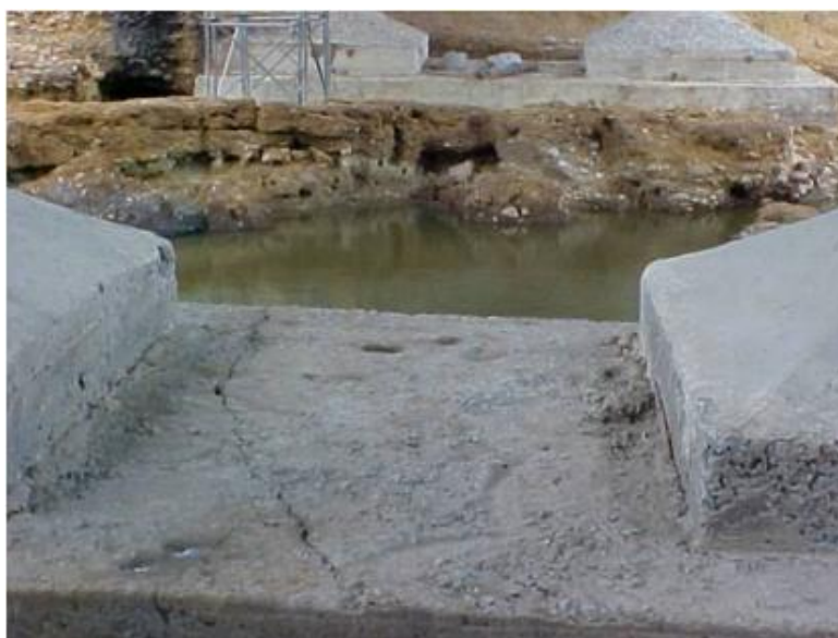
Figura 44 - Ruptura do Bloco e descalçamento da fundação
