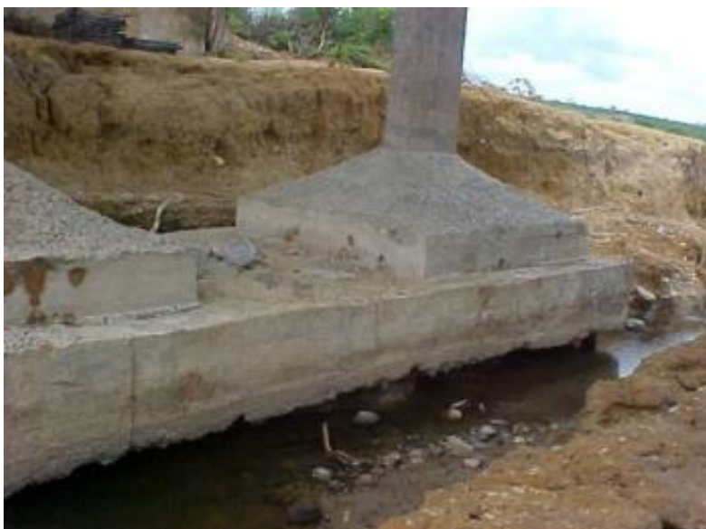
Figura 45 - Fuga de material sob as fundações, causando risco de ruptura da obra.
