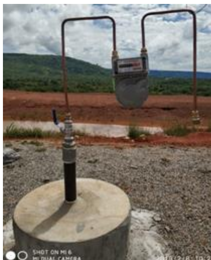
Figura 8 - Medidor de vazão de biogás no Aterro Sanitário de Palmas - Tocantins
