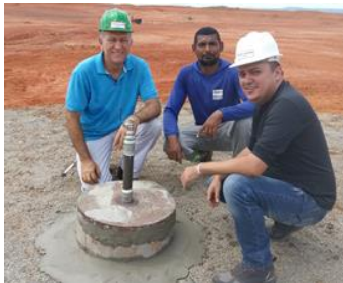
Figura 7 - Adaptação do sistema para captação de gases no Aterro Sanitário de Palmas - Tocantins
