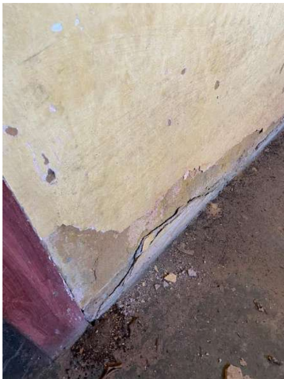
Figura 78 – Deslocamento de revestimento
