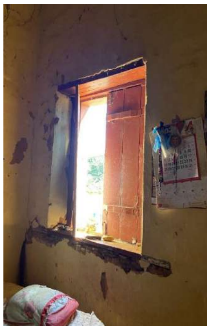
Figura 42 – Deslocamento com exposição de alvenaria
