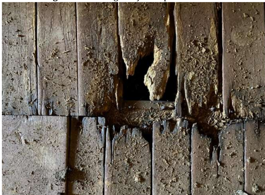
Figura 48.1 – Degradação do piso de madeira
