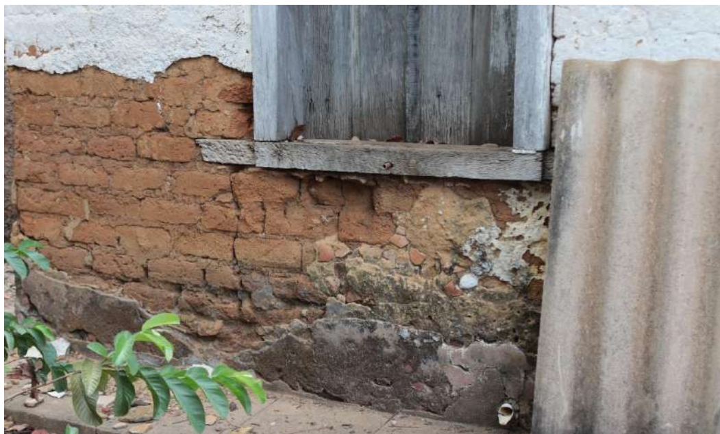
Figura 27.2 – Desplacamento com exposição de alvenaria
