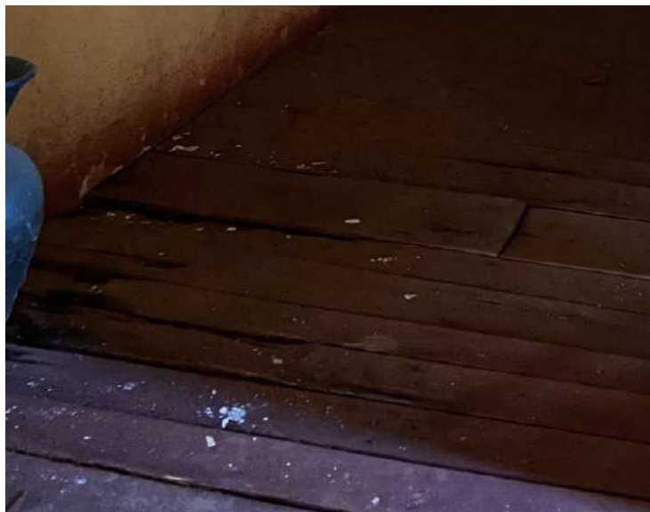
Figura 46 – Degradação do piso de madeira
