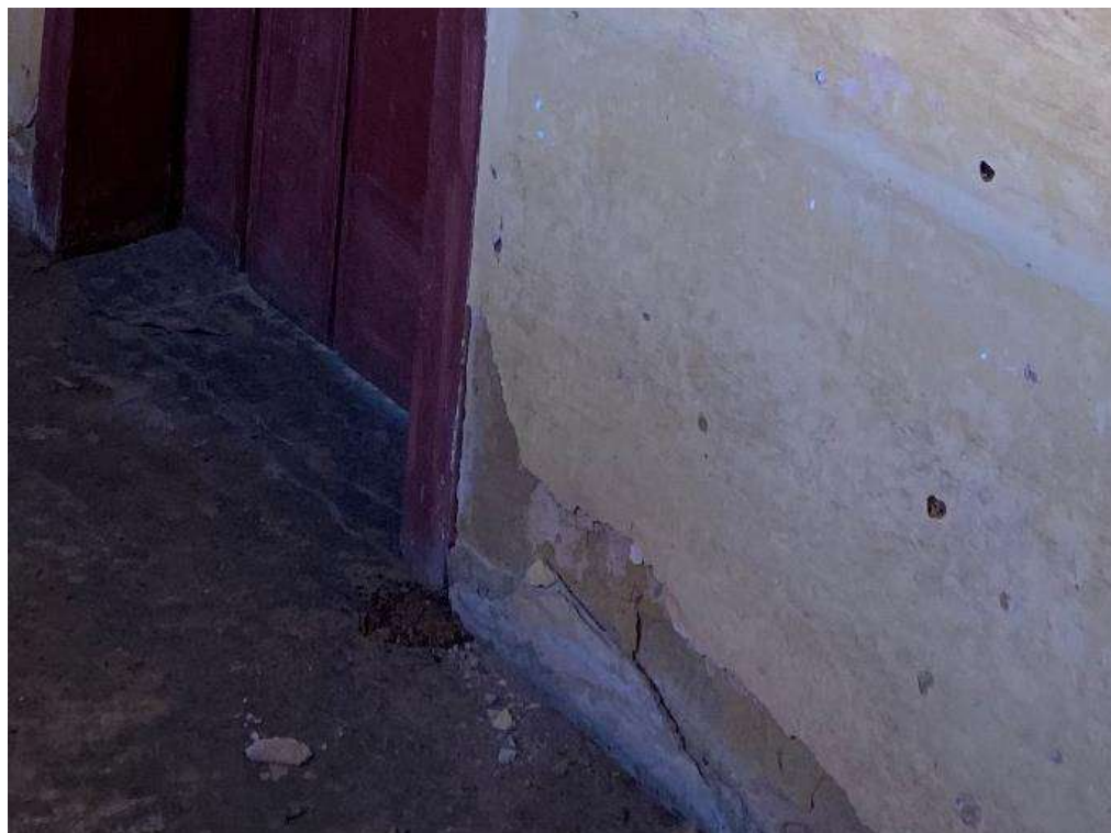
Figura 76 – Desplacamento de revestimento
