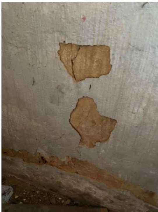
Figura 66 – Infiltração e Rachadura
