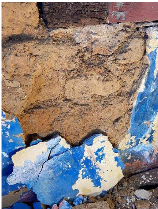
Figura 34 – Desplacamento expo. de alvenaria
