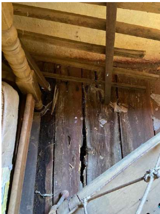
Figura 39 – Degradação piso de madeira
