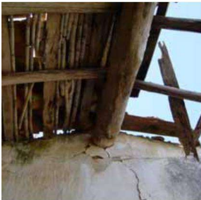
Figura 07 - Esmagamento localizado (apoio de viga cumeeira)
