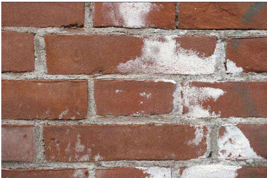
Figura 05 - Eflorescência em parede com tijolo aparente
