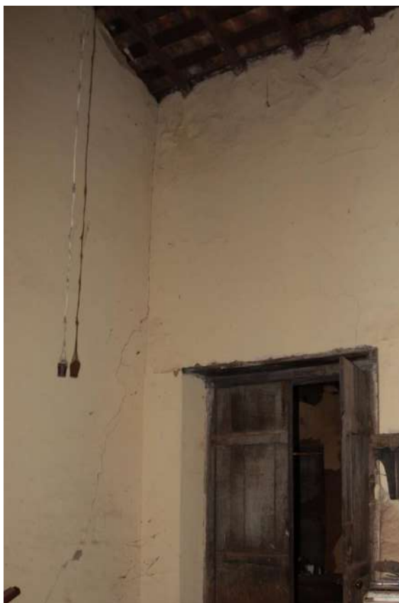
Figura 49 – Fissura e Infiltração
