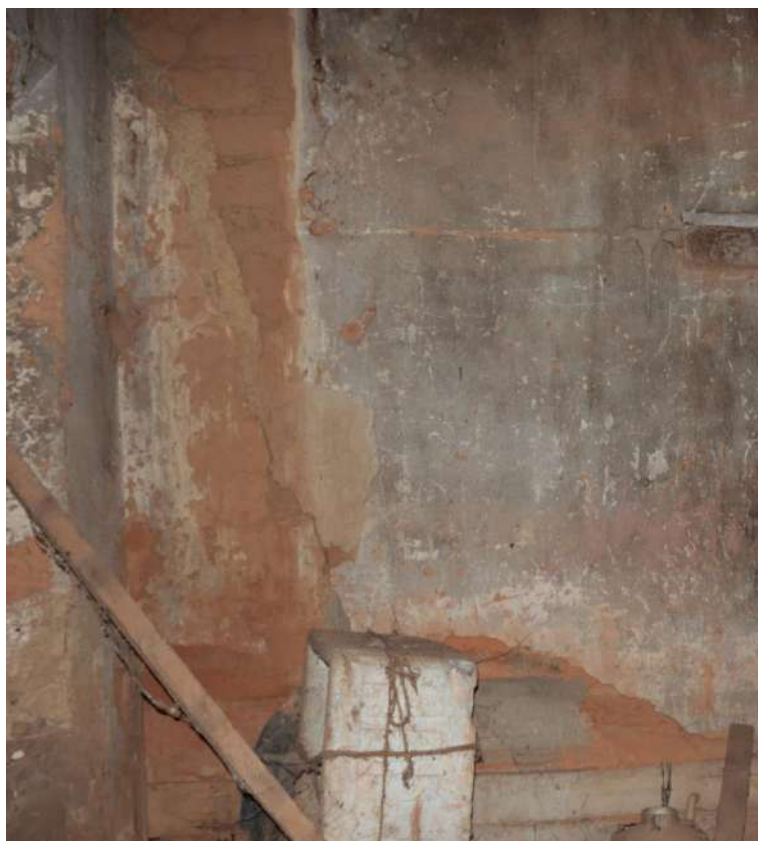
Figura 81 – Desplacamento com exposição de alvenaria
