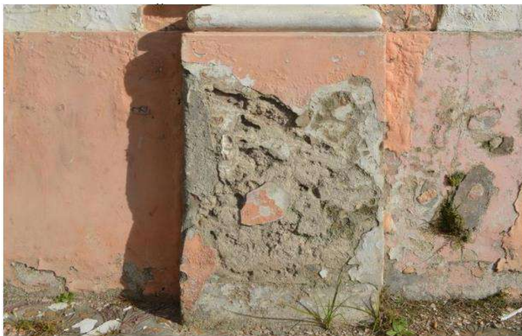
Figura 3.1 - Desplacamento de reboco em pilar de edificação
