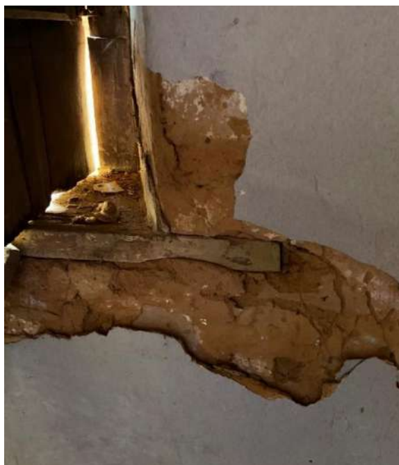
Figura 71 – Desplacamento com exposição de alvenaria
