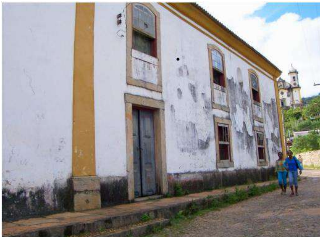
Figura 6.3 - Possível mancha de infiltração - Igreja Nossa Senhora do Rosário – MG
