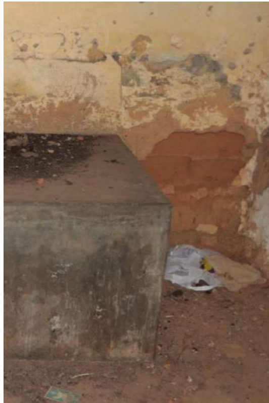
Figura 77 – Deslocamento com exposição de alvenaria
