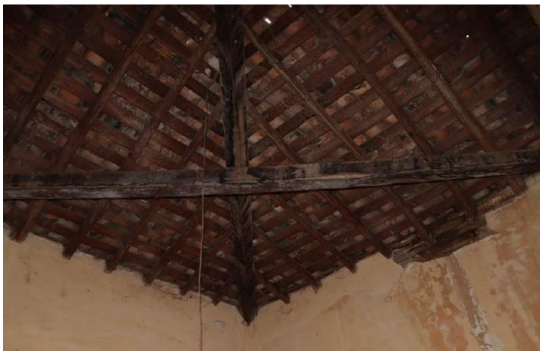
Figura 32.1 – Deformação excessiva no telhado
