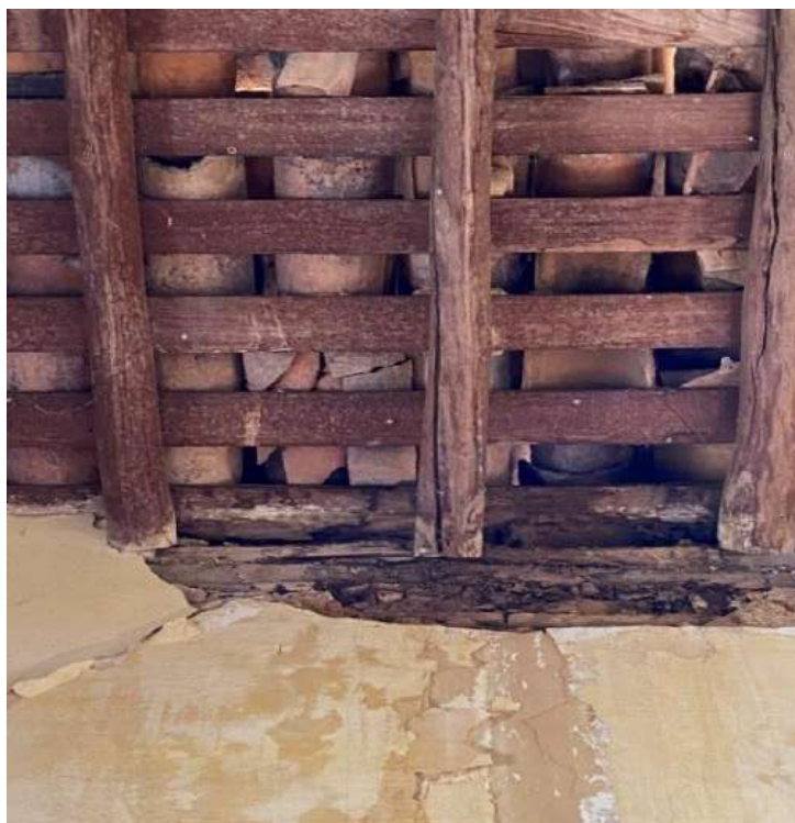
Figura 32 – Deformação excessiva no telhado
