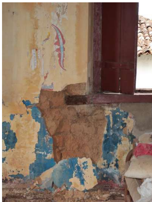
Figura 34.1 – Desplacamento expo. de alvenaria
