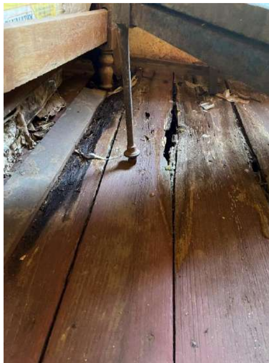
Figura 39.1 – Degradação piso de madeira
