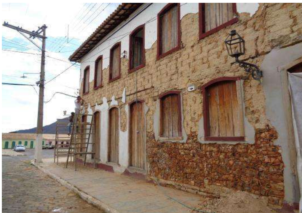
Figura 03 - Deslocamento de reboco em casarão
