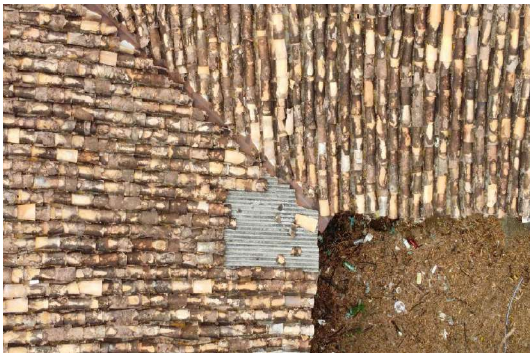
Figura 31.1 – Detalhe da tentativa de manutenção do telhado
