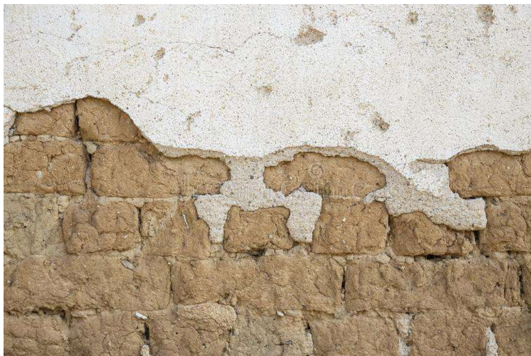
Figura 3.2 - Desplacamento de reboco em estrutura de adobe
