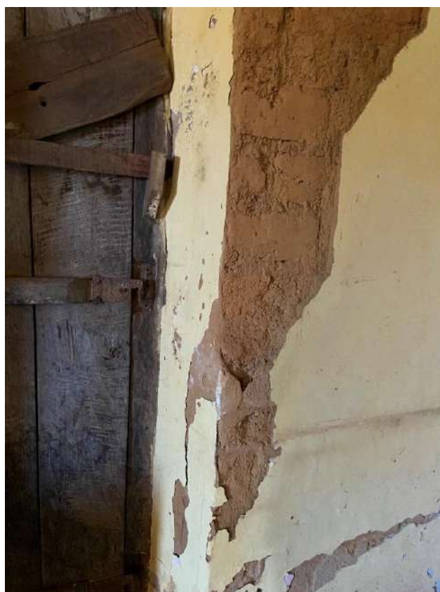
Figura 54 – Desplacamento com exposição de alvenaria
