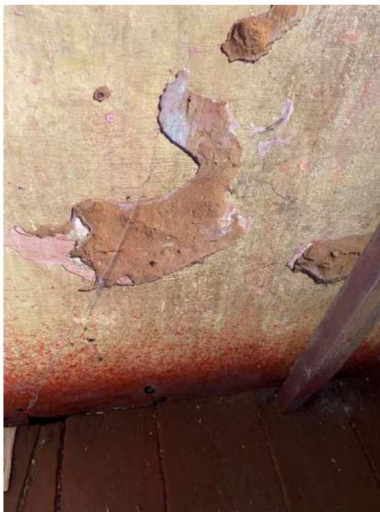
Figura 55 – Desplacamento de revestimento
