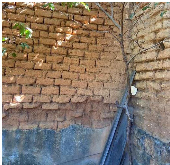
Figura 26.1 – Lixiviação na parede acima
