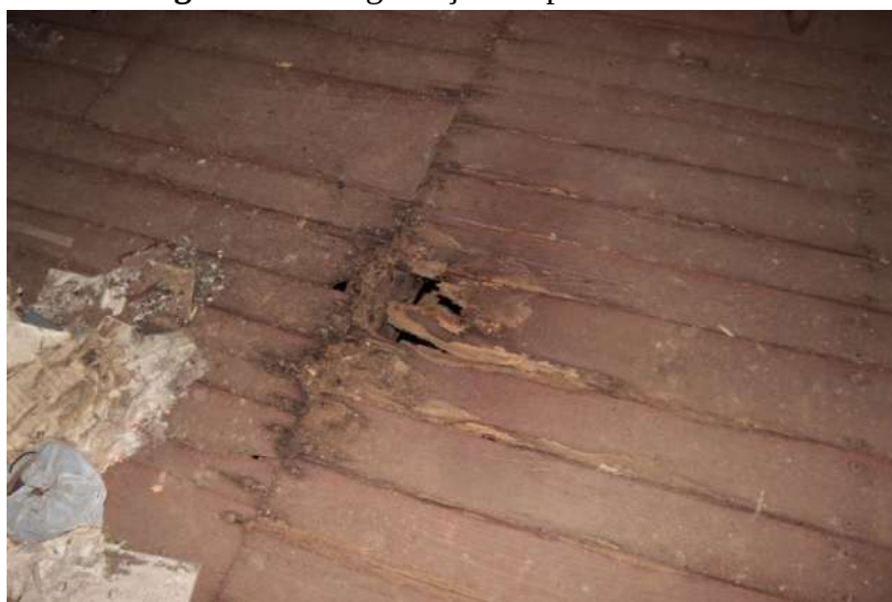
Figura 48 – Degradação do piso de madeira
