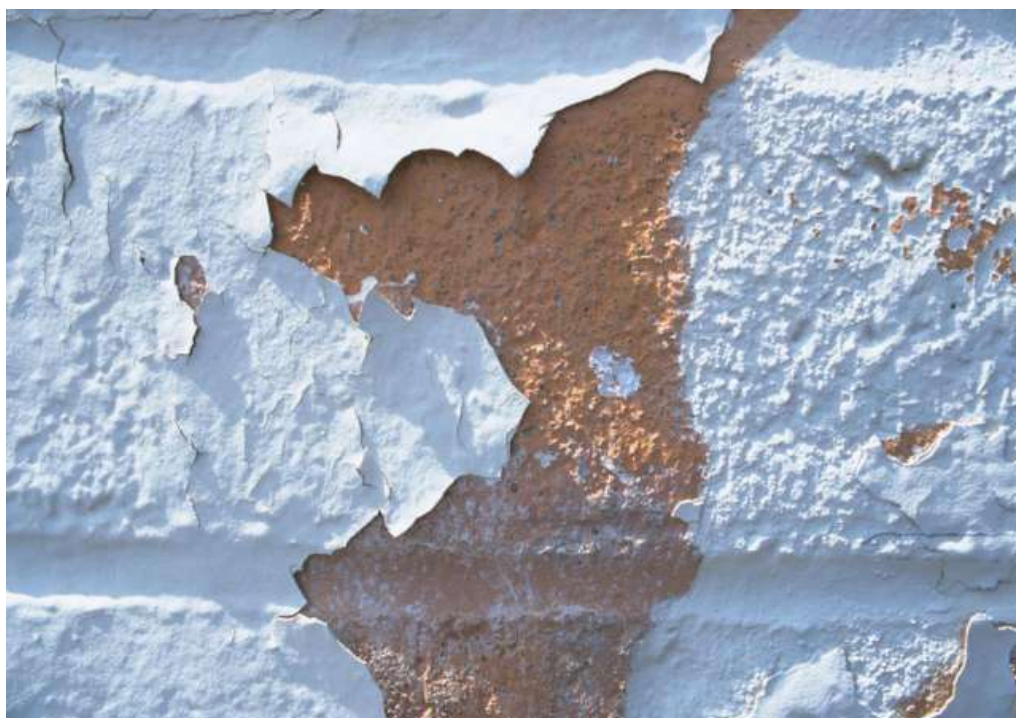
Figura 6.1 - Possível Infiltração por excesso de chuva
