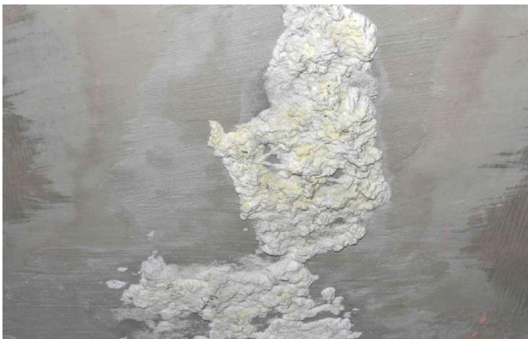
Figura 5.1 - Eflorescência em fundo de laje
