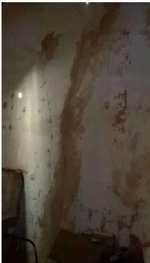
Figura 41 – Fissura e intervenção com preenchimento de cimento
