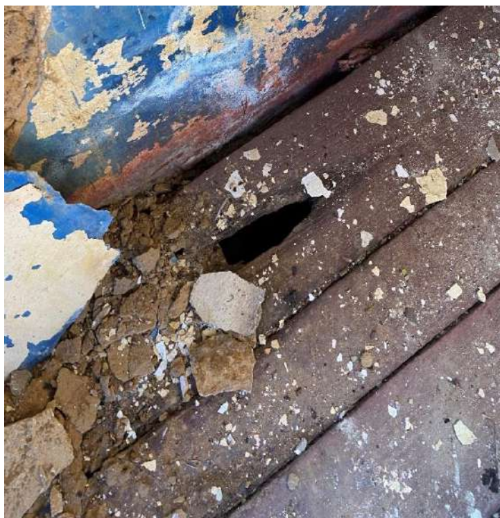
Figura 33 – Degradação do piso de madeira
