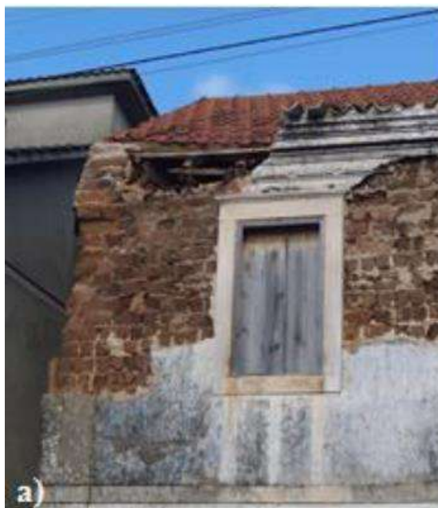
Figura 7.1 – Concentração de carga e degradação na zona da face superior da parede
