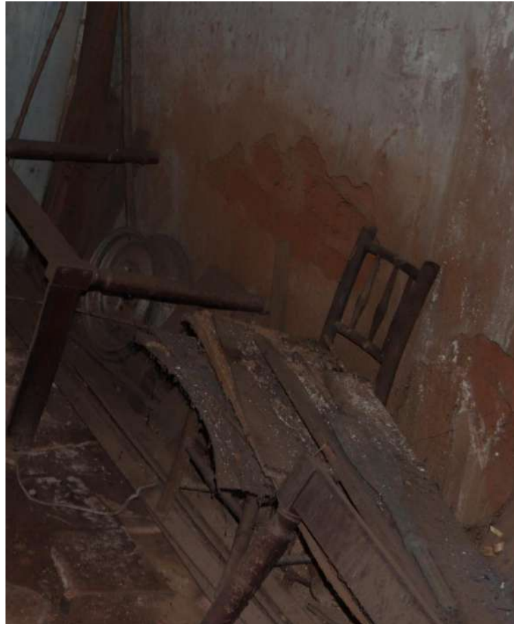
Figura 51 – Desplacamento com exposição de alvenaria
