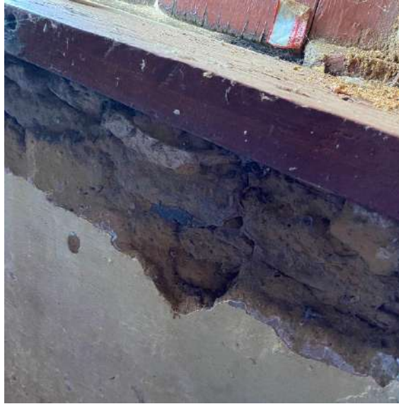
Figura 42.1 – Desplacamento com exposição de alvenaria
