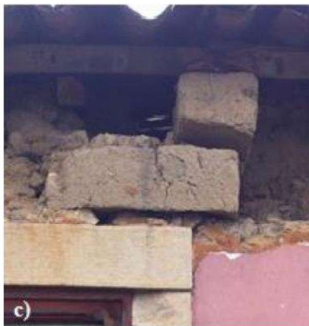
Figura 7.2 - Esmagamento dos blocos e consequente desagregação da parede
