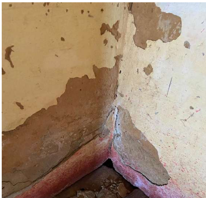
Figura 57 – Infiltração e Desplacamento de revestimento
