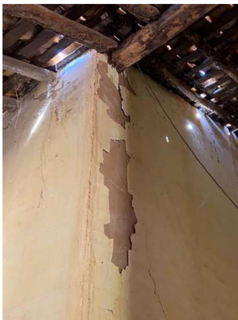
Figura 45 – Concentração de carga e Deslocamento de revestimento
