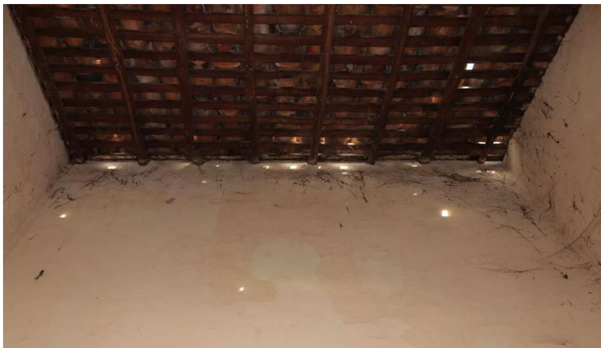
Figura 50 – Falha na cobertura
