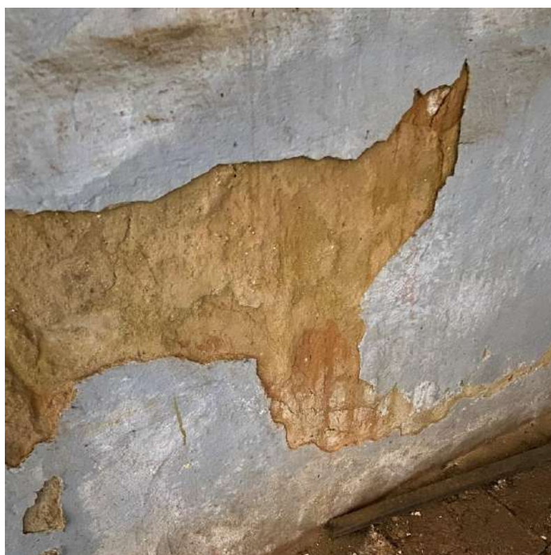
Figura 63 – Deslocamento com exposição de alvenaria
