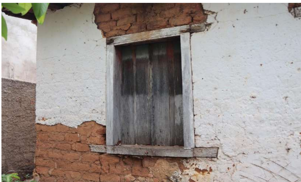
Figura 27.1 – Desplacamento com exposição de alvenaria
