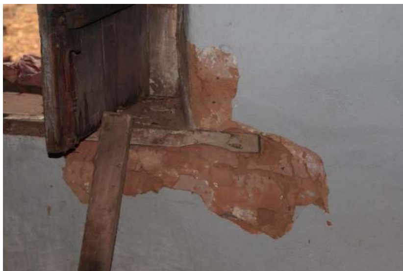
Figura 62 – Deslocamento com exposição de alvenaria
