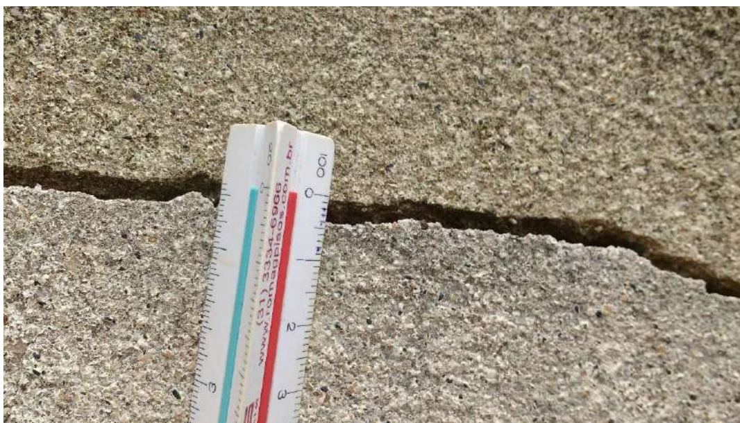
Figura 2.3 - Representação de Rachadura
