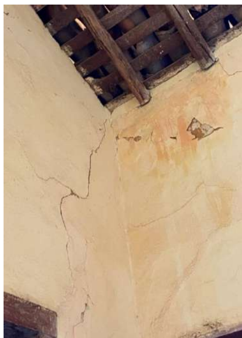
Figura 44 – Infiltração e Rachadura
