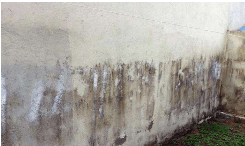
Figura 04 - Manifestação de mofo em Muro
