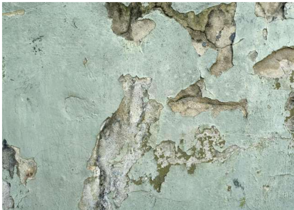
Figura 6.2 - Possível Infiltração causada por problemas em instalação hidráulica.
