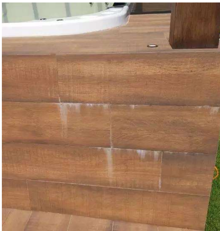
Figura 5.2 - Eflorescência em revestimento possivelmente causada por infiltração
