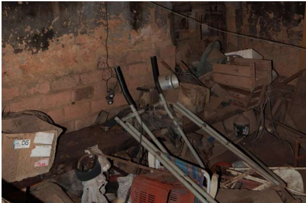
Figura 83 – Desplacamento com exposição de alvenaria
