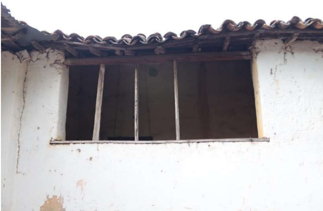
Figura 29.2 – Patologia na estrutura da parede externa do lado direito
