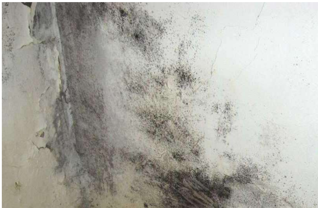
Figura 4.1 - Manifestação de mofo em parede interna de edificação.
