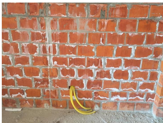
Figura 3 - Eflorescência identificada no painel de alvenaria.
