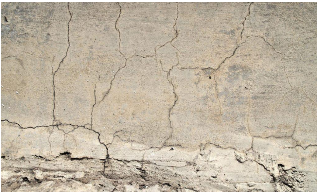
Figura 5 - Fissuras em alvenaria.
