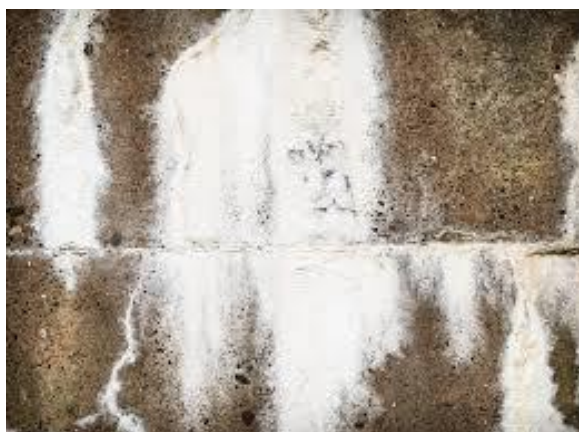
Figura 4 - Eflorescência identificada no painel de alvenaria.
