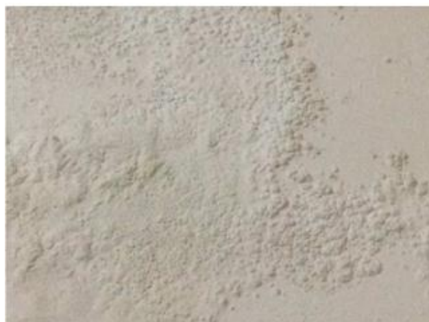
Figura 8 - Descolamento com empolamento em revestimento argamassado com pintura
