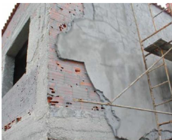
Figura 9 - Alvenaria apresenta argamassa com problemas de descolamento em placas
