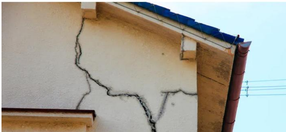
Figura 6 - Fissura devido sobrecarga.
