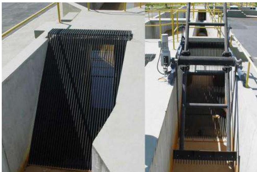
Figura 8 – Gradeamento em uma ETE
