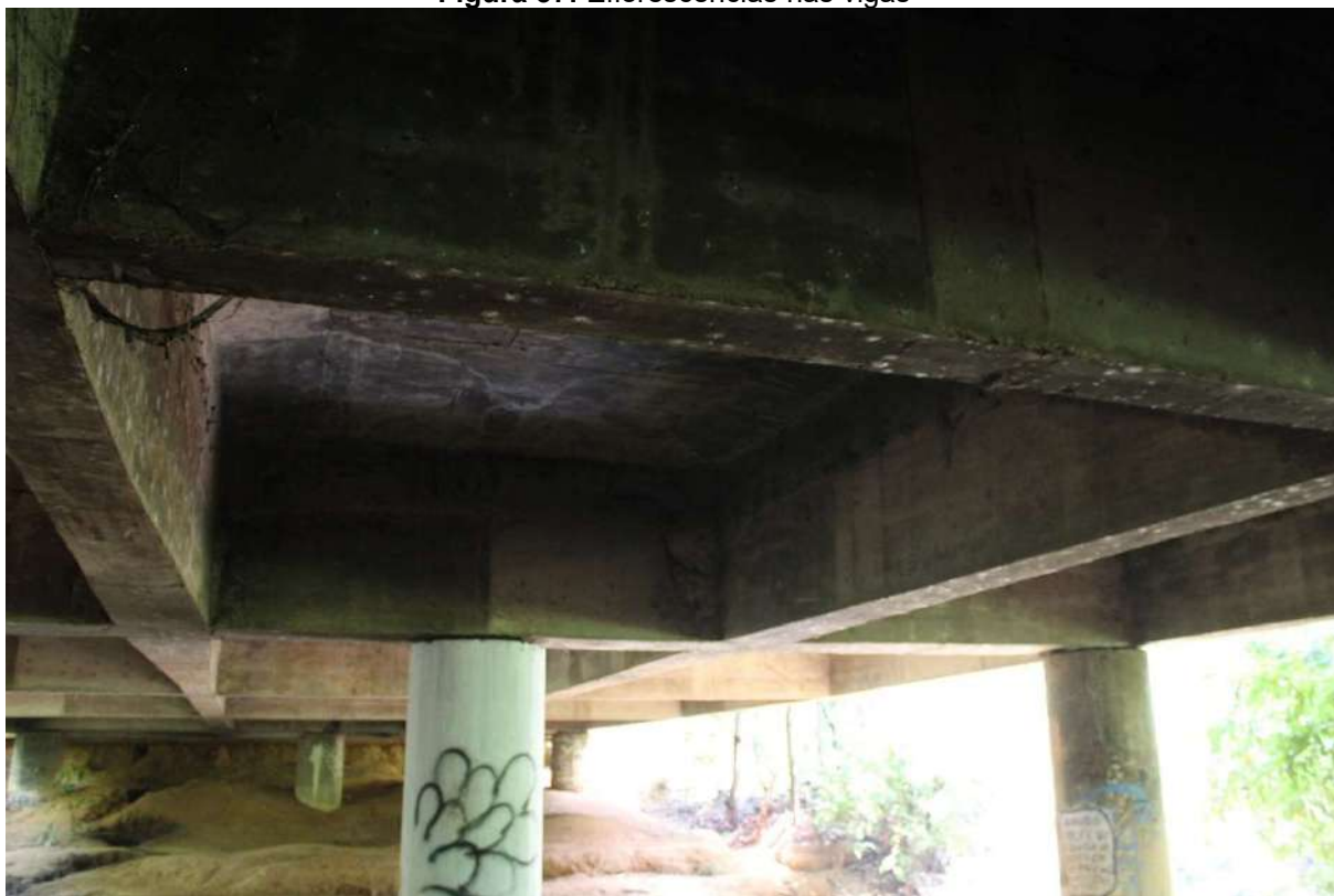
Figura 37: Eflorescências nas vigas
