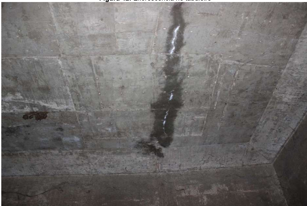
Figura 42: Eflorescência no tabuleiro
