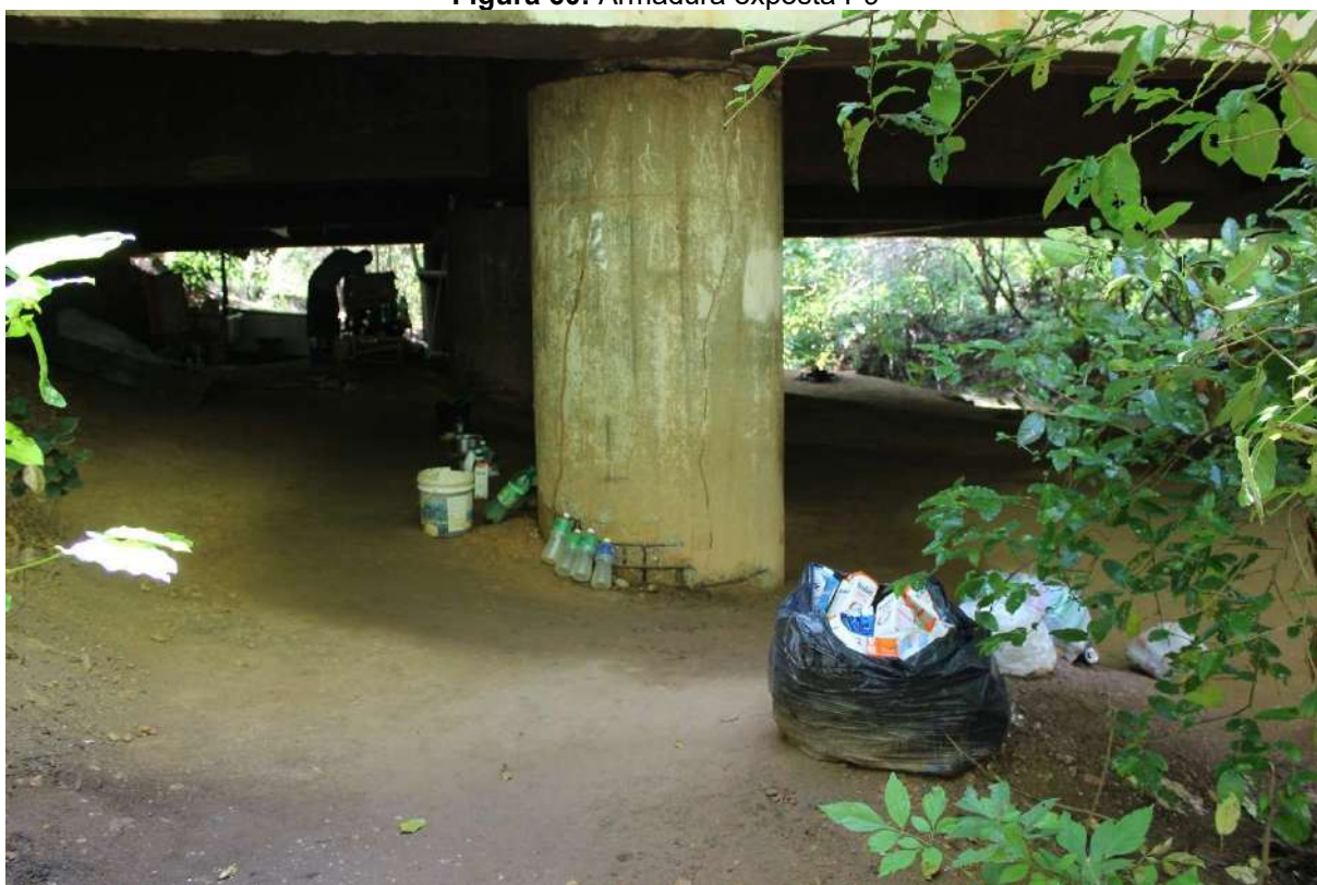
Figura 60: Armadura exposta P9
