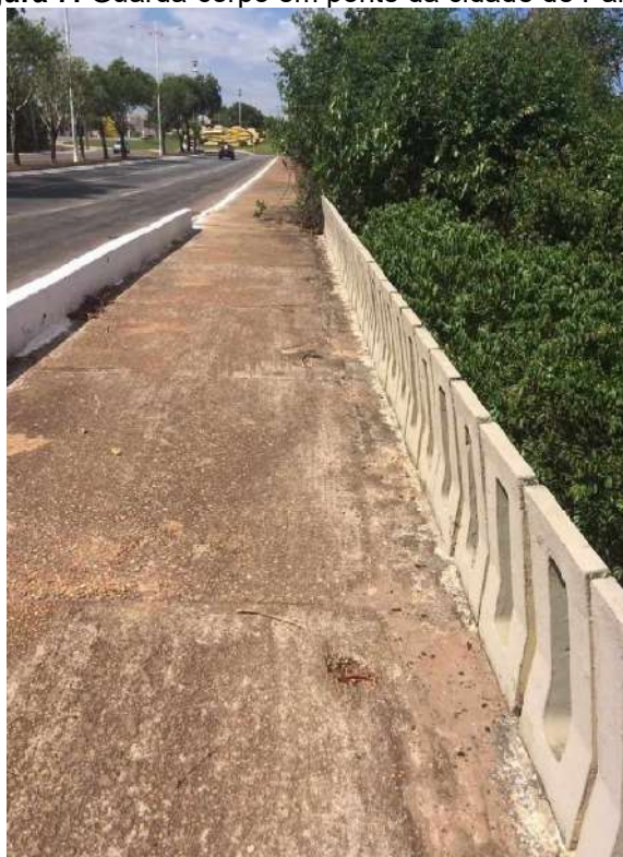
Figura 7: Guarda-corpo em ponte da cidade de Palmas
