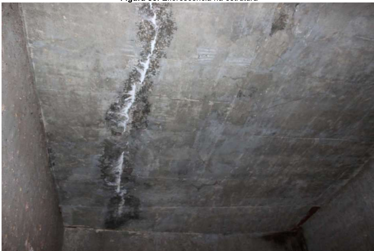
Figura 85: Eflorescência na estrutura
