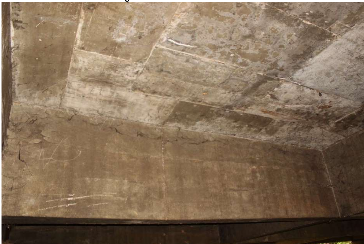
Figura 44: Eflorescência no tabuleiro
