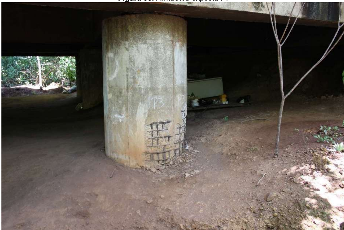
Figura 65: Armadura exposta P7
