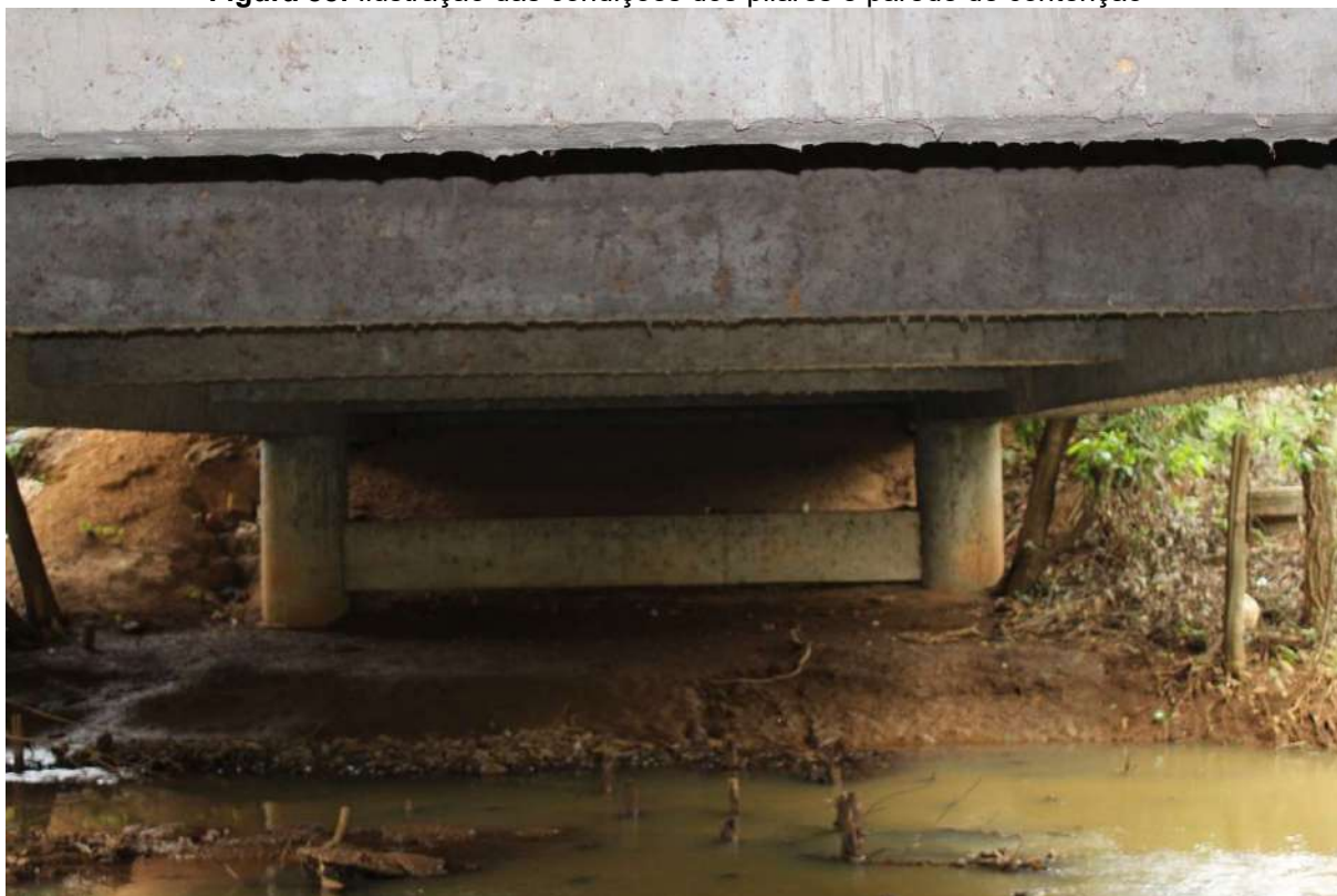
Figura 88: Ilustração das condições dos pilares e parede de contenção
