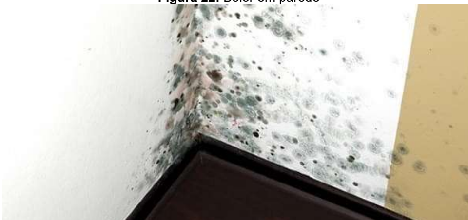
Figura 22: Bolor em parede
