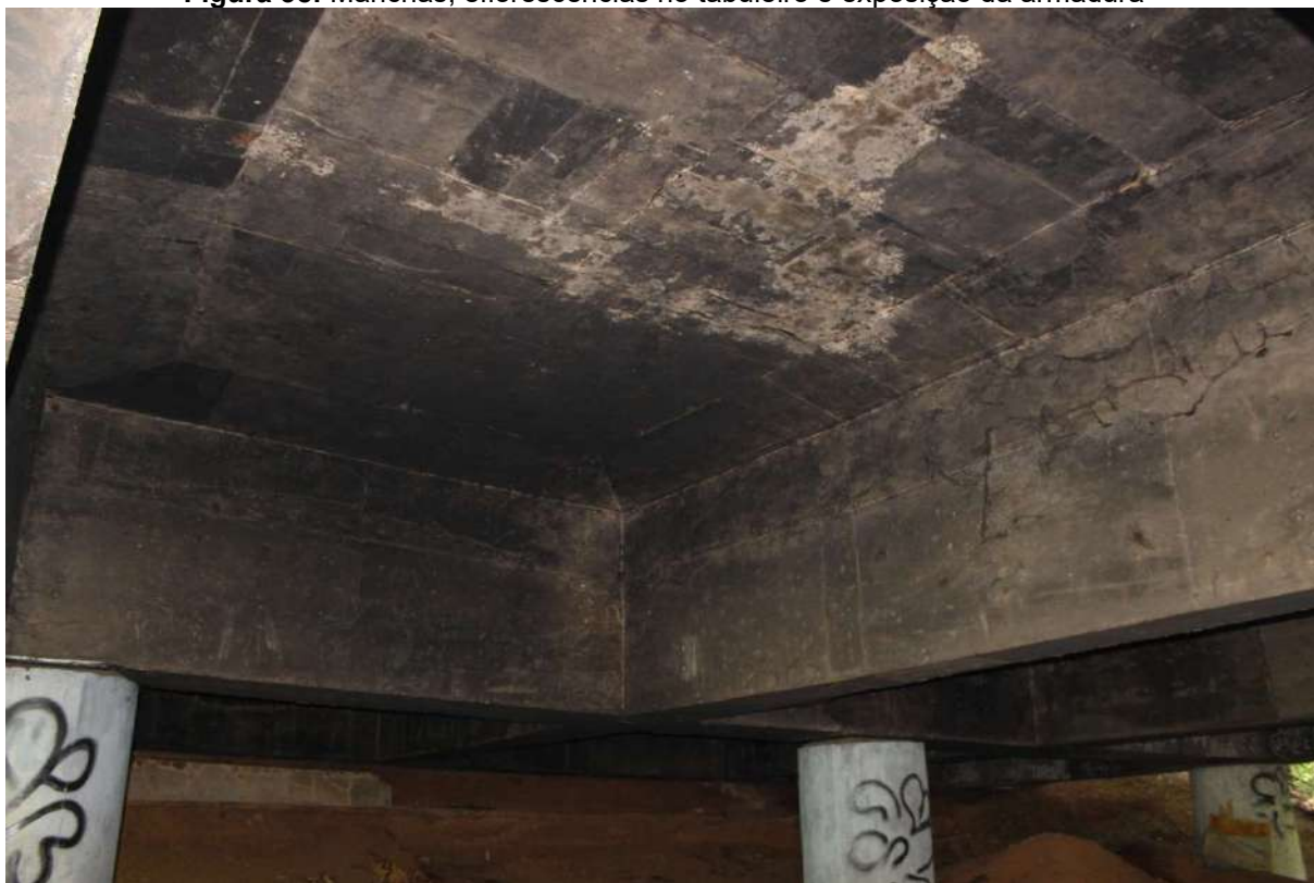
Figura 38: Manchas, eflorescências no tabuleiro e exposição da armadura
