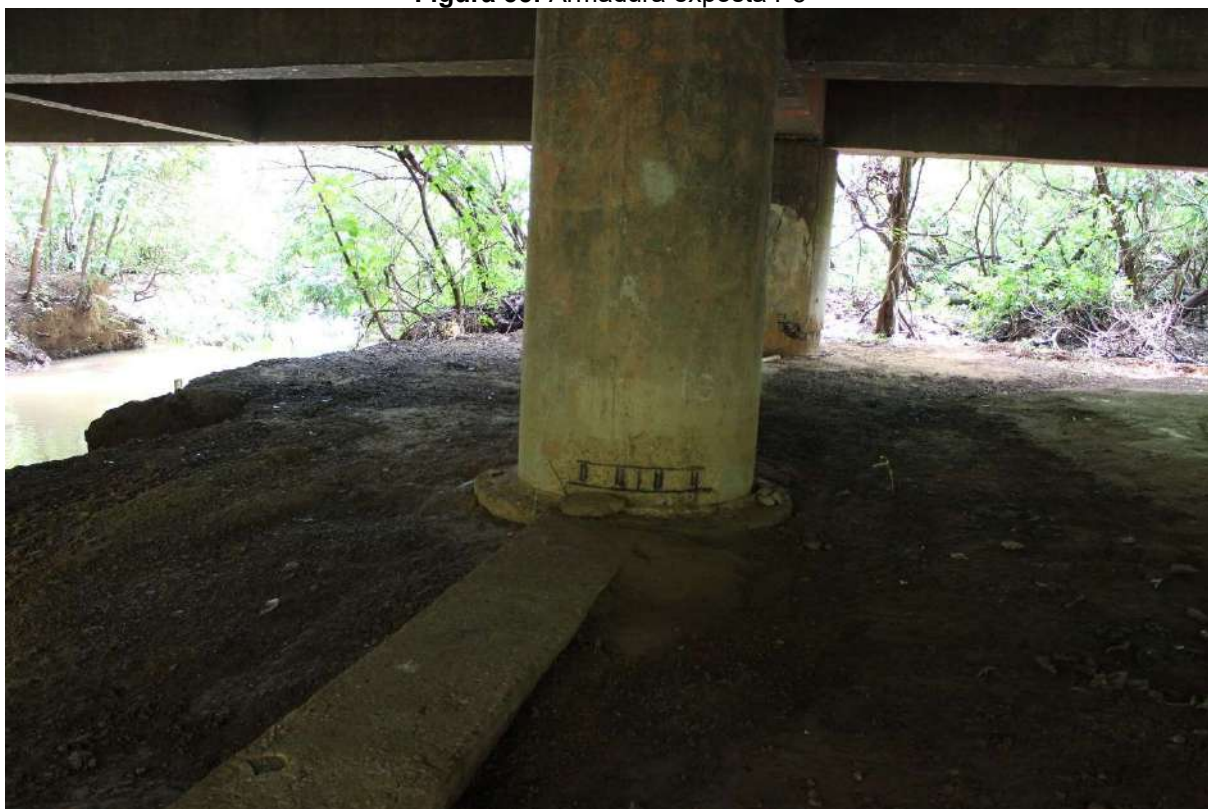
Figura 55: Armadura exposta P5
