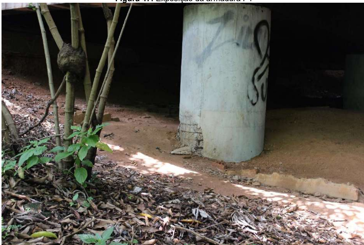
Figura 47: Exposição da armadura P1
