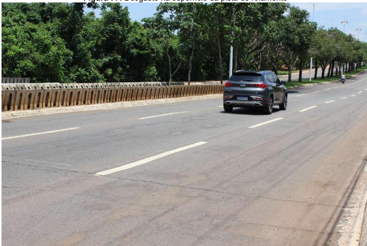
Figura 77: Desgaste na superfície da pista de rolamento
