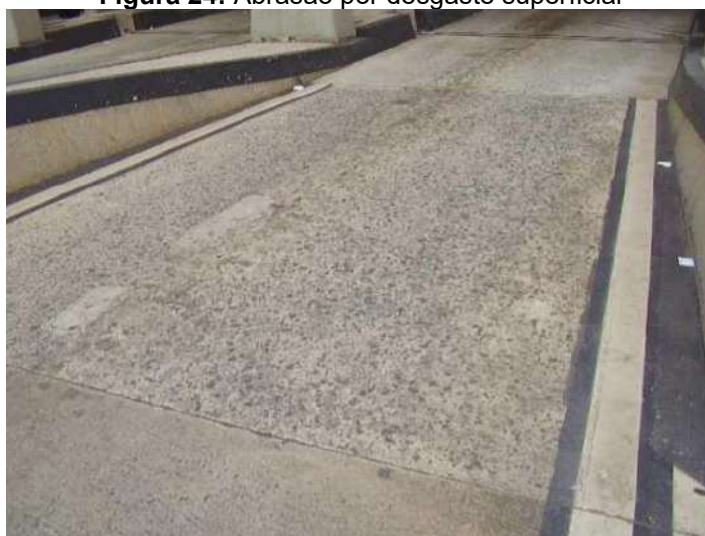
Figura 24: Abrasão por desgaste superficial
