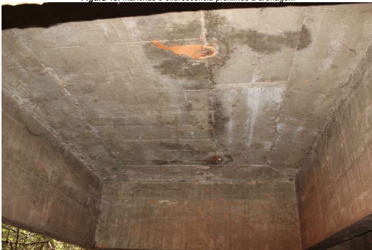
Figura 43: Manchas e eflorescência próximos a drenagem
