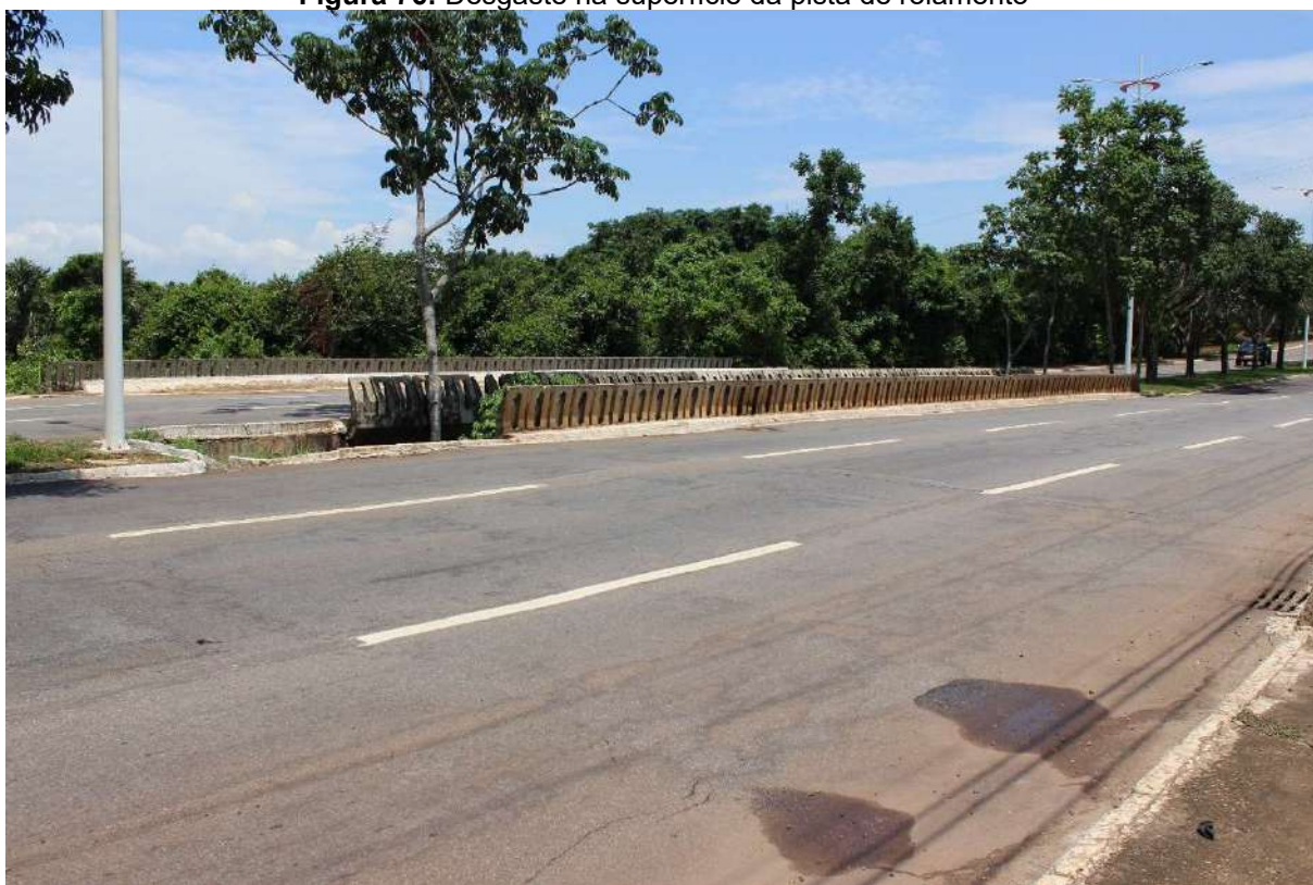
Figura 76: Desgaste na superfície da pista de rolamento
