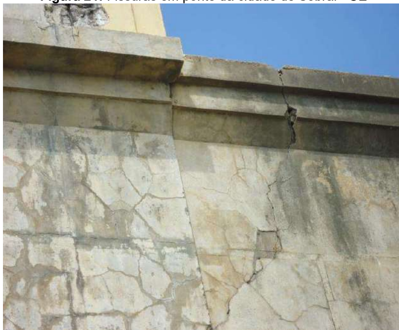
Figura 21: Fissuras em ponte da cidade de Sobral - CE
