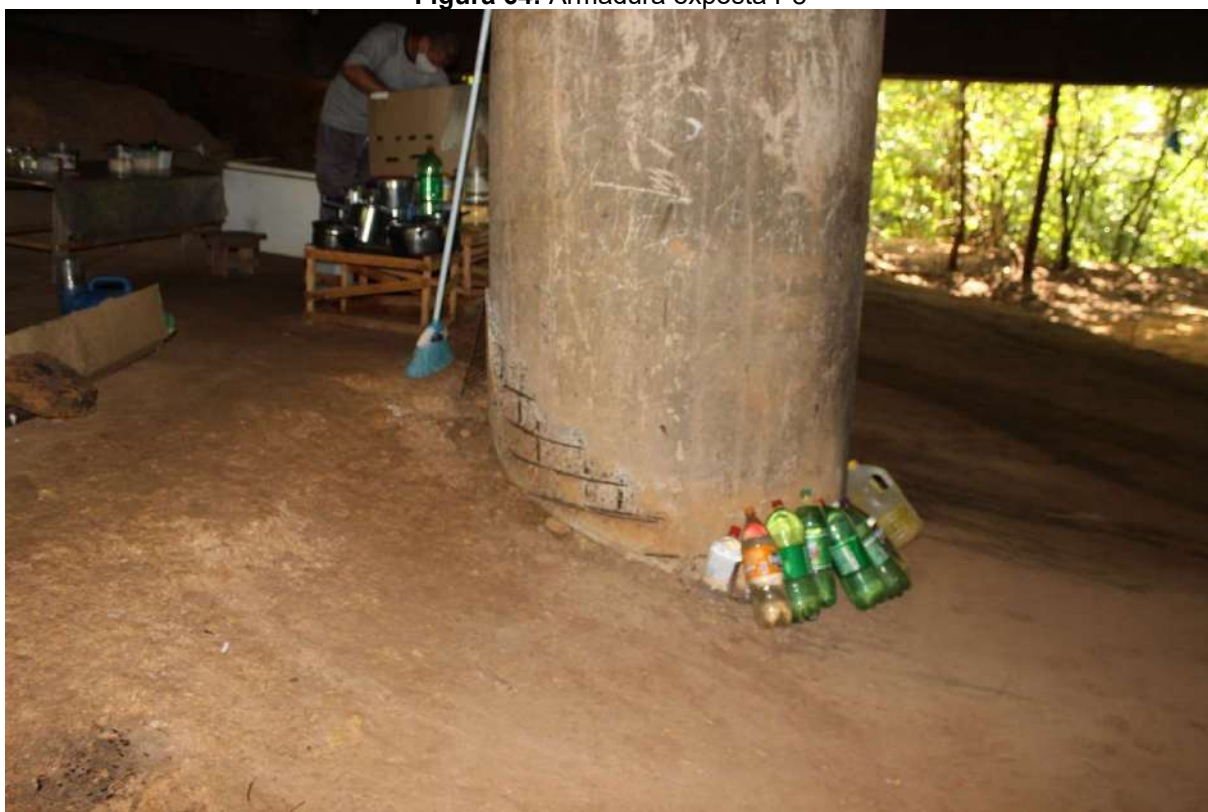
Figura 64: Armadura exposta P8
