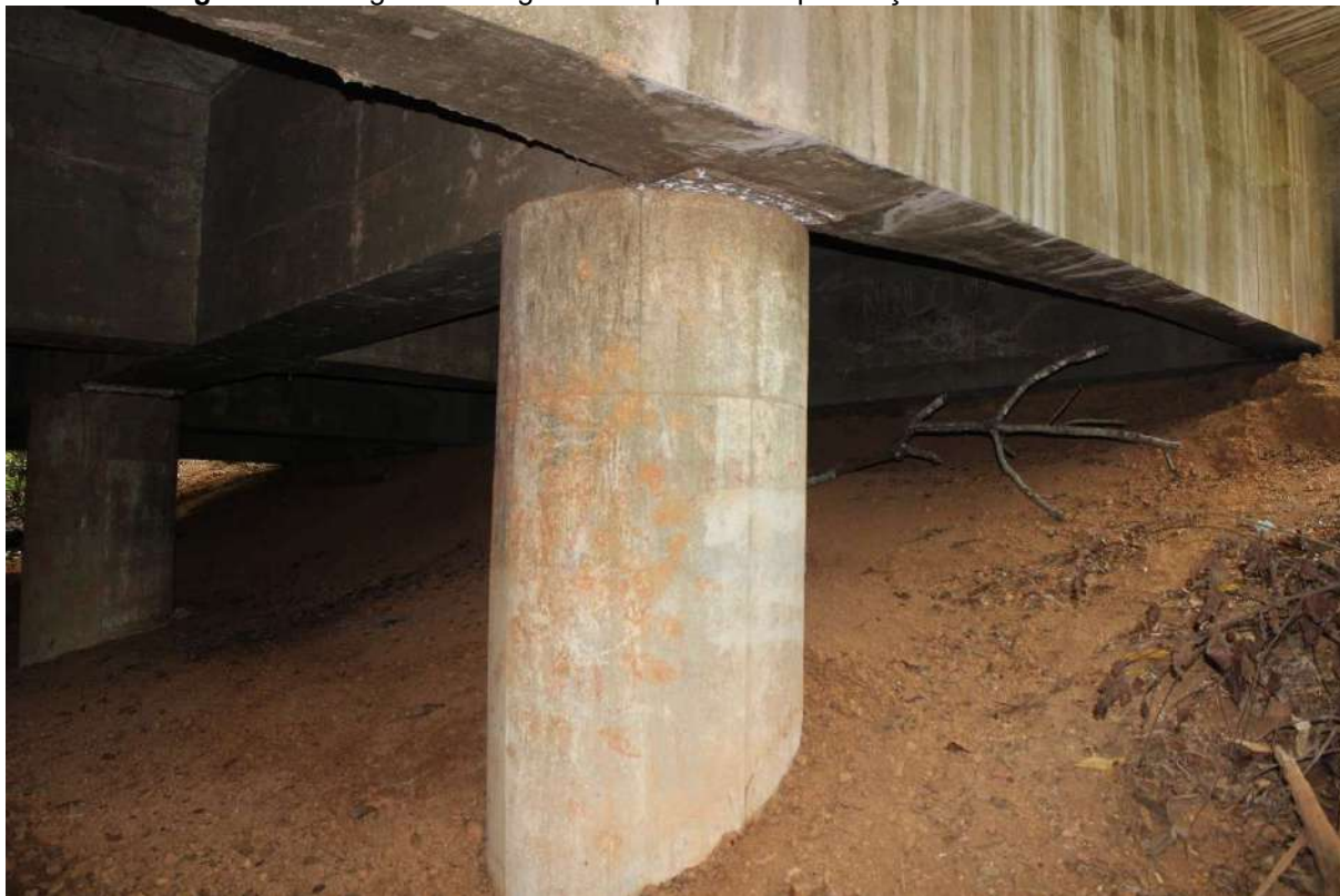
Figura 51: Desgaste na região dos apoios com presença de eflorescência P3
