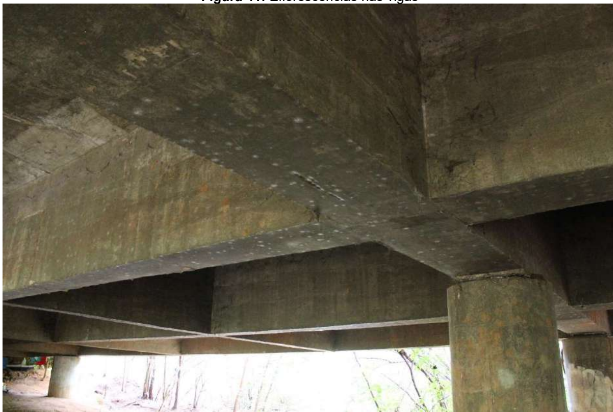
Figura 41: Eflorescências nas vigas
