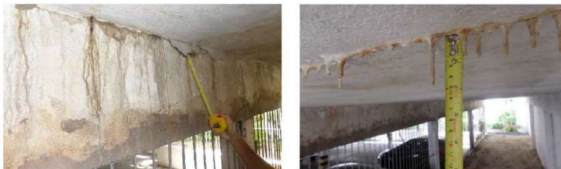
Figura 18: Lixiviação com presença de estalactites
