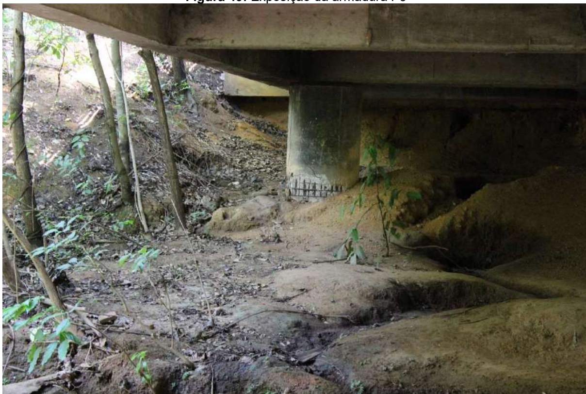
Figura 49: Exposição da armadura P9
