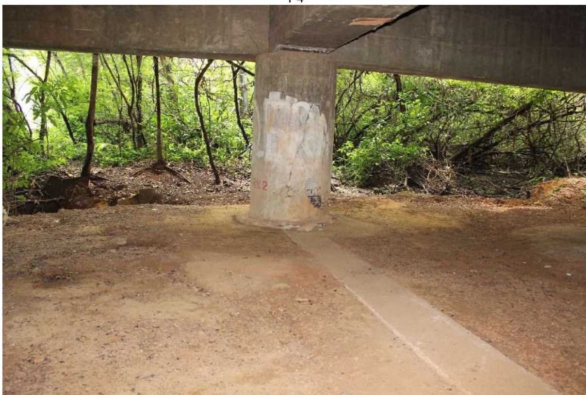
Figura 57: Exposição da armadura e desgaste na região dos apoios com presença de eflorescência P4
