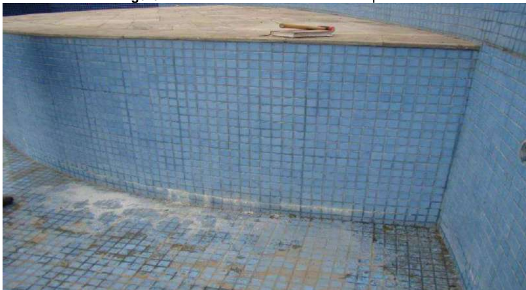
Figura 17: Eflorescência em estrutura de piscina
