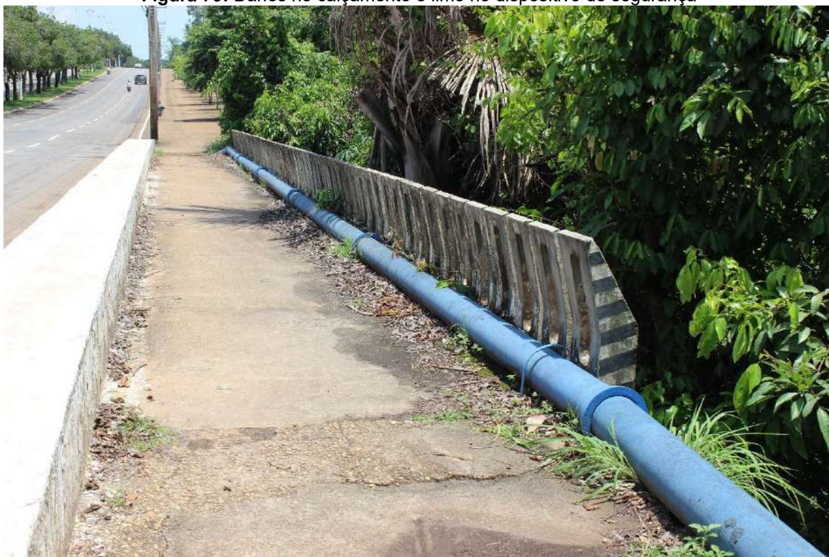
Figura 79: Danos no calçamento e limo no dispositivo de segurança
