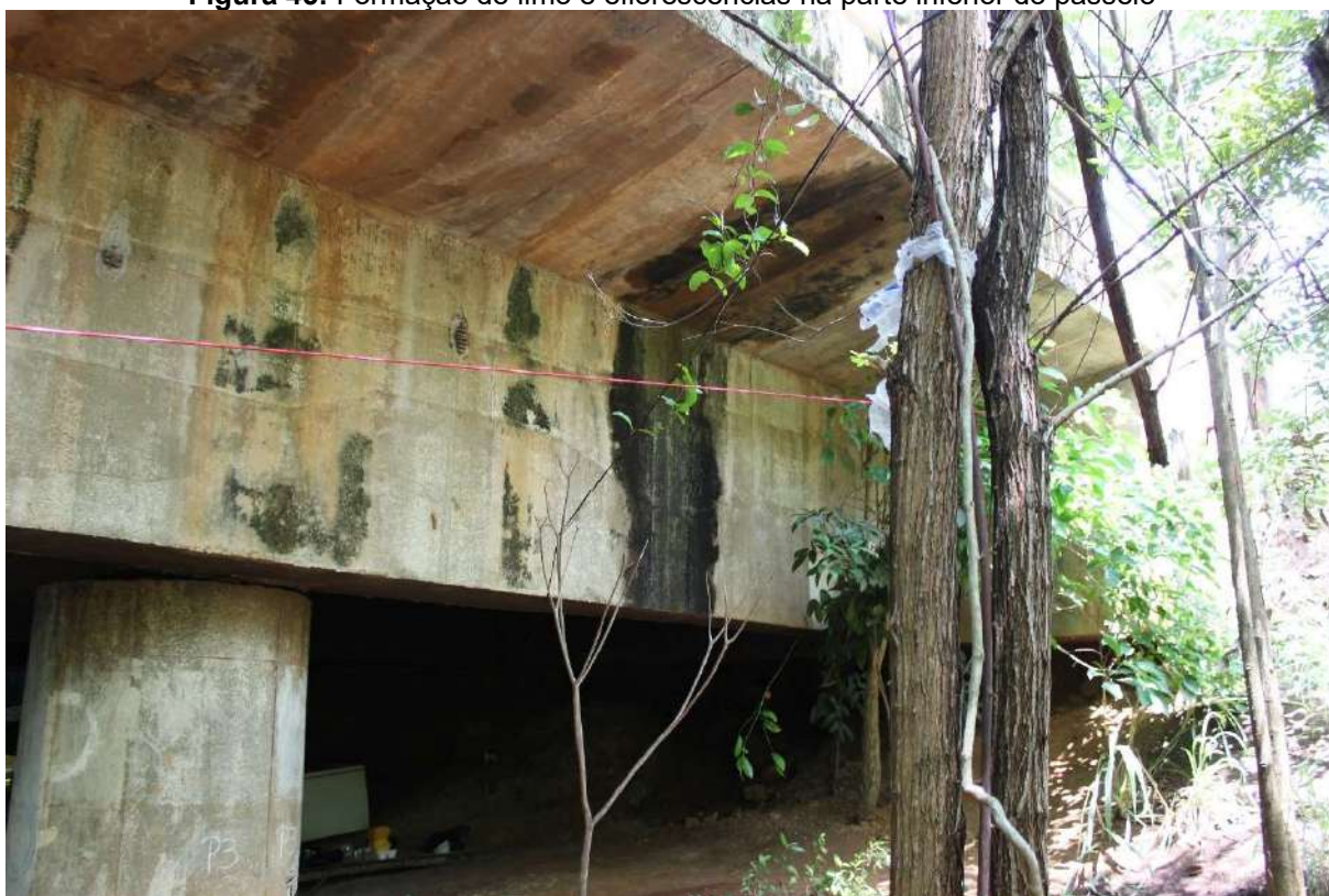
Figura 45: Formação de limo e eflorescências na parte inferior do passeio
