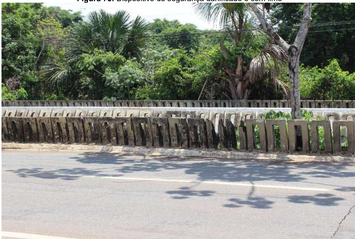
Figura 73: Dispositivo de segurança danificado e com limo
