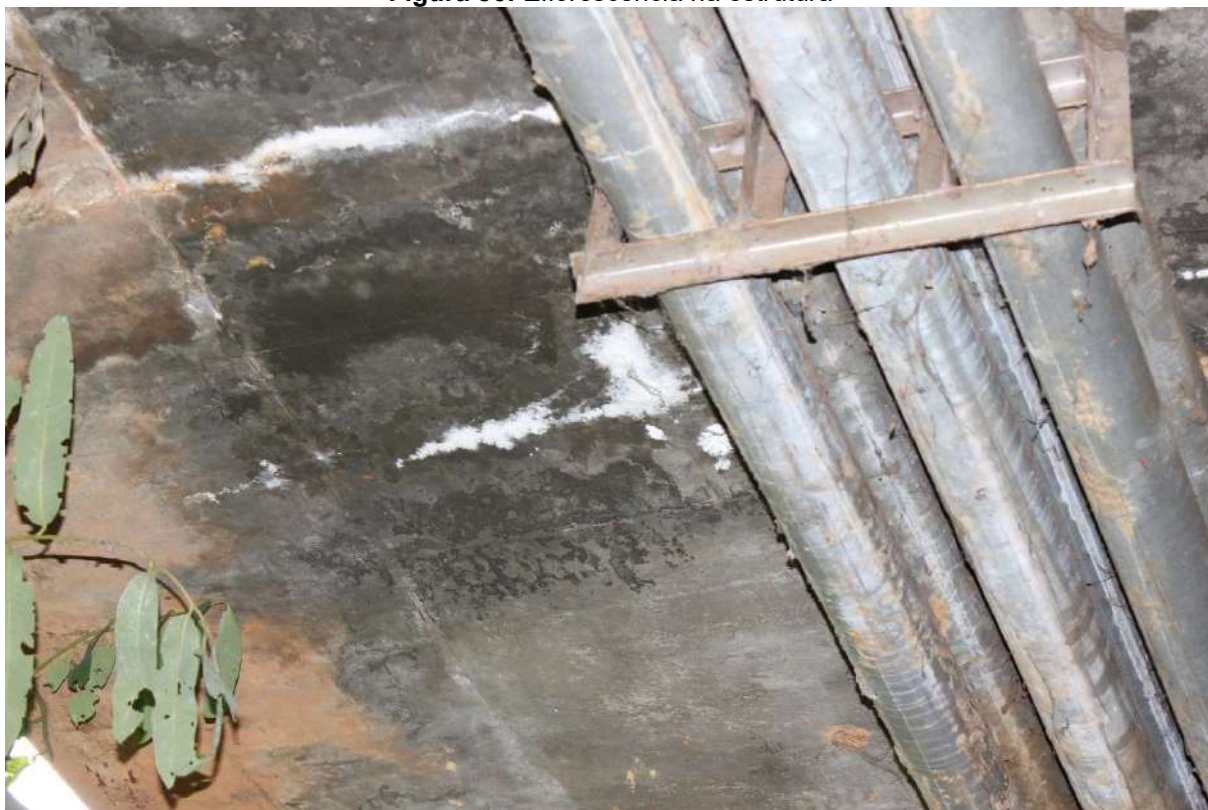
Figura 86: Eflorescência na estrutura
