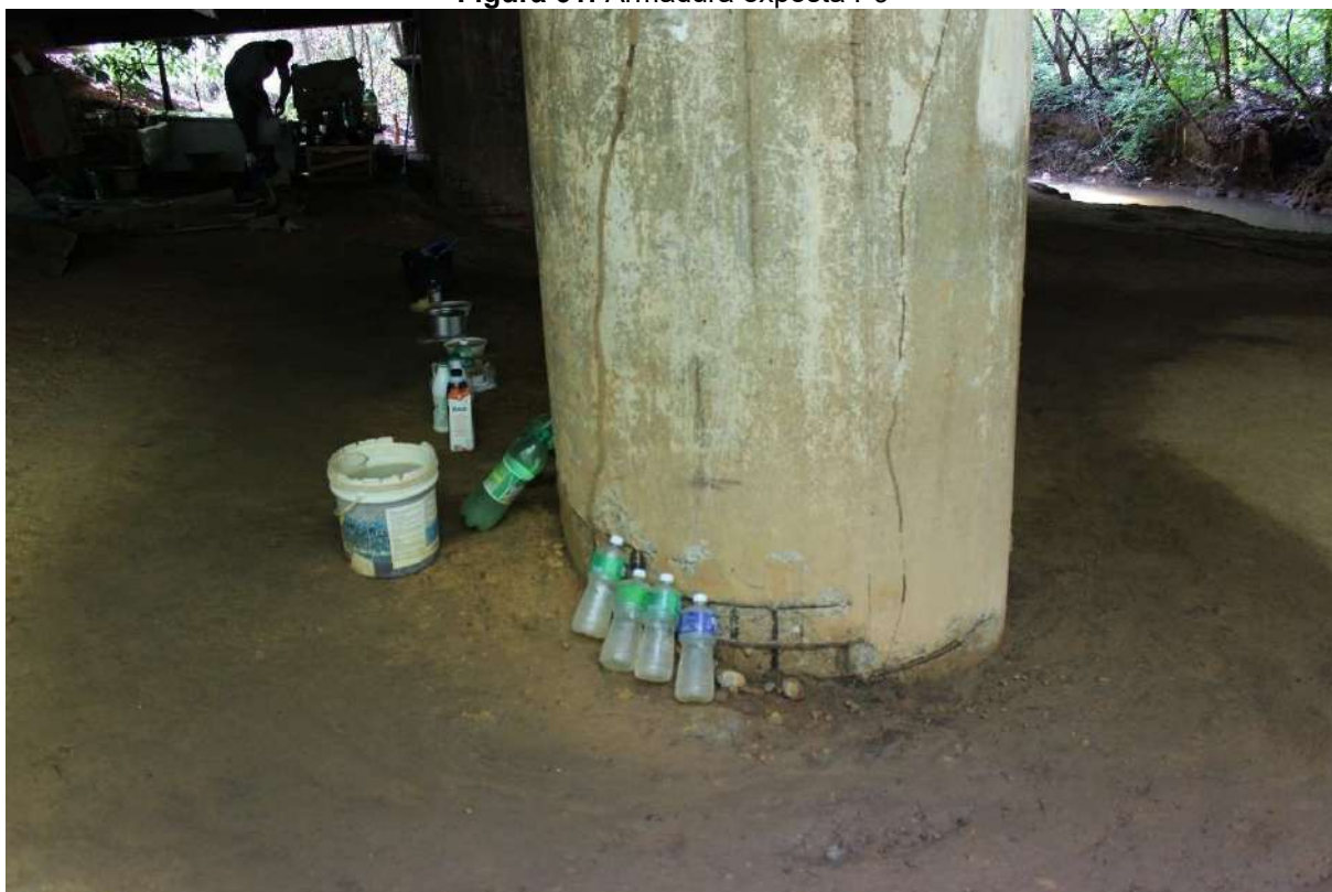
Figura 61: Armadura exposta P9
