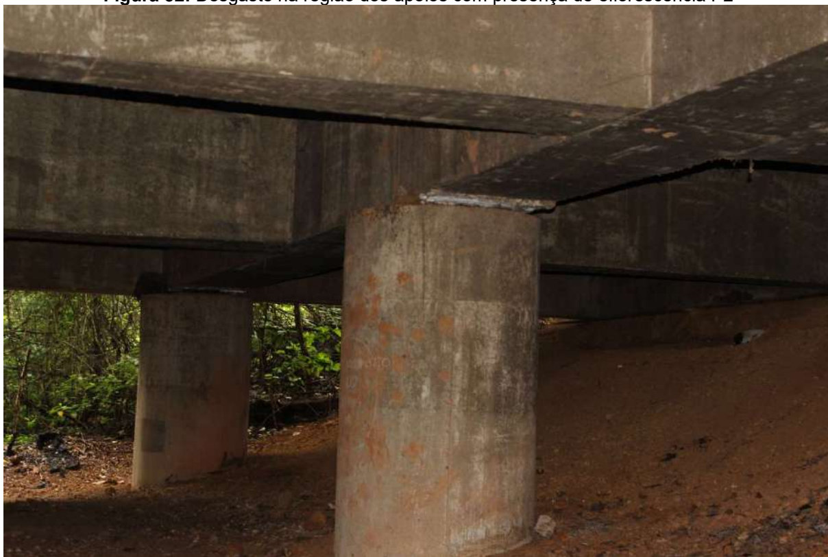
Figura 52: Desgaste na região dos apoios com presença de eflorescência P2
