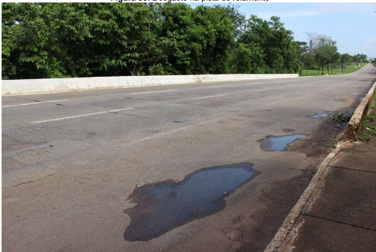
Figura 36: Desgaste na pista de rolamento
