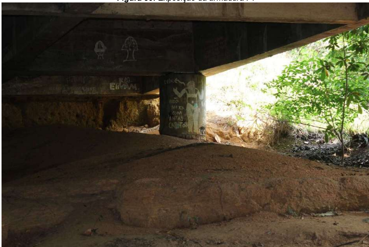
Figura 50: Exposição da armadura P7
