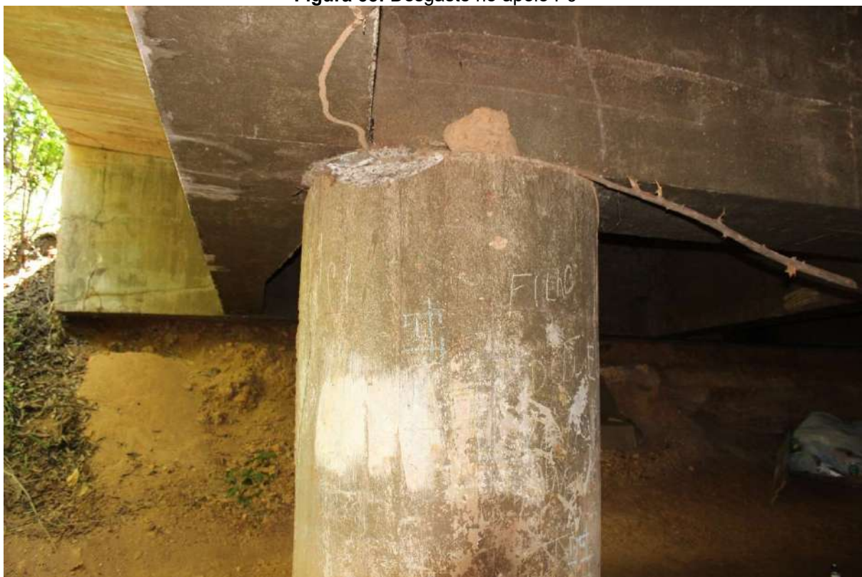
Figura 63: Desgaste no apoio P9
