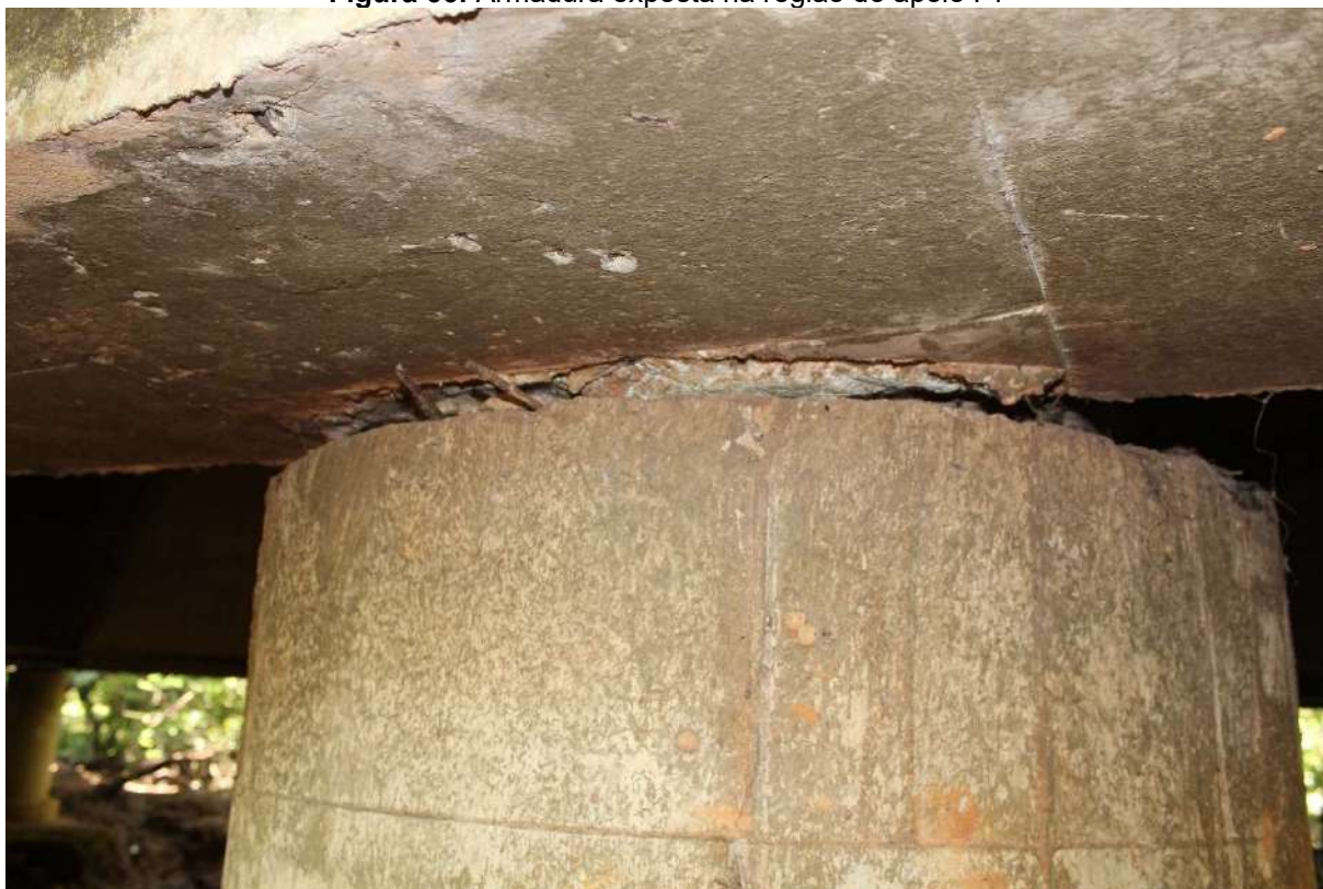
Figura 66: Armadura exposta na região do apoio P7
