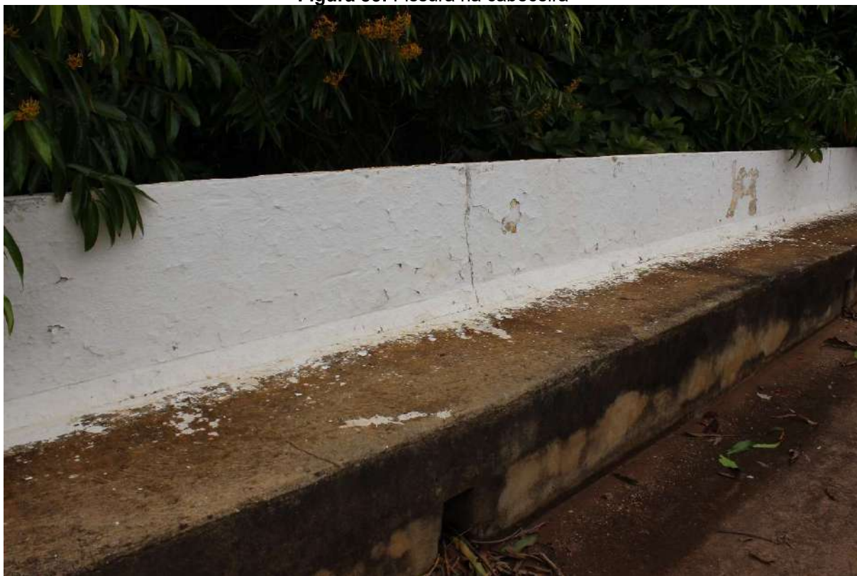
Figura 83: Fissura na cabeceira
