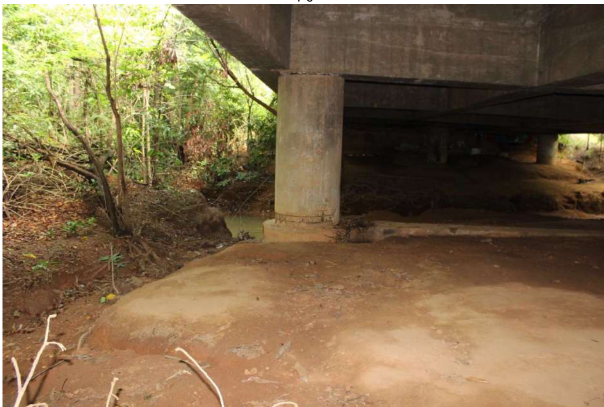
Figura 53: Exposição da armadura e desgaste na região dos apoios com presença de eflorescência P6
