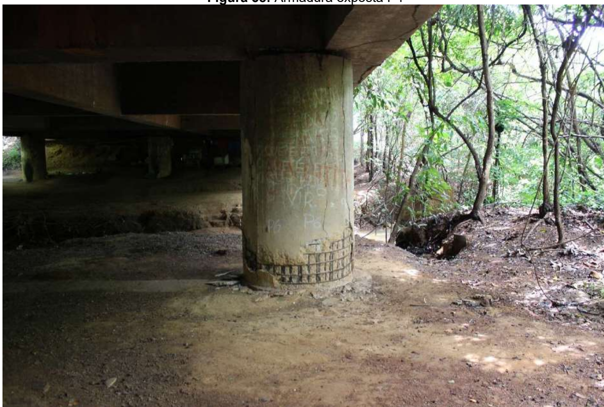
Figura 58: Armadura exposta P4
