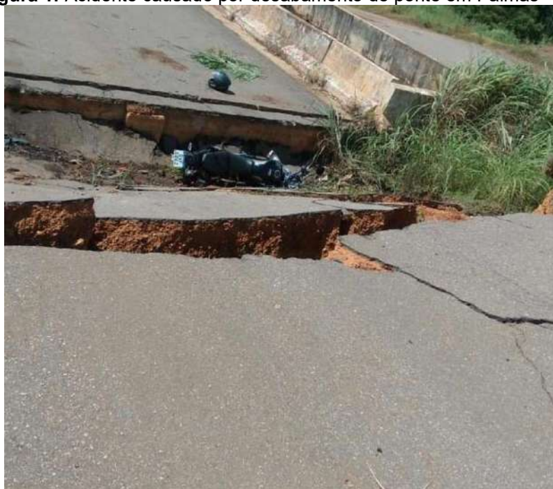
Figura 1: Acidente causado por desabamento de ponte em Palmas - TO
