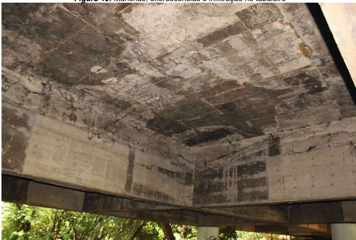
Figura 40: Manchas, eflorescências e infiltração no tabuleiro
