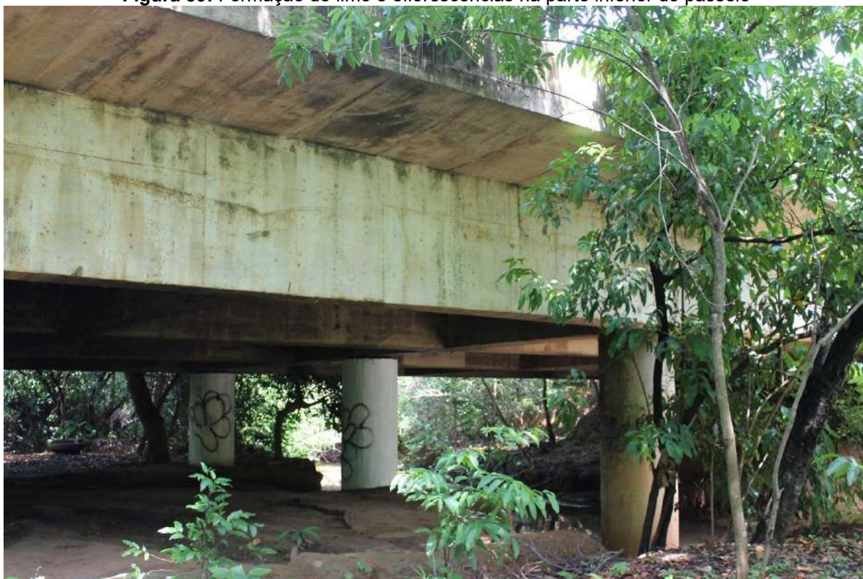
Figura 39: Formação de limo e eflorescências na parte inferior do passeio
