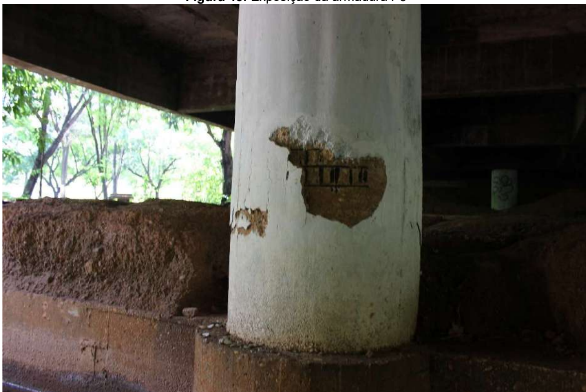
Figura 48: Exposição da armadura P5
