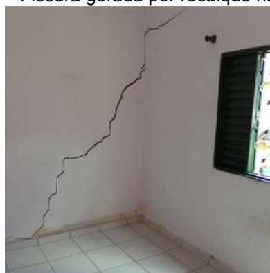
Figura 20 – Fissura gerada por recalque na fundação.
