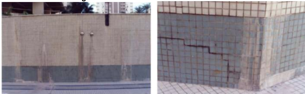
Figura 33 – Eflorescência no revestimento
