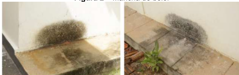
Figura 2 – Mancha de bolor
