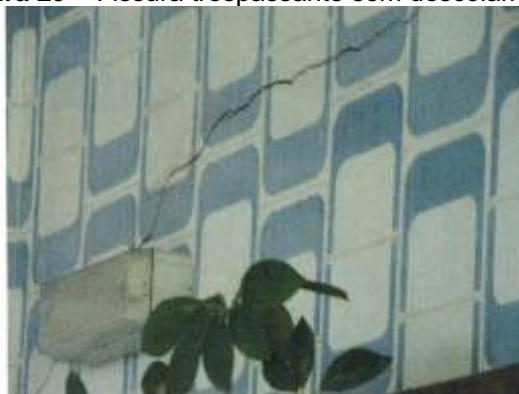
Figura 29 – Fissura trespessante sem descolamento
