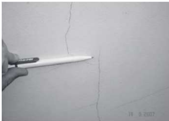
Figura 7 – Microfissura em revestimento de argamassa
