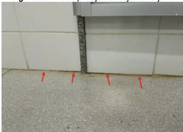
Figura 35 – Não aplicação de rejunte na junta
