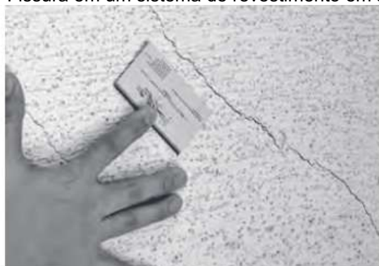
Figura 8 – Fissura em um sistema de revestimento em argamassa
