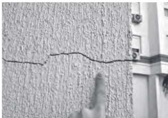
Figura 9 – Fissura ou trinca em um sistema de vedação vertical
