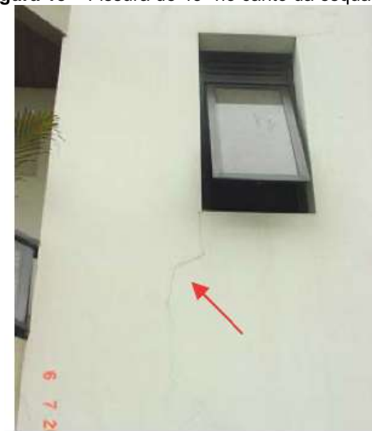
Figura 18 – Fissura de 45° no canto da esquadria
