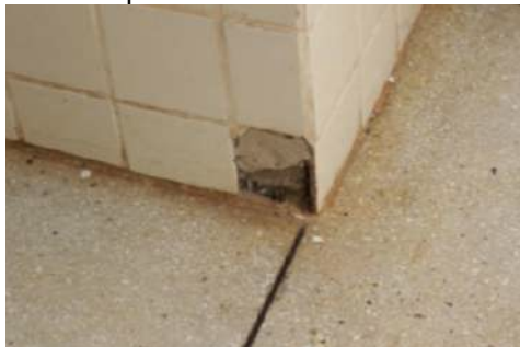
Figura 30 – Desplacamento do revestimento cerâmico
