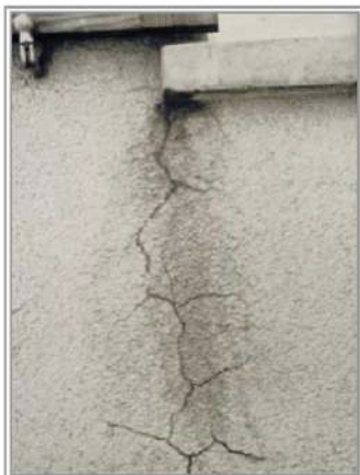
Figura 13 – Fissura gerada por movimentação higroscópica.
