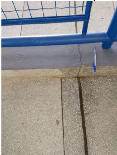
Figura 34 – Falta de continuidade na junta de dilatação
