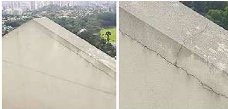
Figura 11 – Fissura causada por movimentação térmica.
