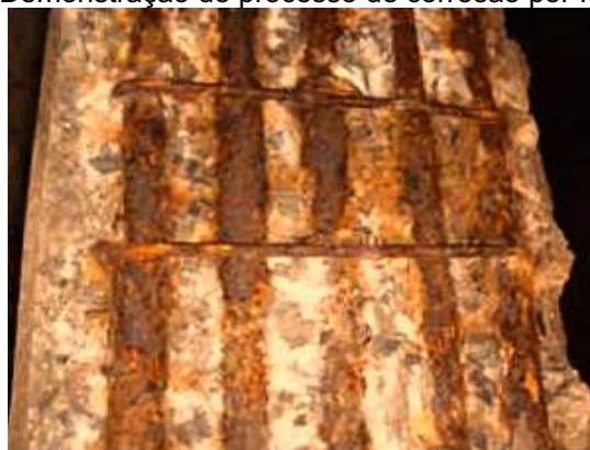
Figura 23 – Demonstração do processo de corrosão por íons de cloreto
