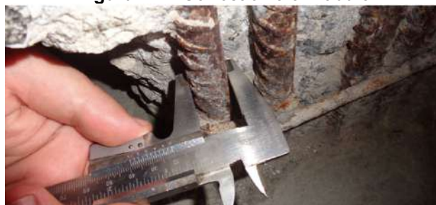
Figura 24 – Corrosão na armadura
