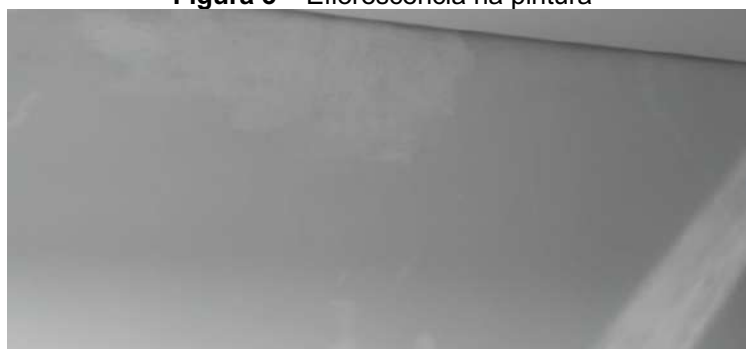
Figura 3 – Eflorescência na pintura
