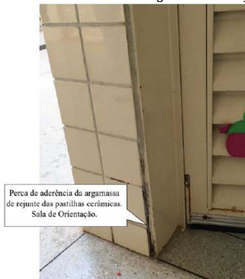
Figura 32 – Possível falha na argamassa de rejunte
