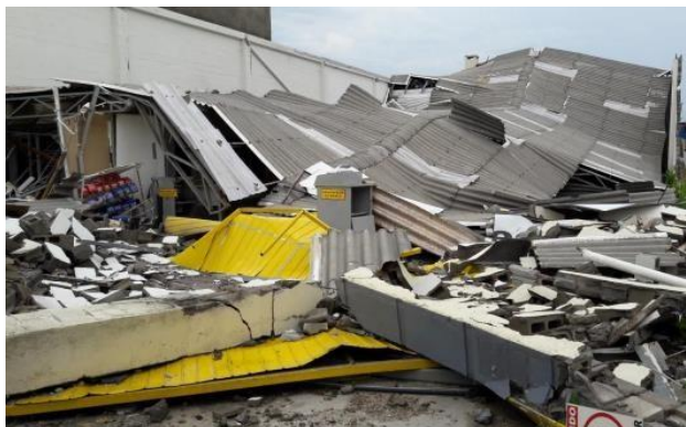
Figura 4 - Galpão 02 colapsado pelo vento
