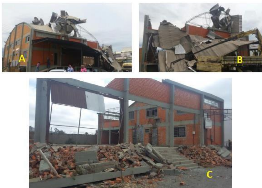
Figura 3 - Galpão 01 colapsado pelo vento
