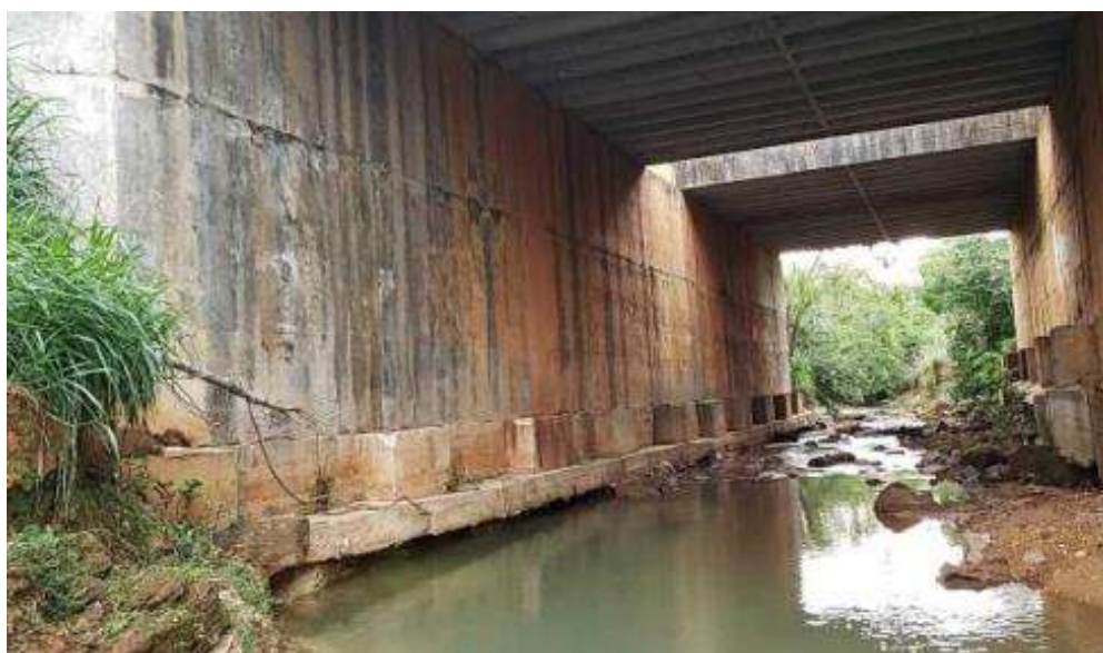
Figura 42 – Descalçamento da fundação da cabeceira sul
