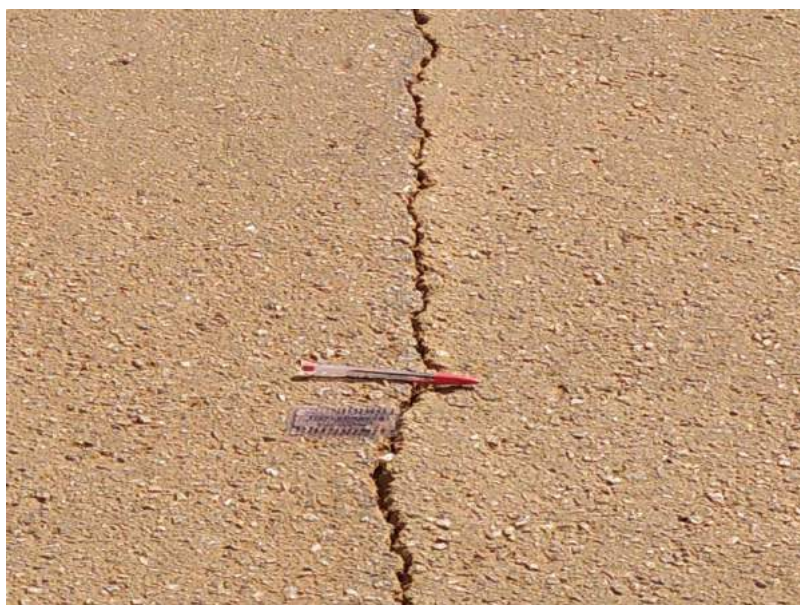
Figura 64 – Ensaio de fissurometria na pista de rolamento, cabeceira norte, sentido sul-norte, abertura superior a 3 mm
