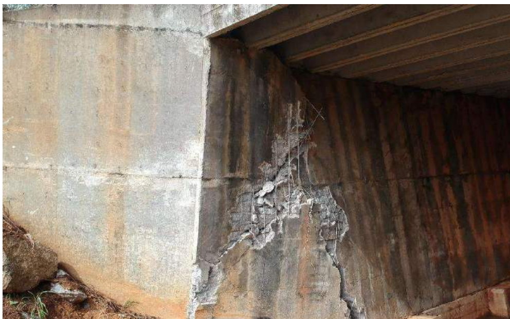
Figura 38 – Armaduras de contenção expostas
