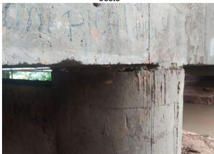
Figura 80 – Desgaste na região entre material de apoio e pilar direito, sentido leste-oeste
