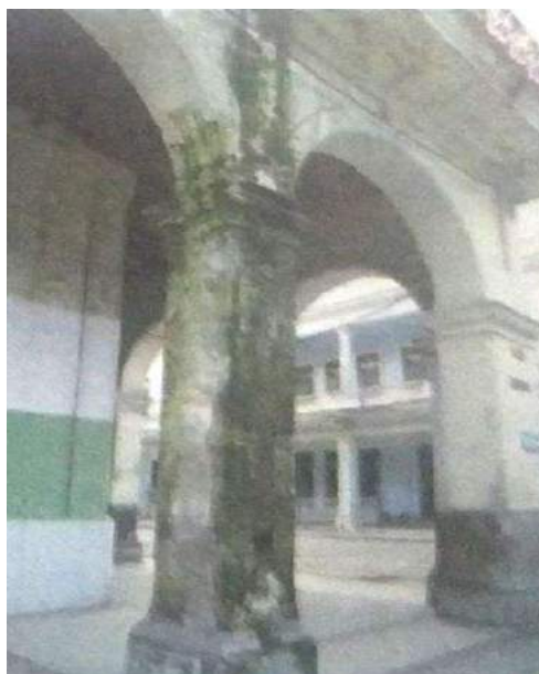
Figura 15 – Presença de limo em pilar
