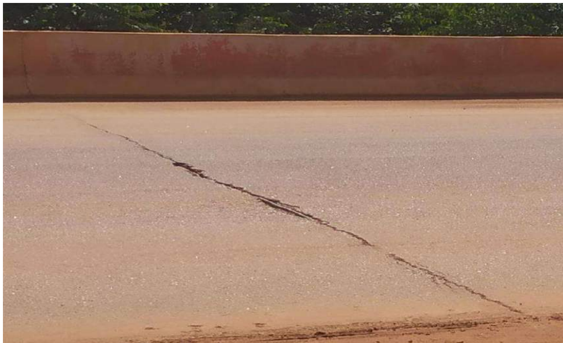
Figura 50 – Esborcinamento (sentido sul-norte)
