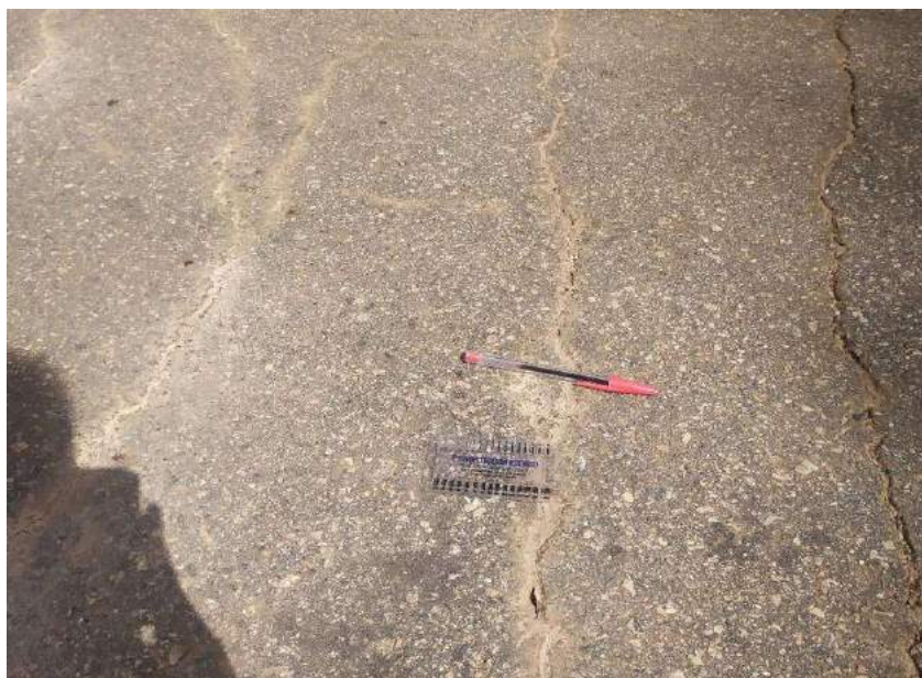
Figura 83 – Fenda superior a 3,0 mm em degrau na cabeceira oeste, sentido leste-oeste
