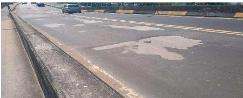
Figura 20 – Desgaste superficial em pista de rolamento
