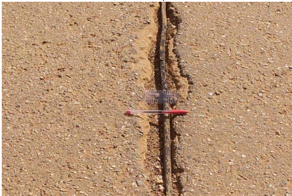
Figura 63 – Ensaio de fissurometria na junta de dilatação da pista de rolamento, sentido sul-norte, abertura superior a 3 mm
