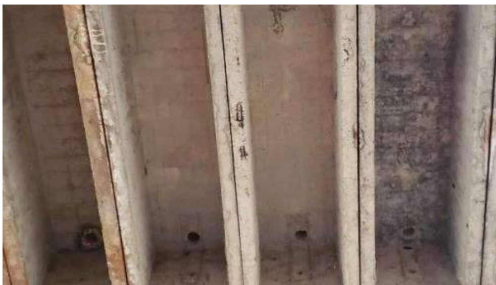
Figura 37 – Eflorescência na região das nervuras
