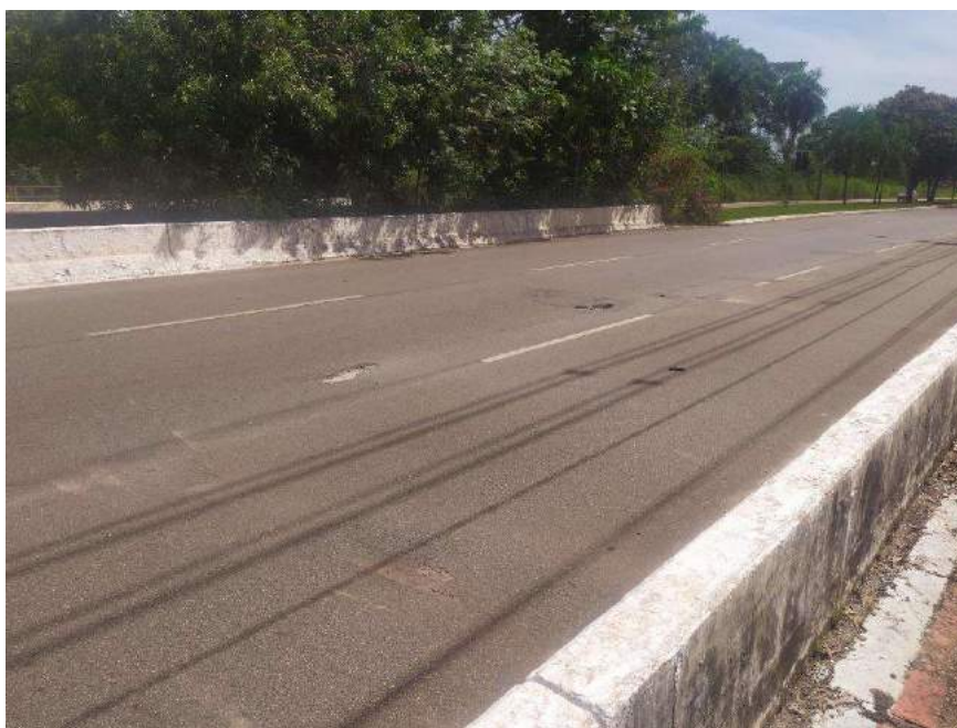
Figura 72 – Desgaste superficial na pista de rolamento, sentido leste-oeste
