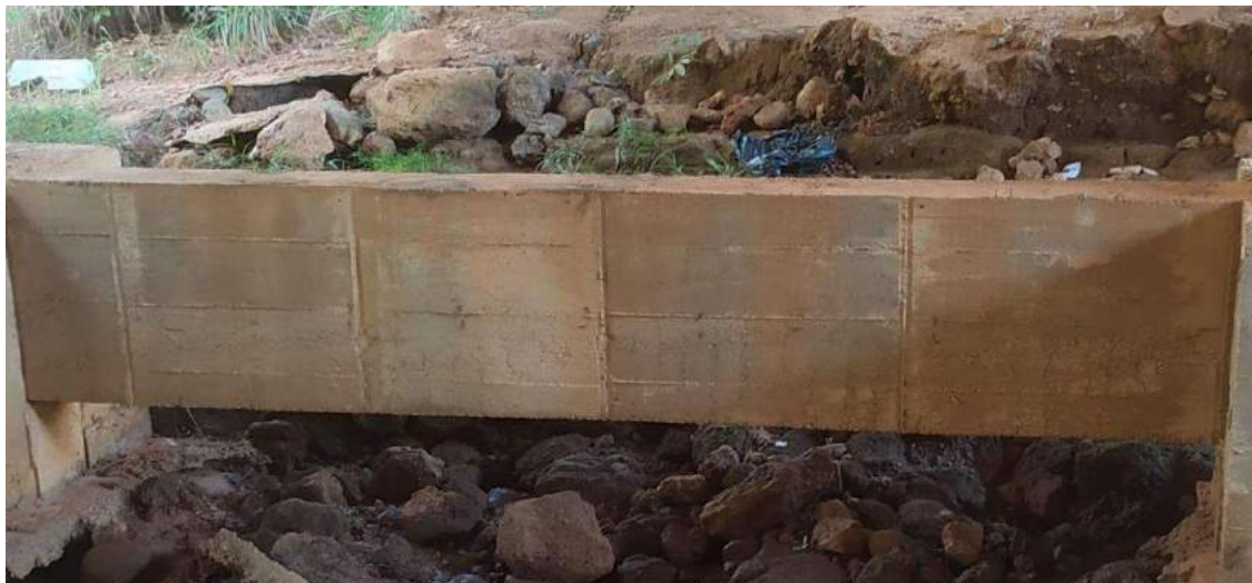
Figura 60 – Fissuras na viga de travamento, sentido sul-norte
