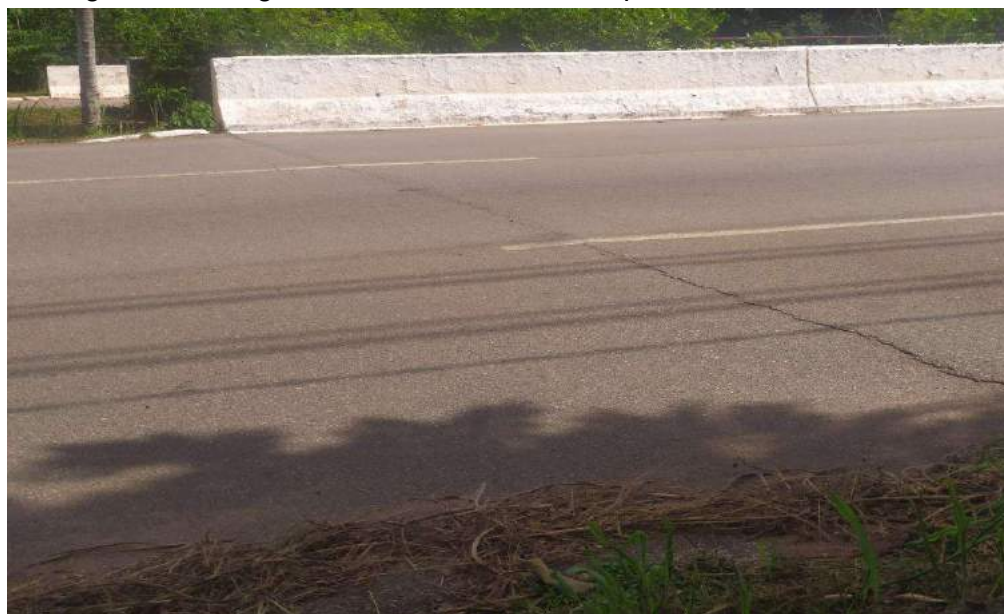
Figura 74 – Degrau na cabeceira oeste da ponte, sentido oeste-leste
