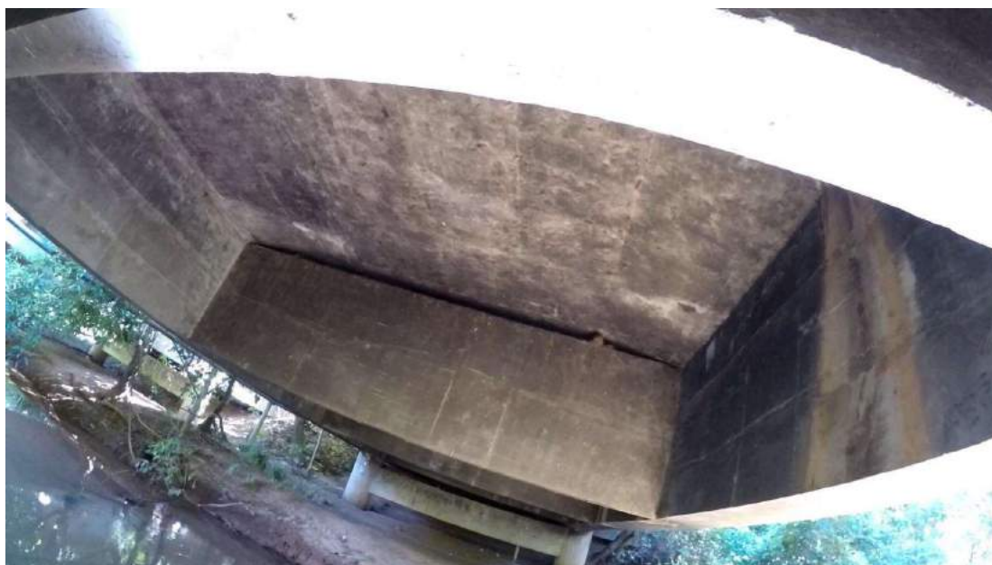
Figura 76 – Eflorescência na região inferior do tabuleiro, sentido leste-oeste
