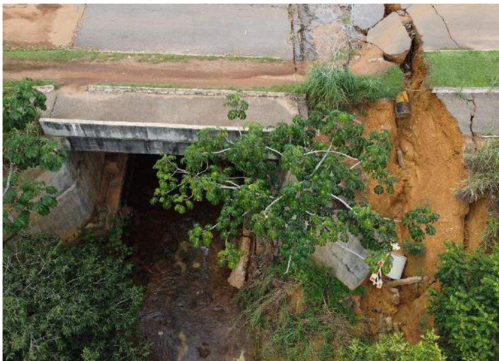
Figura 34 – Deslocamento do material do aterro
