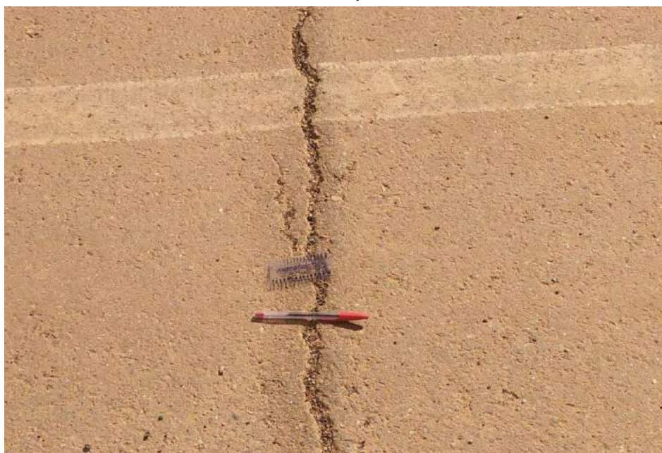
Figura 62 – Ensaio de fissurometria na pista de rolamento, cabeceira sul, sentido sul-norte, abertura superior a 3 mm
