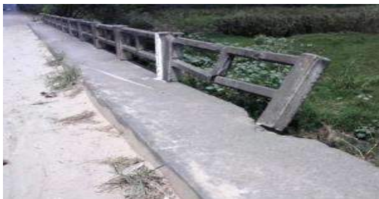
Figura 21 – Deterioração o guarda-corpos causada por choque
