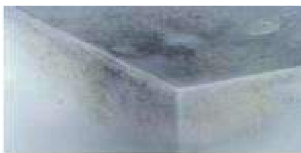
Figura 14 – Bolor em revestimento
