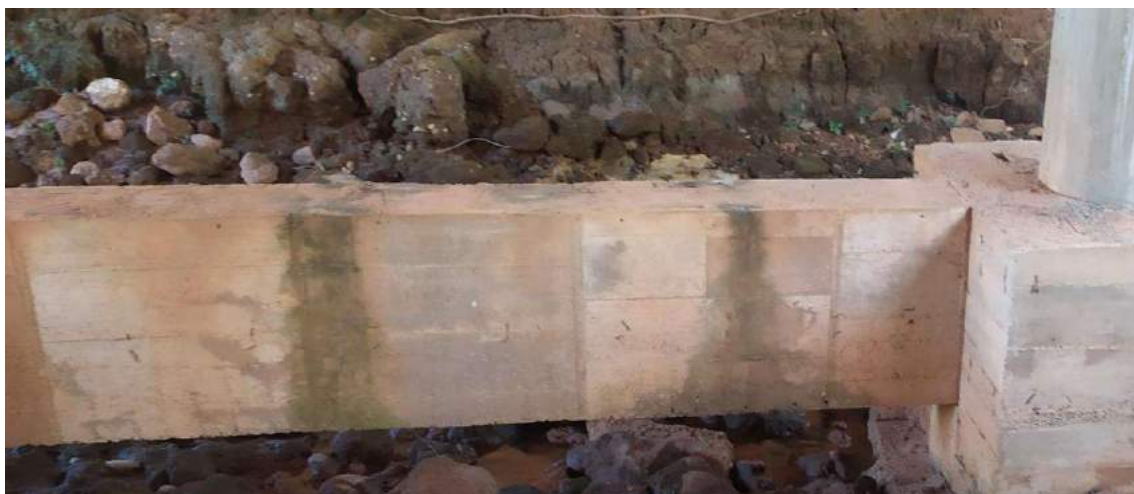
Figura 61 – Fissuras e limo na viga de travamento, sentido sul-norte
