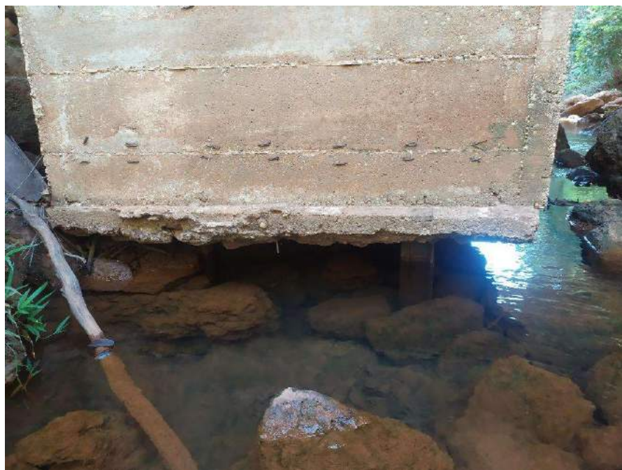
Figura 59 – Descalçamento do bloco de coroamento do pilar direito, sentido sul-norte
