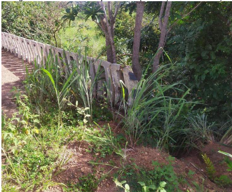
Figura 46 – Ausência de calçamento em passeio (sentido norte-sul)
