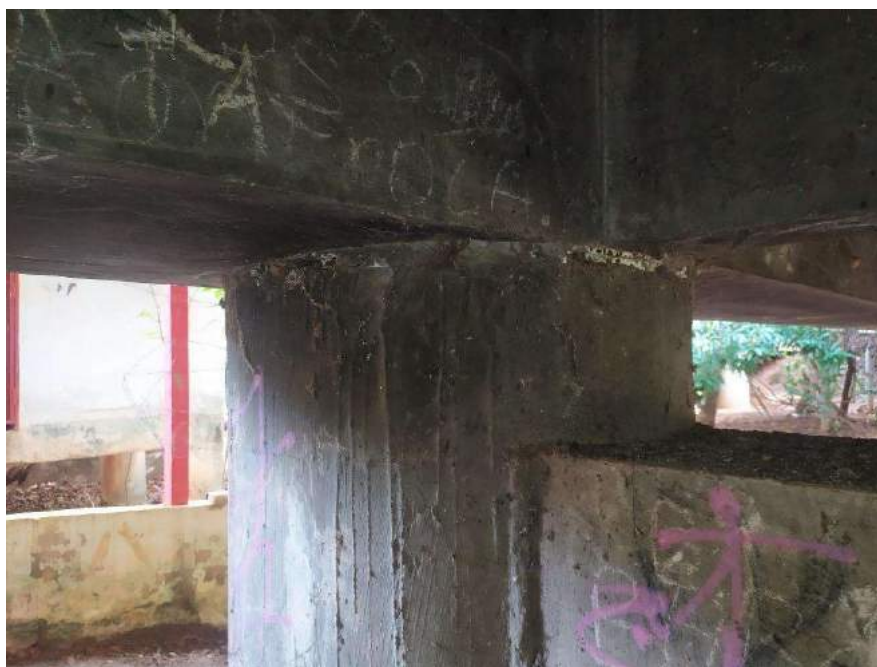
Figura 81 – Desgaste na região entre material de apoio e pilar esquerdo, sentido oeste-leste
