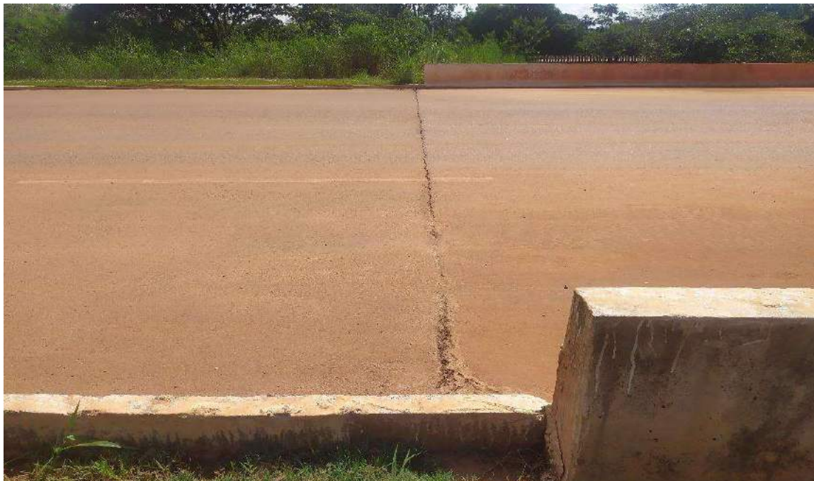
Figura 48 – Degrau no tabuleiro (sentido sul-norte)
