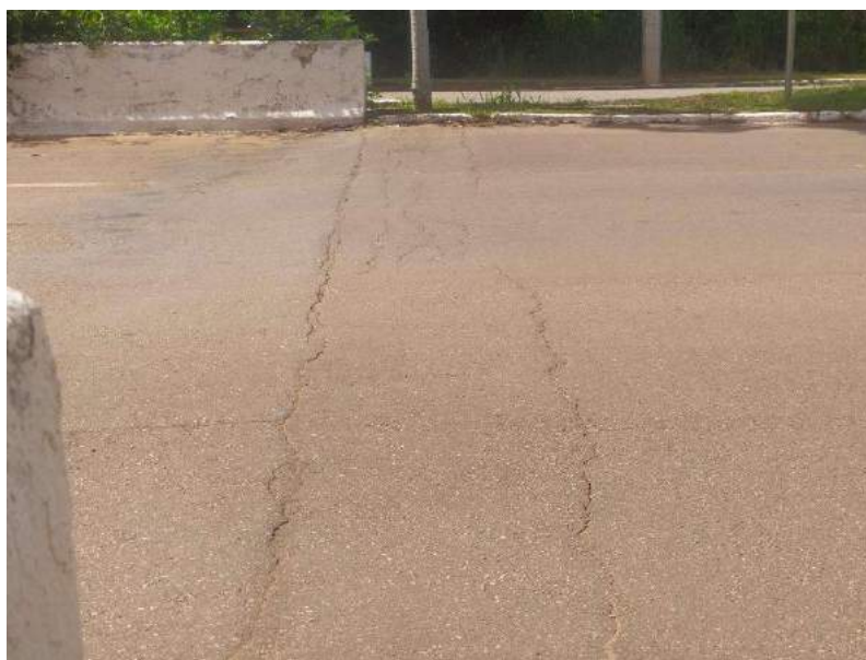
Figura 73 – Degrau na cabeceira leste da ponte, sentido oeste-leste
