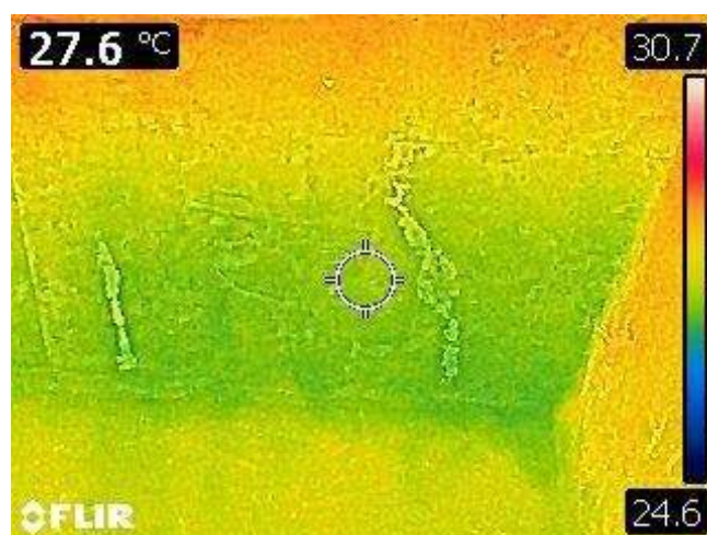
Figura 87 – Temperatura de 27.6°C em superfície inferior do tabuleiro, região central, sentido leste-oeste
