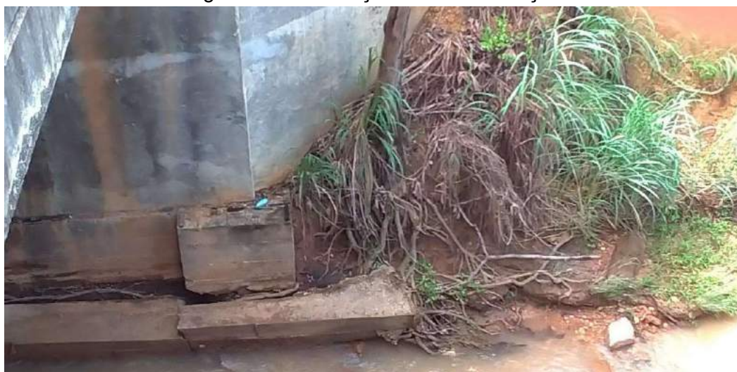
Figura 41 – Descalçamento da fundação
