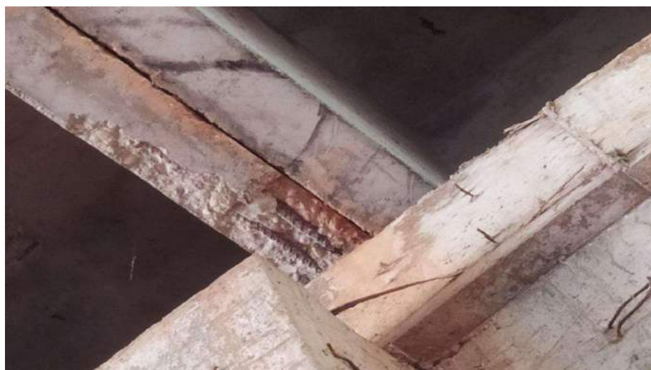
Figura 51 – Armadura exposta na superfície inferior do tabuleiro, sentido sul-norte
