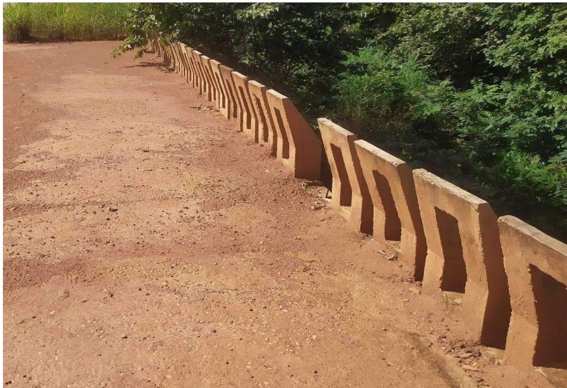
Figura 47 – Guarda-corpo danificado (sentido sul-norte)
