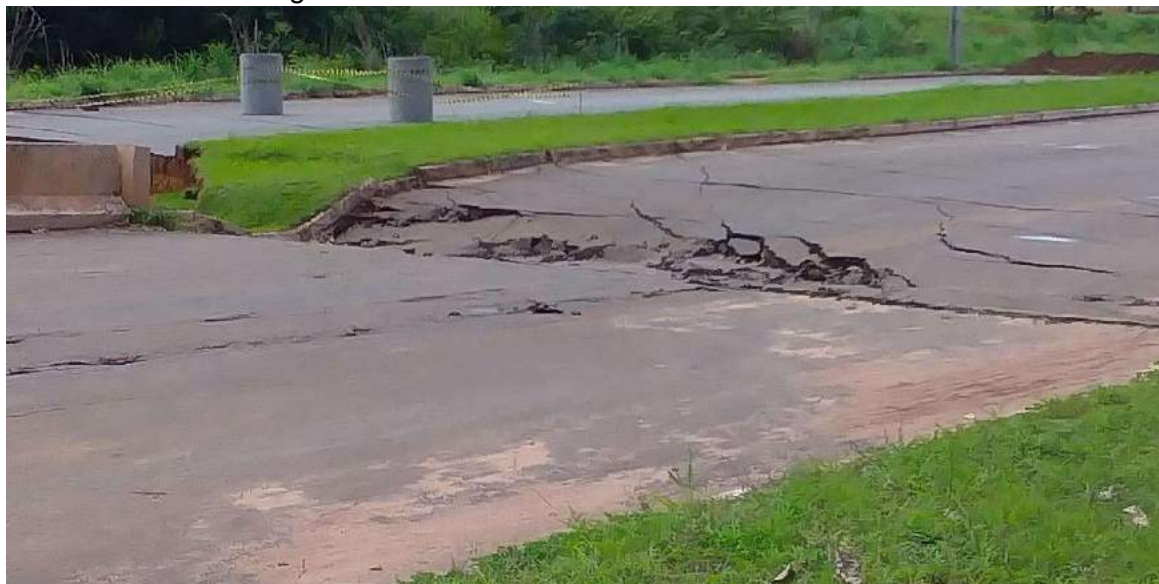
Figura 32 – Desmoronamento da cabeceira norte
