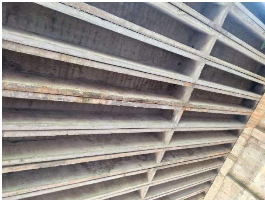
Figura 52 – Formação de limo na superfície inferior do tabuleiro, sentido sul-norte
