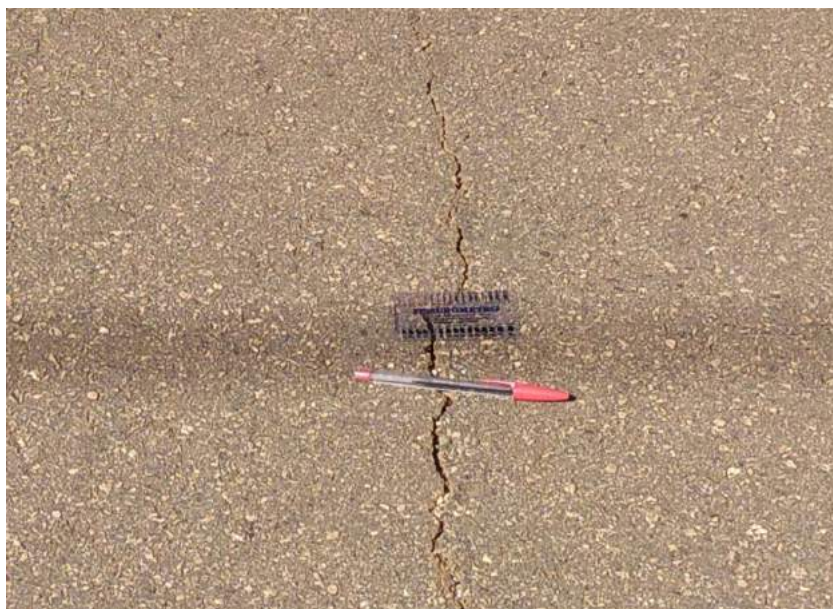
Figura 65 – Ensaio de fissurometria na pista de rolamento, cabeceira norte, sentido norte-sul, abertura de 1,6 mm
