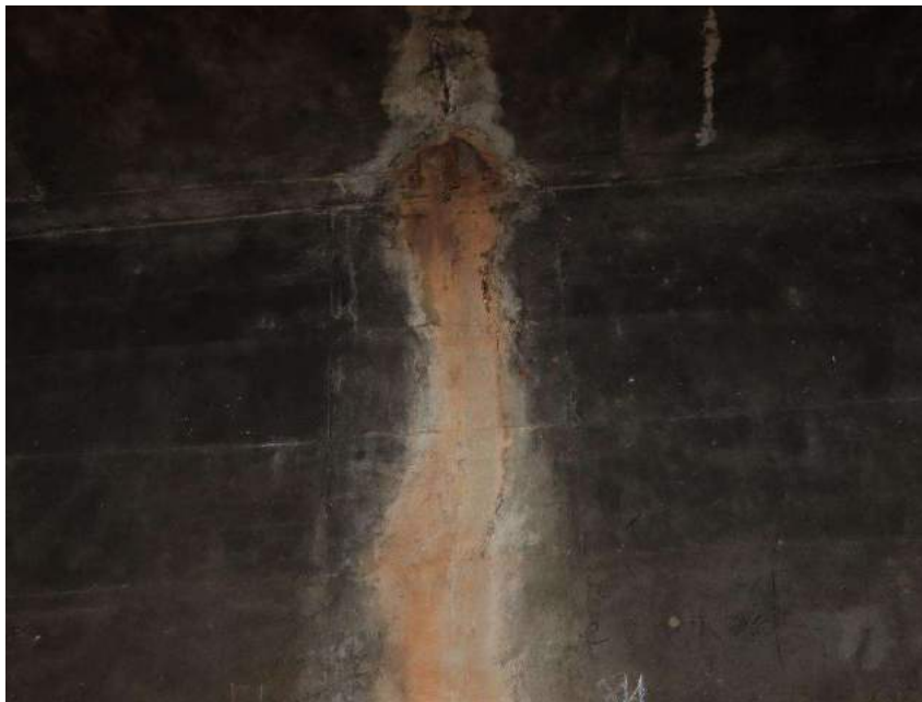
Figura 77 – Eflorescência perto do sistema de drenagem, sentido leste-oeste
