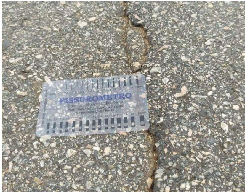
Figura 82 – Fenda de 3,0 mm em degrau na cabeceira leste, sentido leste-oeste
