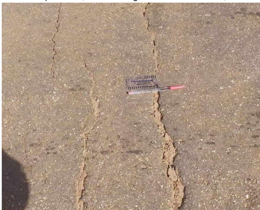
Figura 85 – Fenda superior a 3,0 mm em degrau na cabeceira leste, sentido oeste-leste
