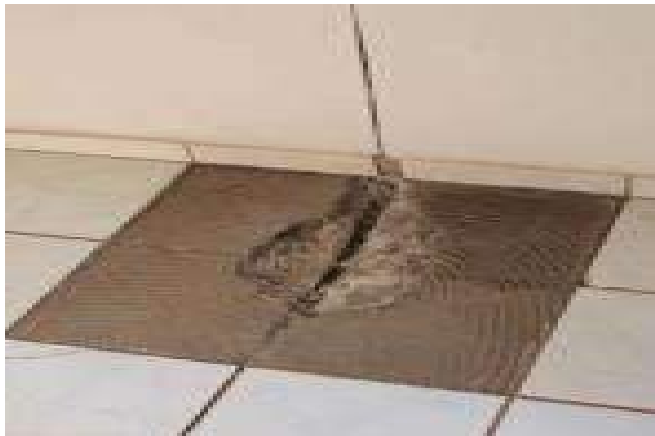
Figura 19 – Fissura por negligência de junta
