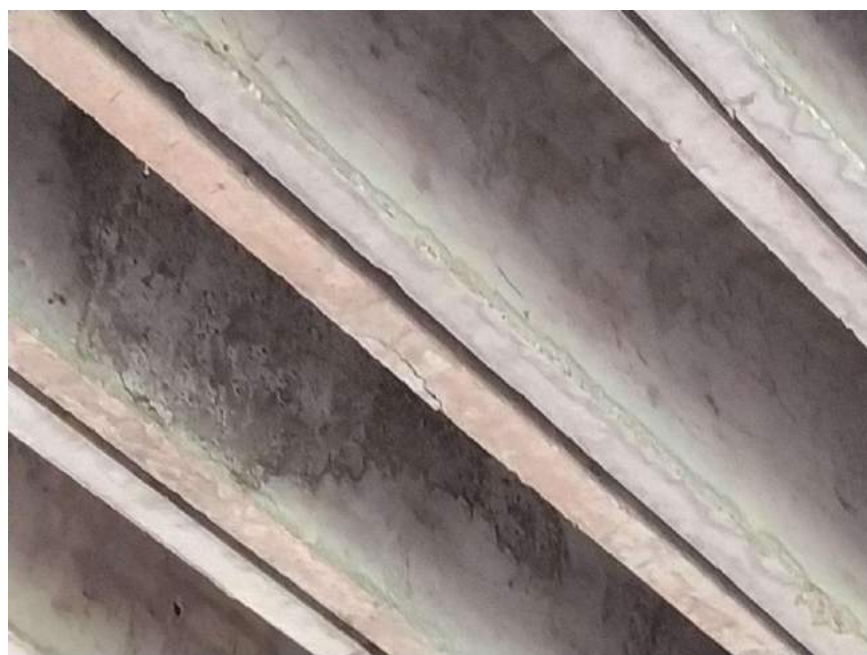
Figura 53 – Rompimento do concreto ao longo da seção longitudinal da armadura, sentido sul-norte
