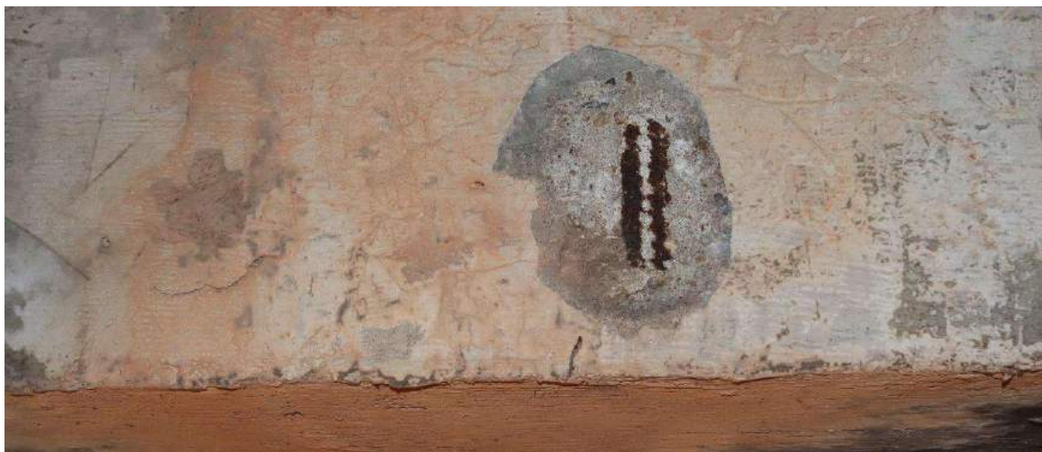
Figura 78 – Armaduras expostas na longarina, sentido leste-oeste
