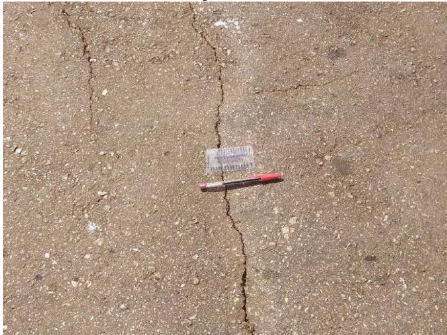
Figura 84 – Fenda de 2,0 mm em degrau na cabeceira oeste, sentido oeste-leste
