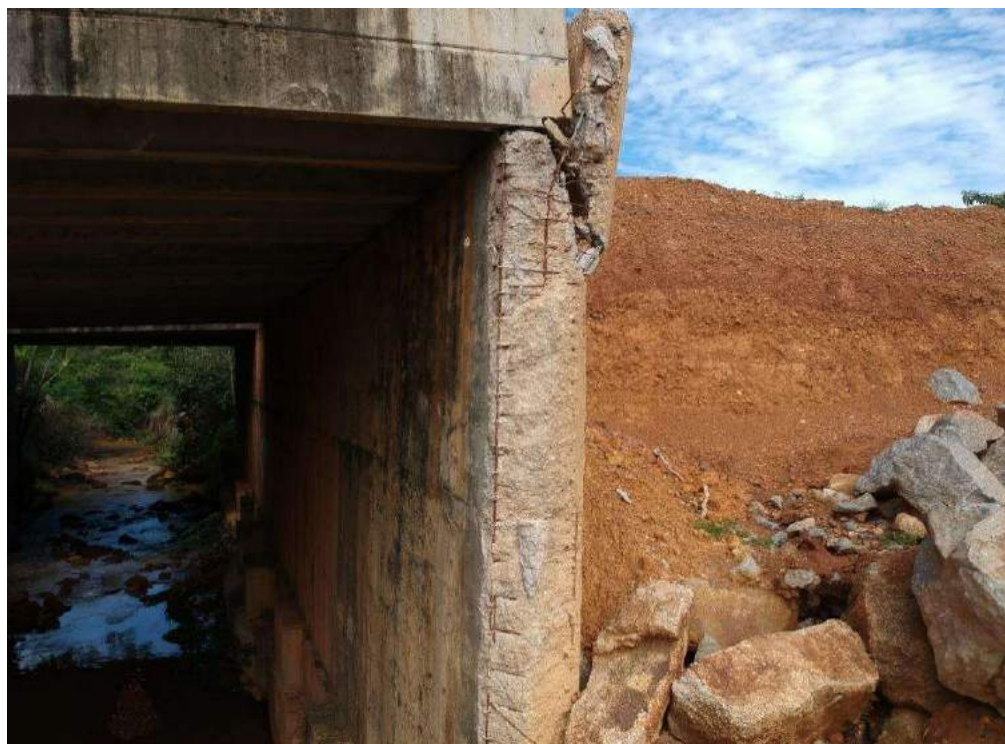
Figura 39 – Armadura de pilar exposta
