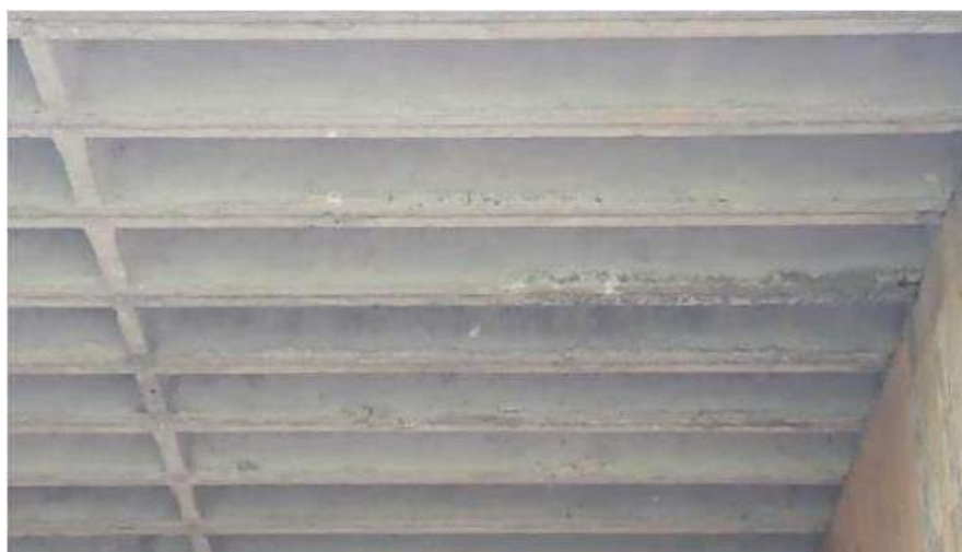
Figura 35 – Armaduras expostas na região do tabuleiro sul-norte em 2018
