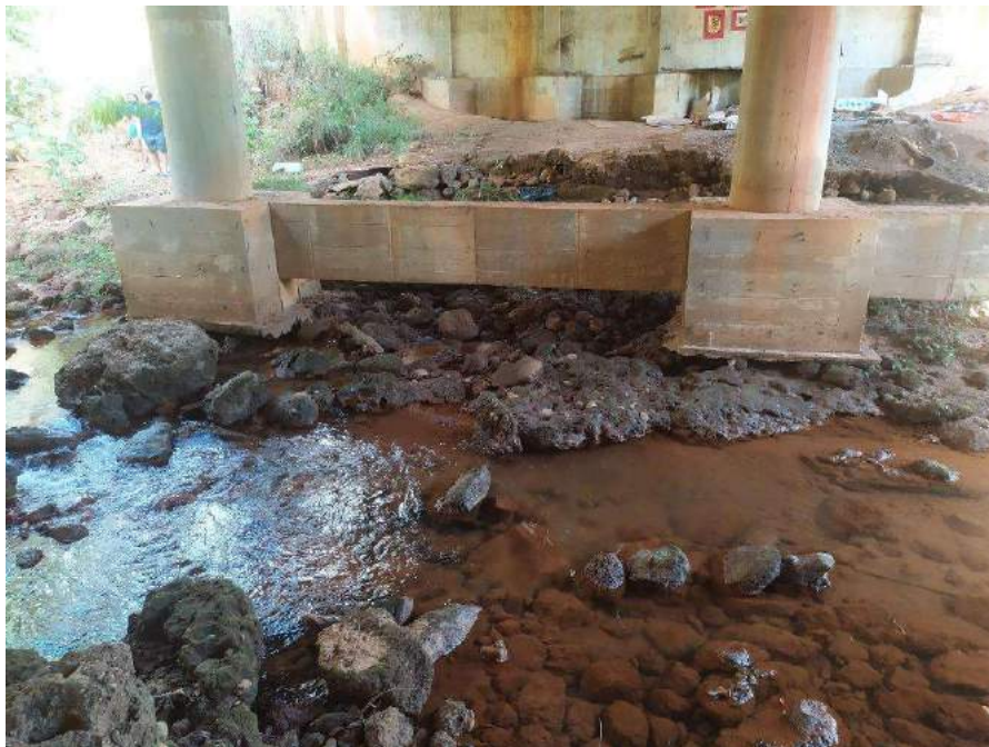
Figura 58 – Descalçamento do bloco de coroamento, sentido sul-norte
