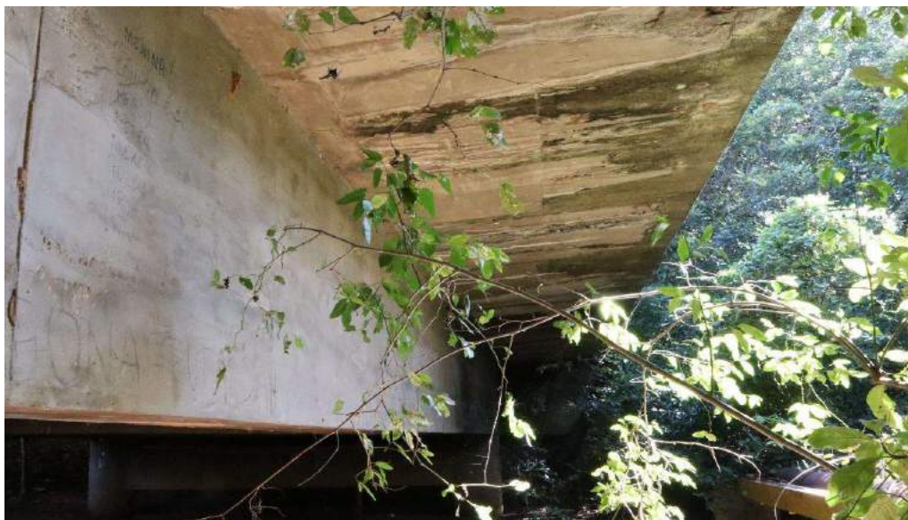
Figura 75 – Formação de limo e eflorescência na superfície inferior do passeio, sentido leste-oeste
