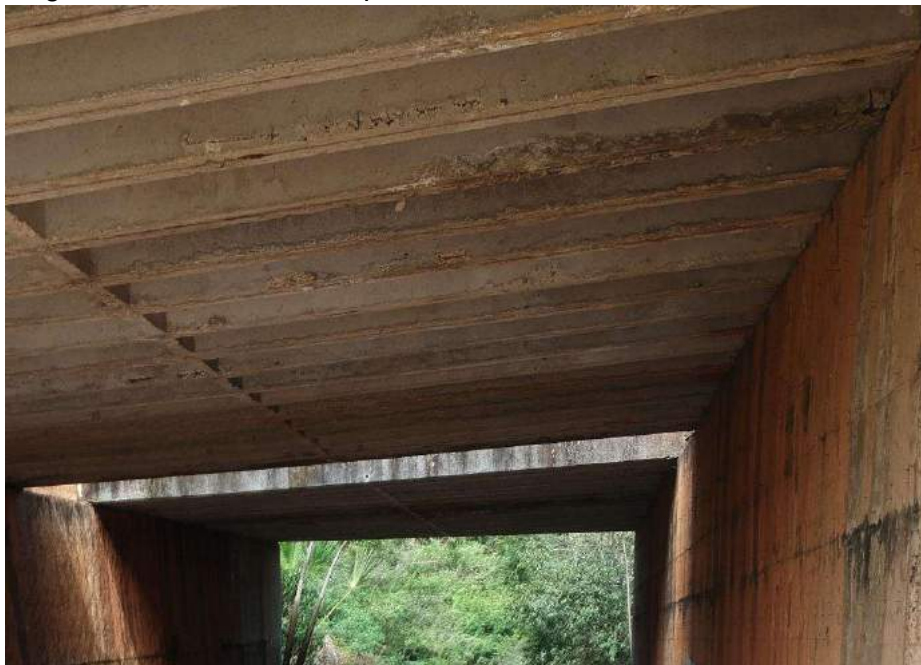
Figura 36 – Armaduras expostas nas nervuras do tabuleiro em 2019
