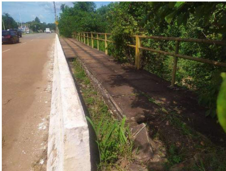
Figura 71 – Região do passeio danificada, sentido oeste-leste
