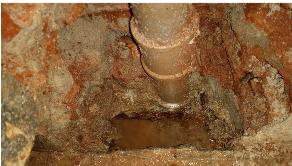
Figura 52 – Vazamento na tubulação que abastece a bacia sanitária no bloco 02
