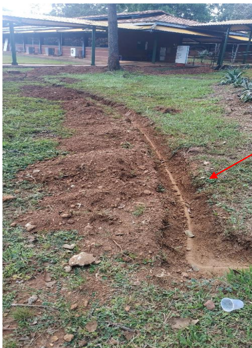
Figura 42 – Tubulação de água do auditório Bloco 3
