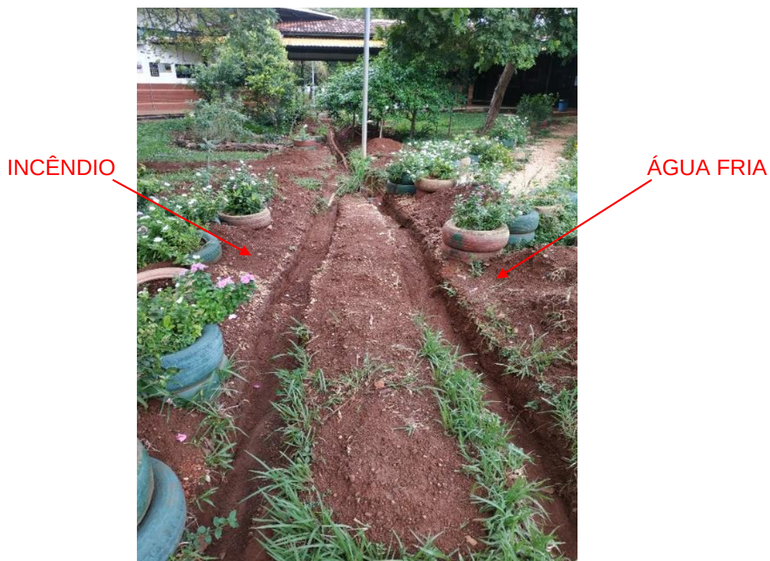
Figura 27 – Tubulação de água do bloco 05
