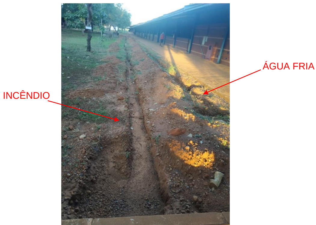
Figura 33 – Tubulação de água do bloco 07
