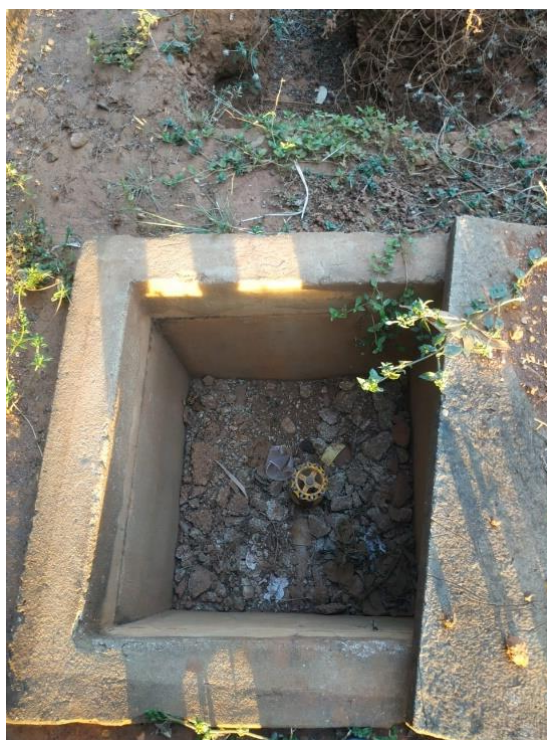
Figura 34 – Registro de água do bloco 07
