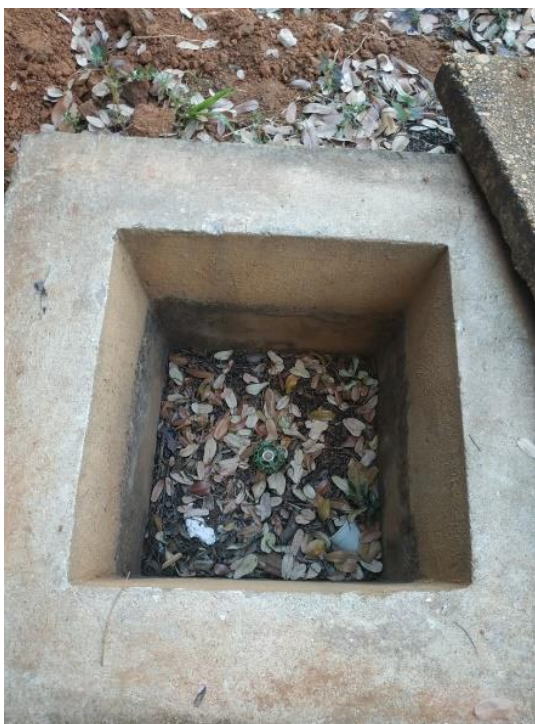
Figura 36 – Registro de água do bloco 08
