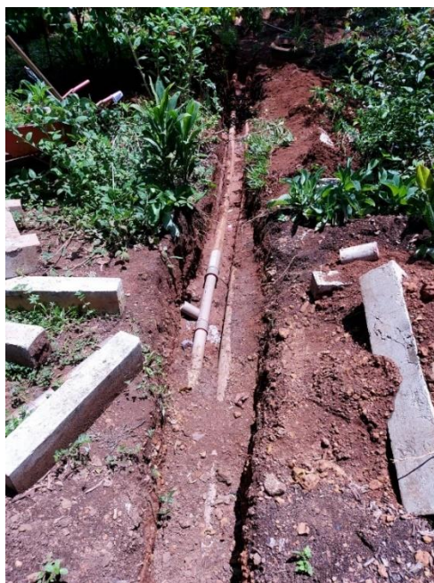
Figura 49 – Vazamento no ramal de água do bloco 05
