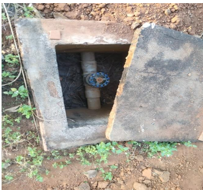
Figura 24 – Registro de água do bloco 02
