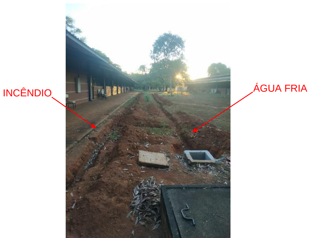
Figura 31 – Tubulação de água do bloco 06
