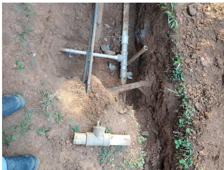
Figura 48 – Vazamento no ramal do bloco 10
