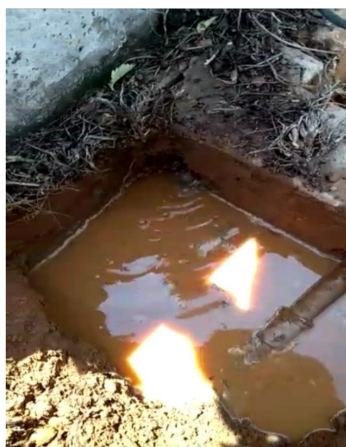
Figura 50 – Vazamento na tubulação que vem do hidrômetro
