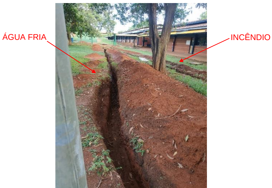
Figura 28 – Tubulação de água do bloco 05
