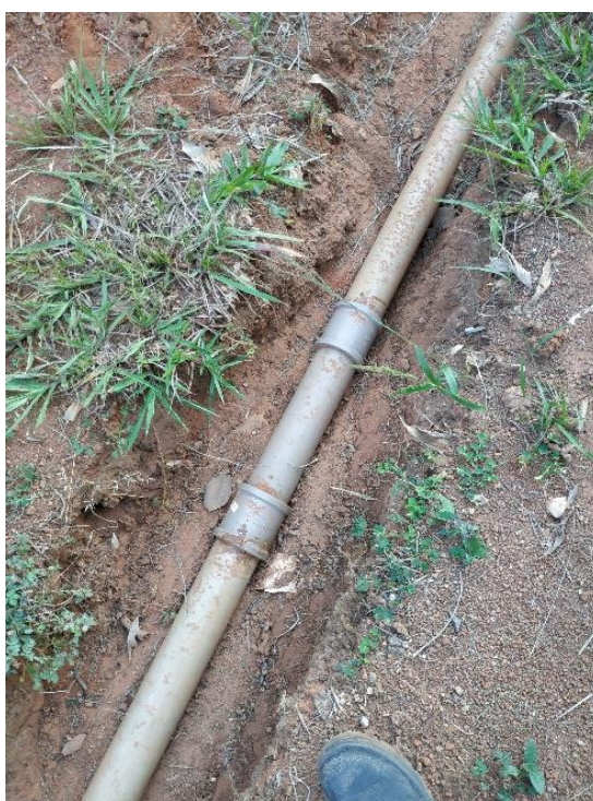
Figura 54 – Vazamento na rede do bloco 07
