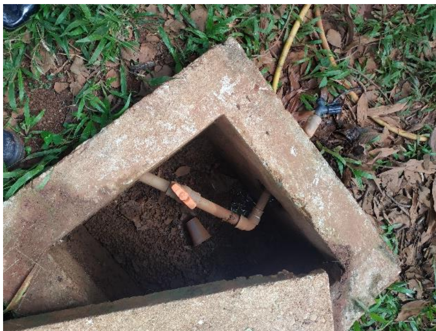
Figura 44 – Vazamento na torneira no bloco 5
