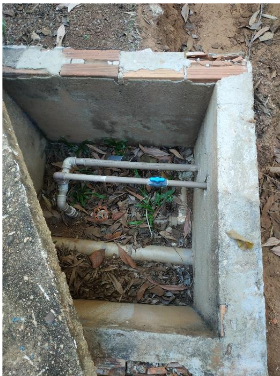
Figura 39 – Registro de água do bloco 10
