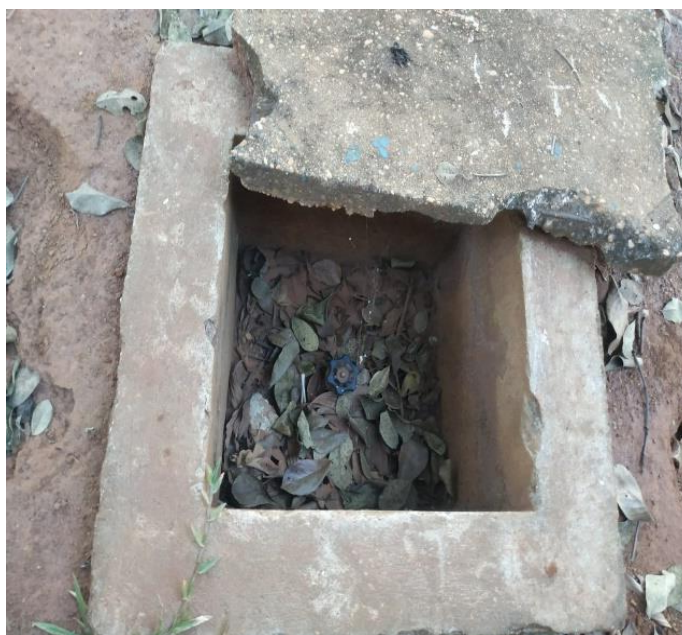
Figura 26 – Registro de água do bloco 04
