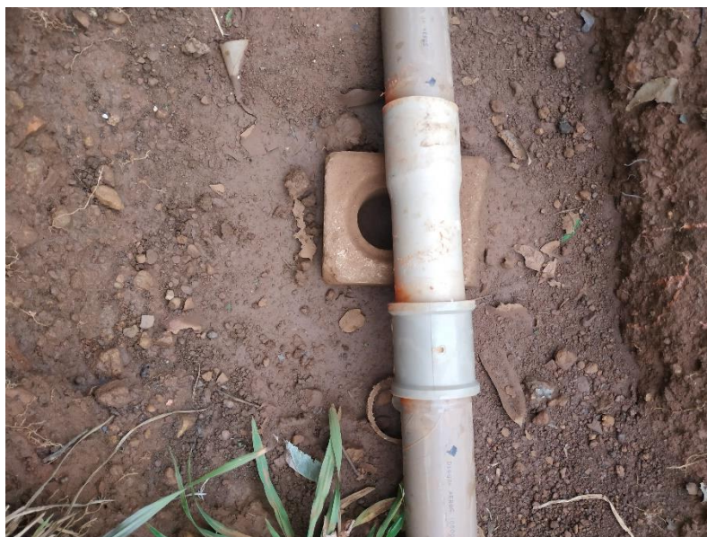
Figura 47 – Vazamento no ramal de água
