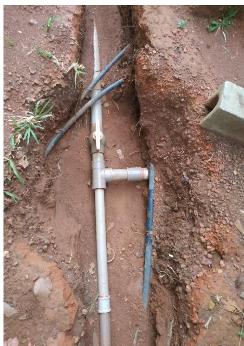
Figura 46 – Vazamento no ramal de água
