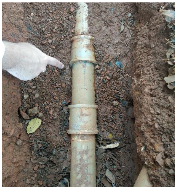
Figura 53 – Vazamento na rede do bloco 05
