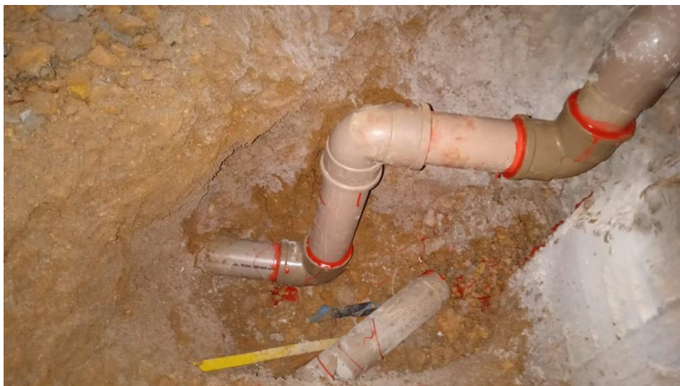
Figura 51 – Vazamento na tubulação que abastece a bacia sanitária no bloco 10
