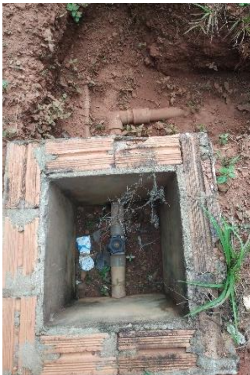
Figura 41 – Registro de água do bloco 11
