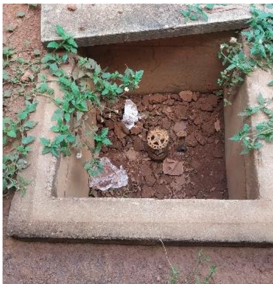
Figura 45 – Vazamento no registro no bloco 6
