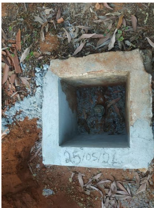
Figura 32 – Registro de água do bloco 06
