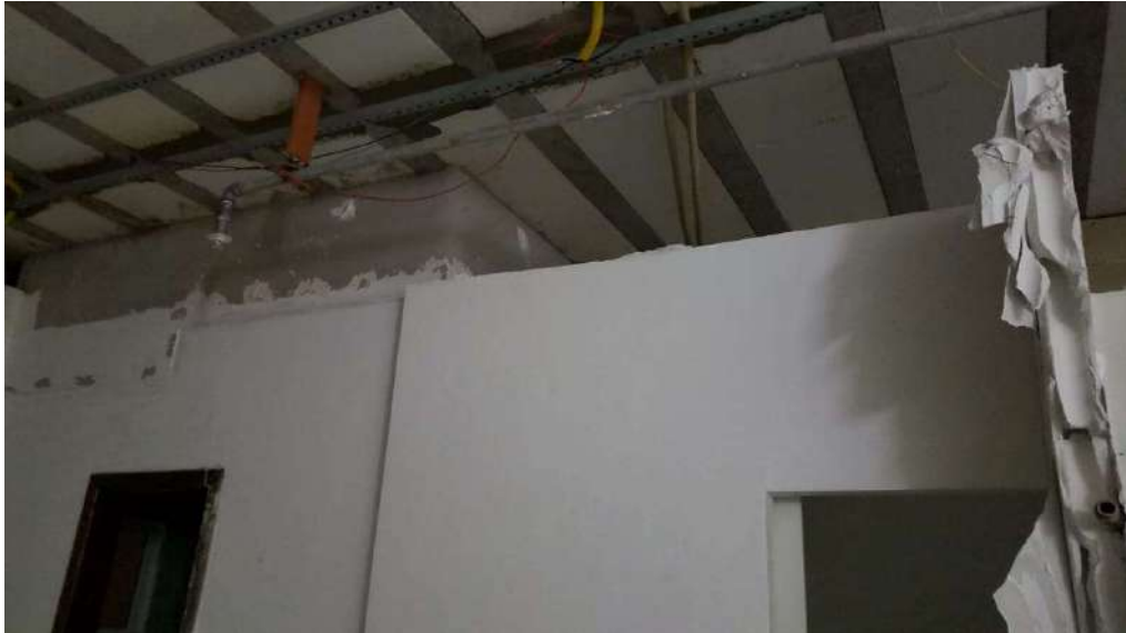
Figura 33 - Local com cabeamento exposto
