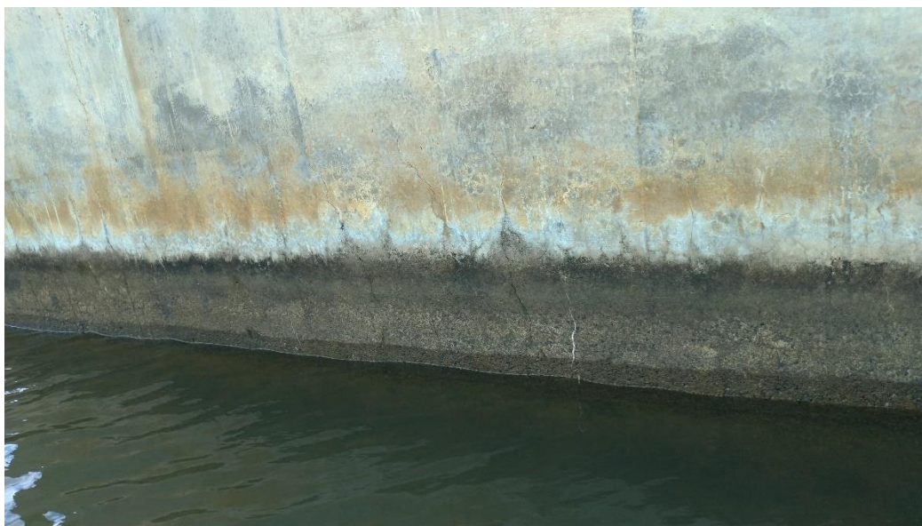
Figura 65 - Fissuras longitudinais - P11
