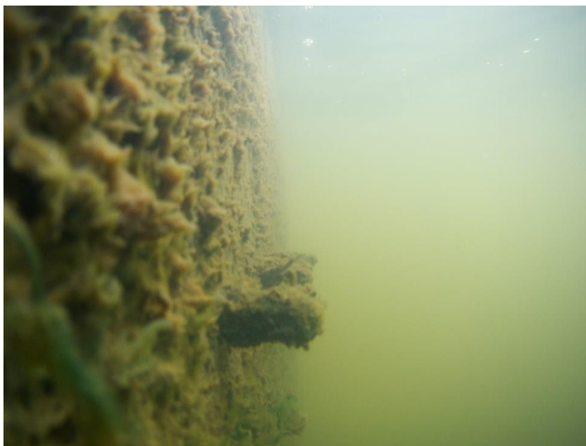
Figura 74 - Barras de aço expostas a cerca de 40 cm de profundidade - P11
