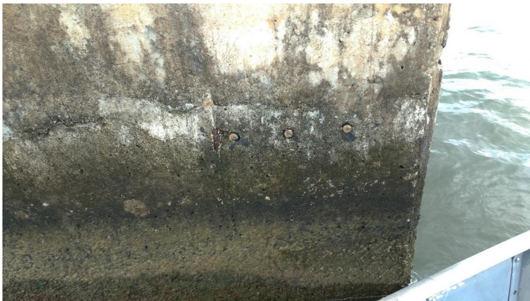
Figura 58 - Armadura exposta devido a corrosão do concreto - P13
