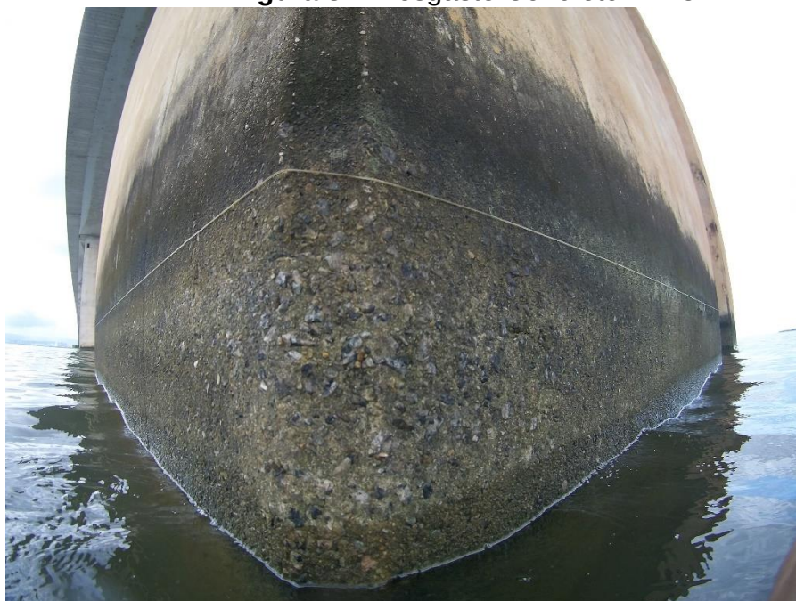
Figura 34- Desgaste Concreto - P18
