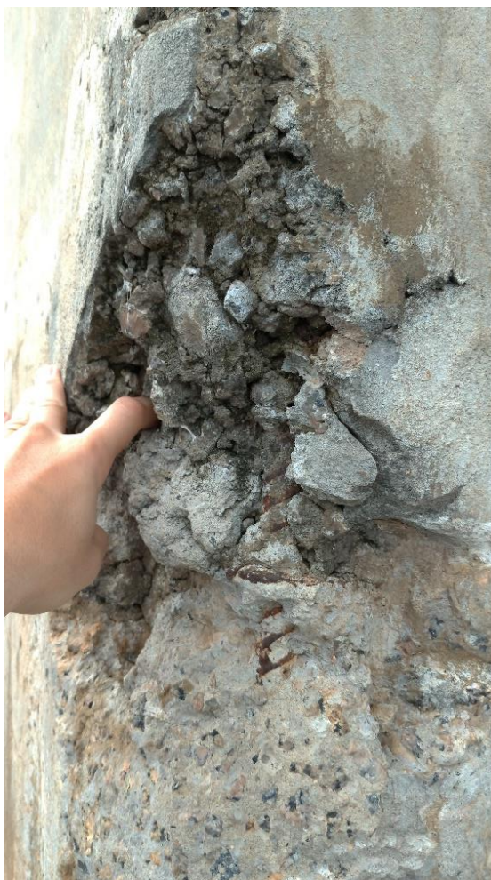
Figura 52 – Fratura com desagregação - P11
