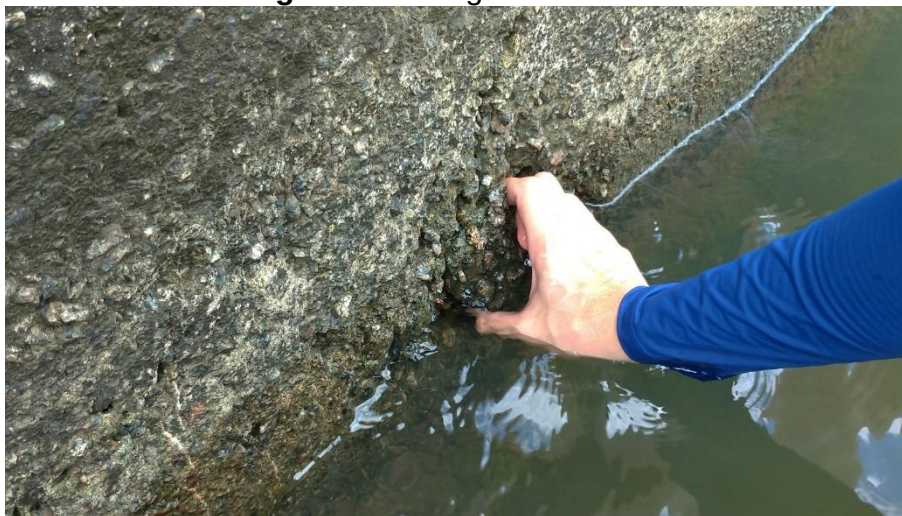
Figura 36- Desgaste Concreto - P12
