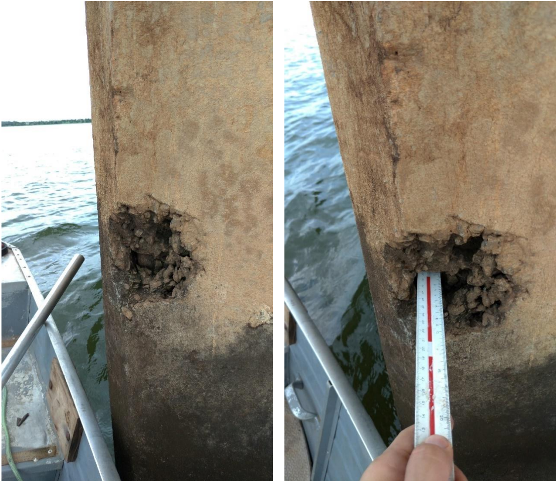
Figura 62 – Falha de concretagem
