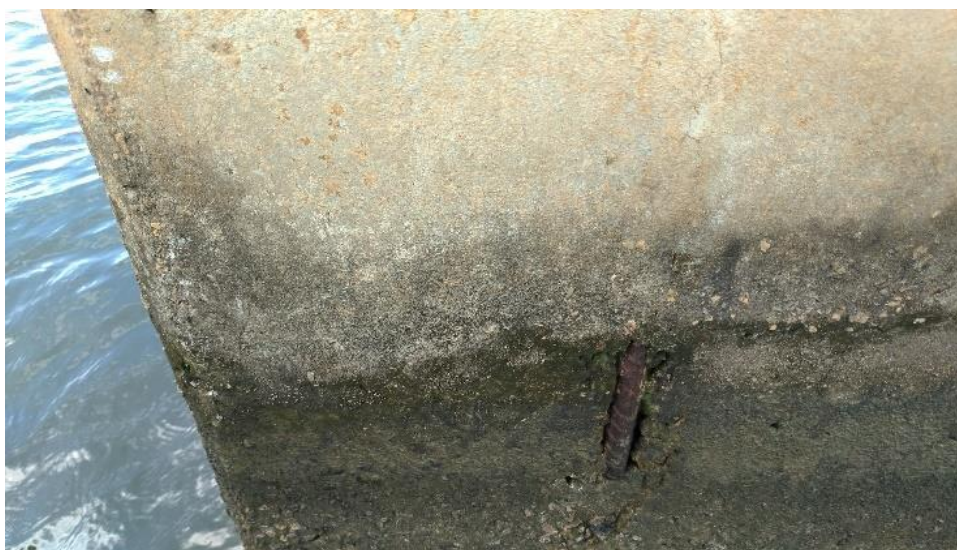
Figura 57 - Armadura exposta devido a corrosão do concreto - P14
