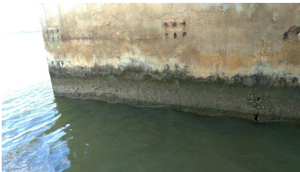
Figura 64 – Fissuras longitudinais - P12
