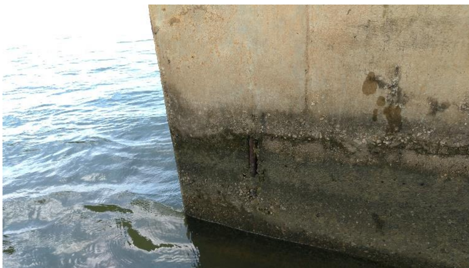
Figura 59 - Armadura exposta devido a corrosão do concreto – P14
