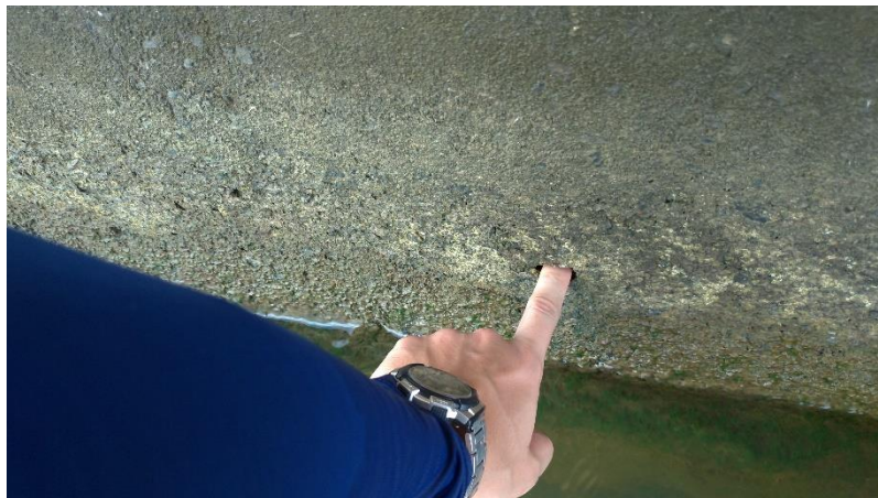
Figura 60 – Falha de concretagem P-6
