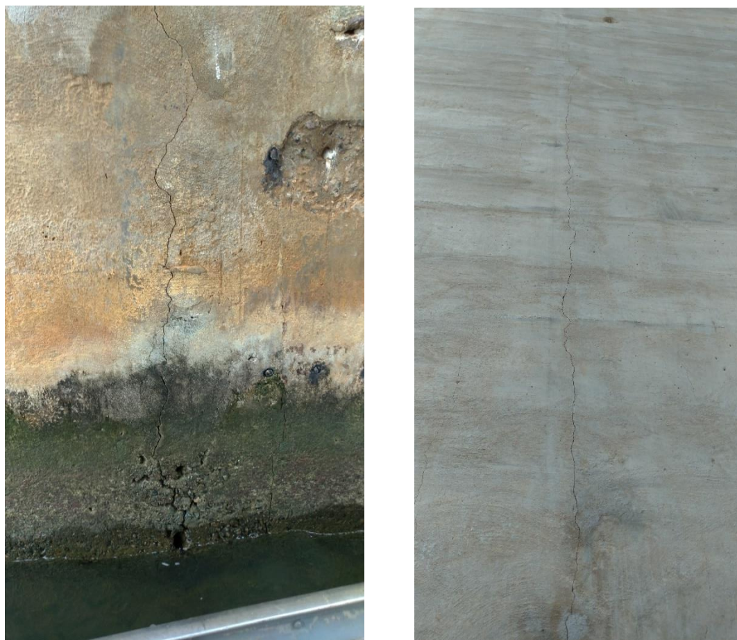
Figura 68 – Fissura longitudinal com mais de 5 m de comprimento – P12
