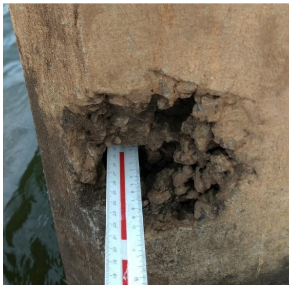
Figura 63 – Profundidade falha de concretagem
