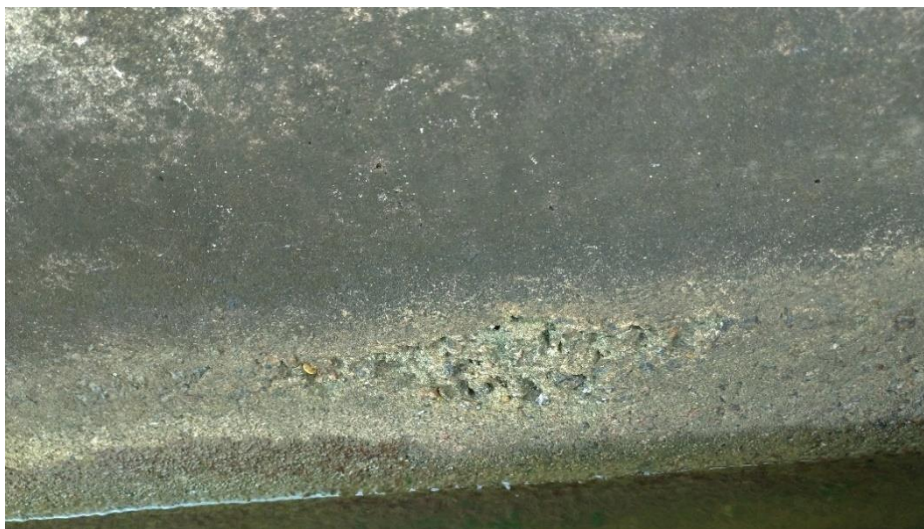
Figura 61 – Falha de concretagem – P9
