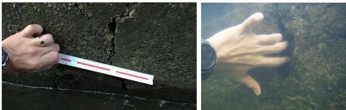
Figura 67 - Fenda acima e abaixo do nível d'água – P11
