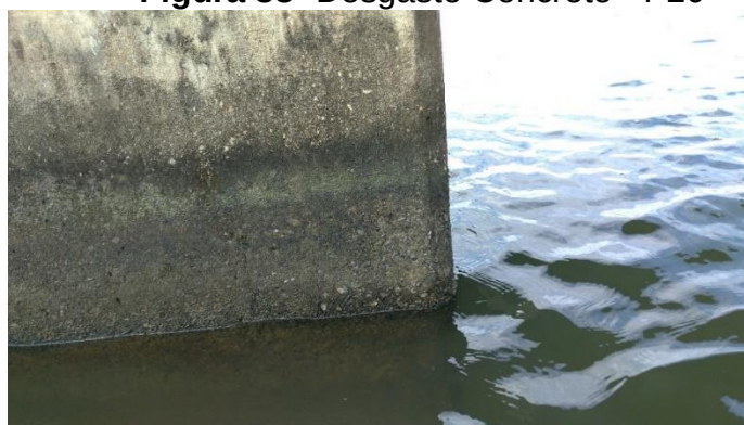
Figura 33- Desgaste Concreto - P20
