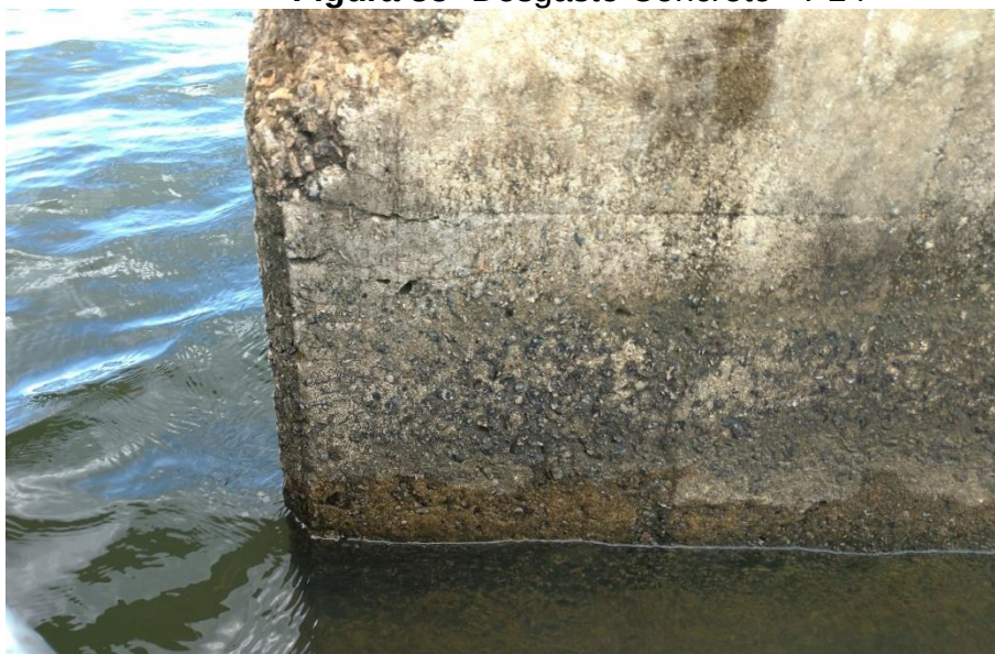
Figura 35- Desgaste Concreto - P14
