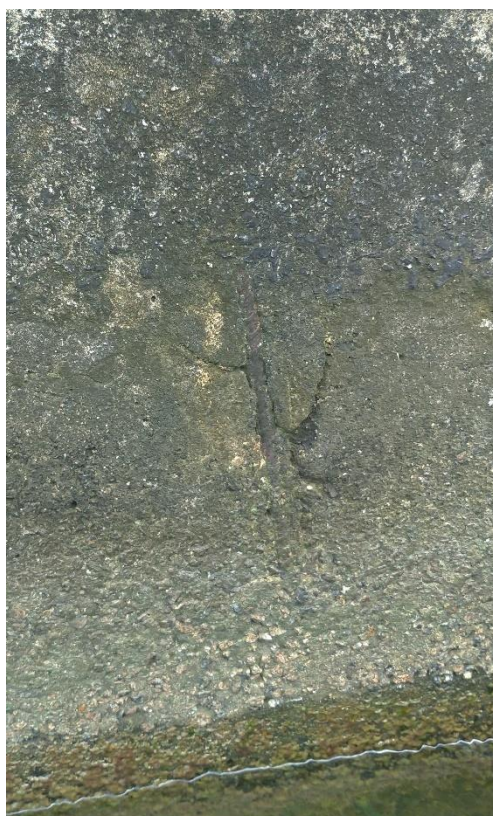
Figura 56 – Armadura exposta devido a corrosão do concreto - P15
