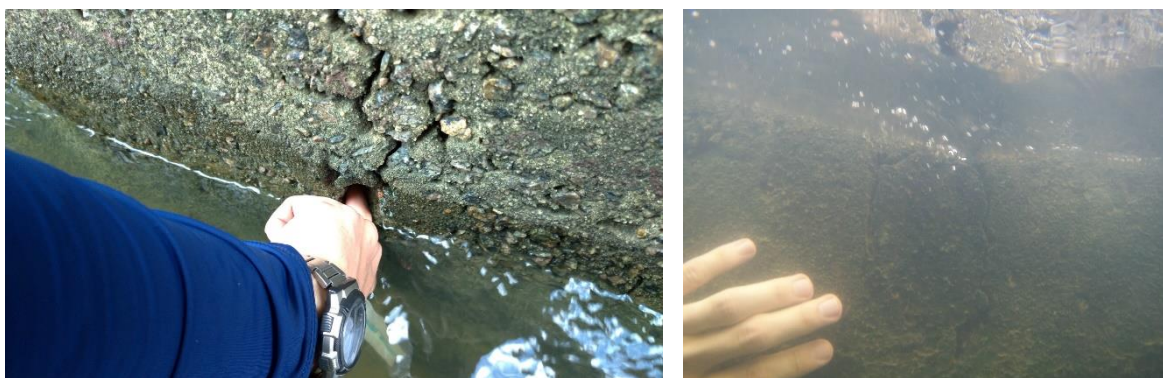
Figura 66 – Fenda acima e abaixo do nível d'água – P12
