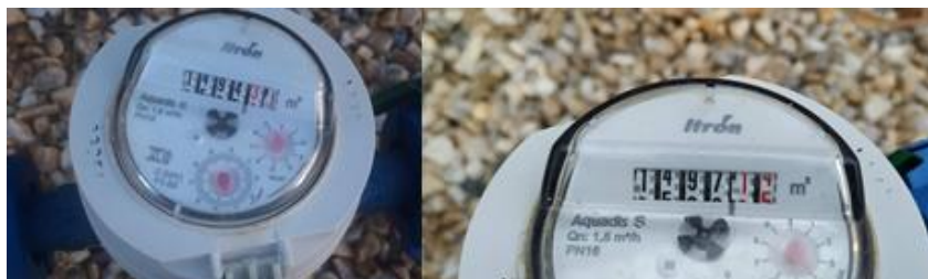
Figura 6 - Leitura do hidrômetro dos blocos 16 e 17.
