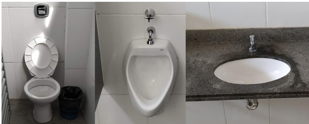
Figura 5 - Equipamentos hidráulicos dos blocos novos.
