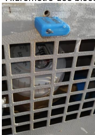
Figura 7 - Hidrômetro dos blocos 14 e 15.
