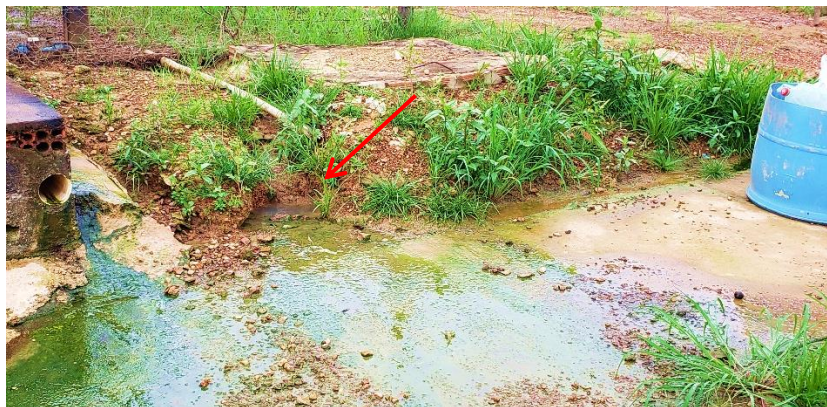
Figura 25 – Extravasamento de fossa com efluente (Rua 5 de Abril)
