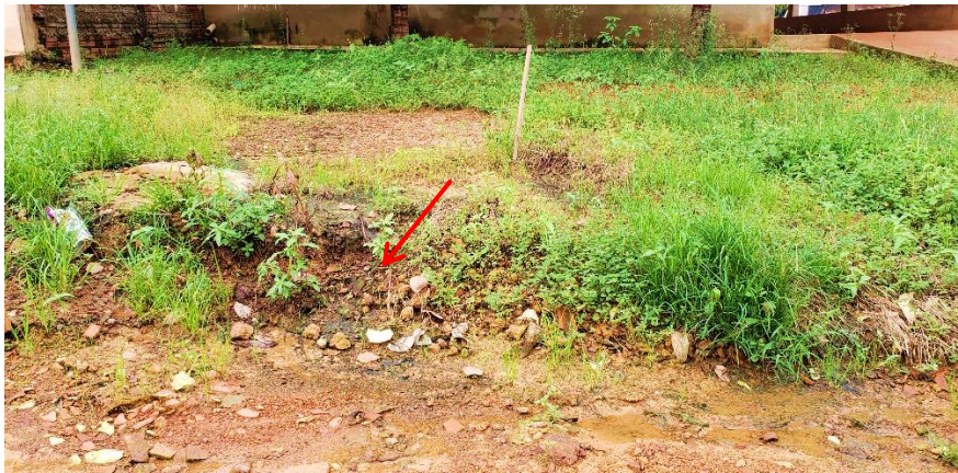
Figura 29 – Extravasamento de fossa apresentando lodo no ponto extravasado e efluentes percorrendo a via (Rua Antônio Benvindo)
