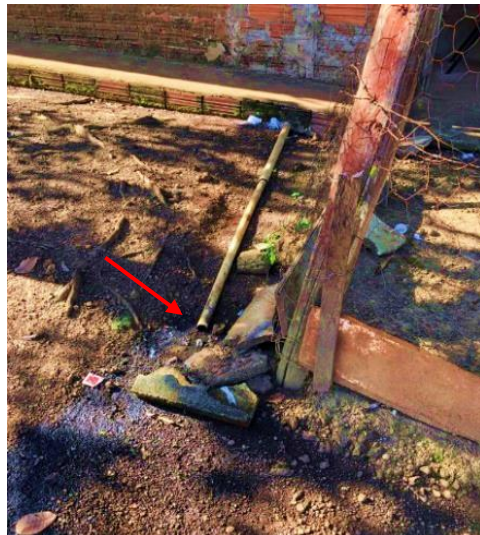
Figura 51 – Descarte incorreto de esgoto doméstico (Rua Duque de Caxias)
