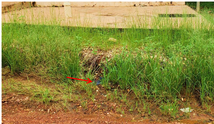
Figura 30 – Extravasamento de fossa com formação de lodo no ponto extravasado e efluentes percorrendo a via (Rua Antônio Benvindo)
