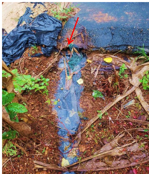
Figura 32 – Detalhe do ponto de extravasamento da fossa da Figura 31 apresentando efluente com material suspenso
