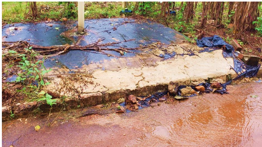
Figura 31 – Fossa com revestimento inadequado (Rua Cícero Virgínio)
