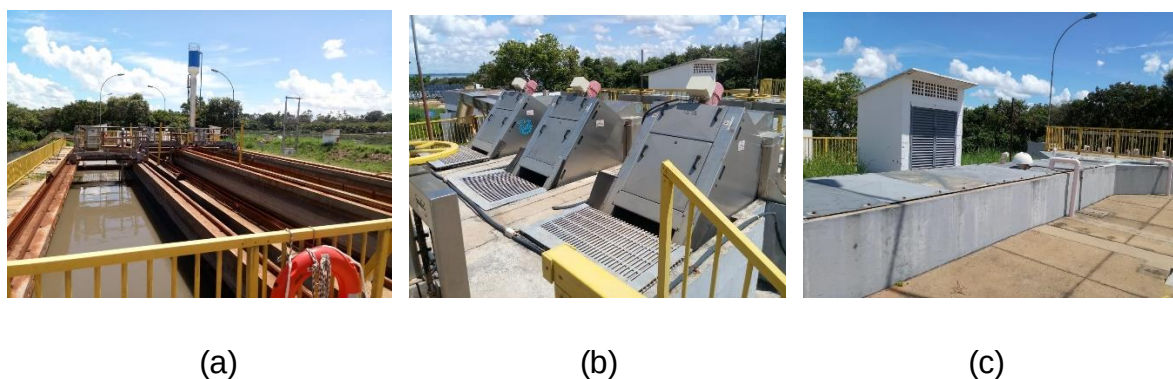
Figura 4 - Tratamento Preliminar: (a) Desarenadores, (b) step screen, (c) calha parshall
