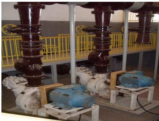
Figura 3 - Elevatória de esgoto bruto
