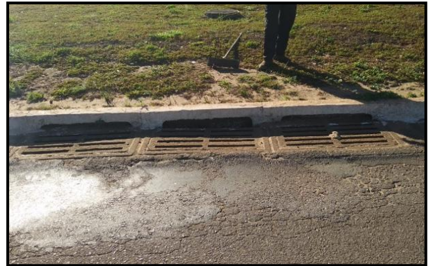
Figura 12 - BL múltipla combinada com depressão Av. Teotônio Segurado
