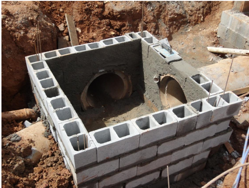
Figura 14 – Caixa de passagem em alvenaria
