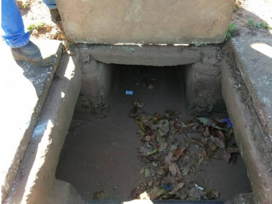
Figura 45 - Presença de lixo na caixa coletora
