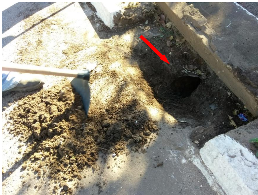
Figura 52 – Tubulação em PVC deteriorada Ø150mm
