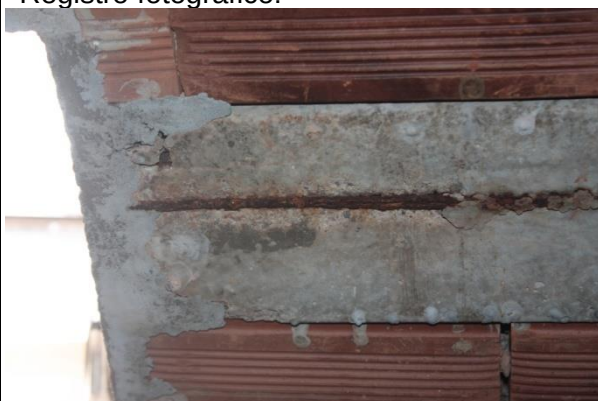
Reservatório inferior do Bloco A
