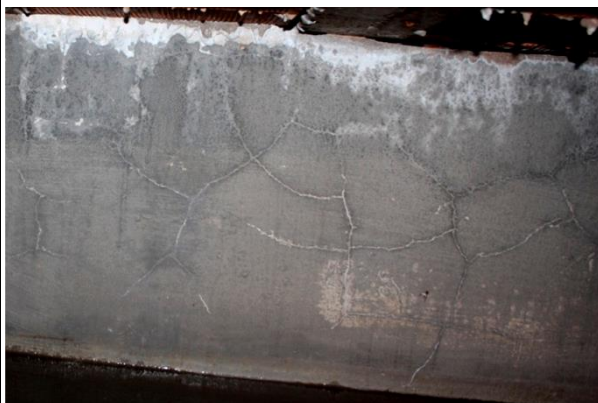
Reservatório inferior do Bloco A
