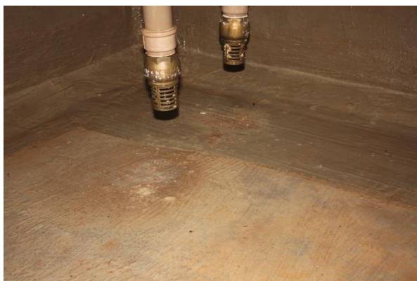
Reservatório inferior do Bloco A
