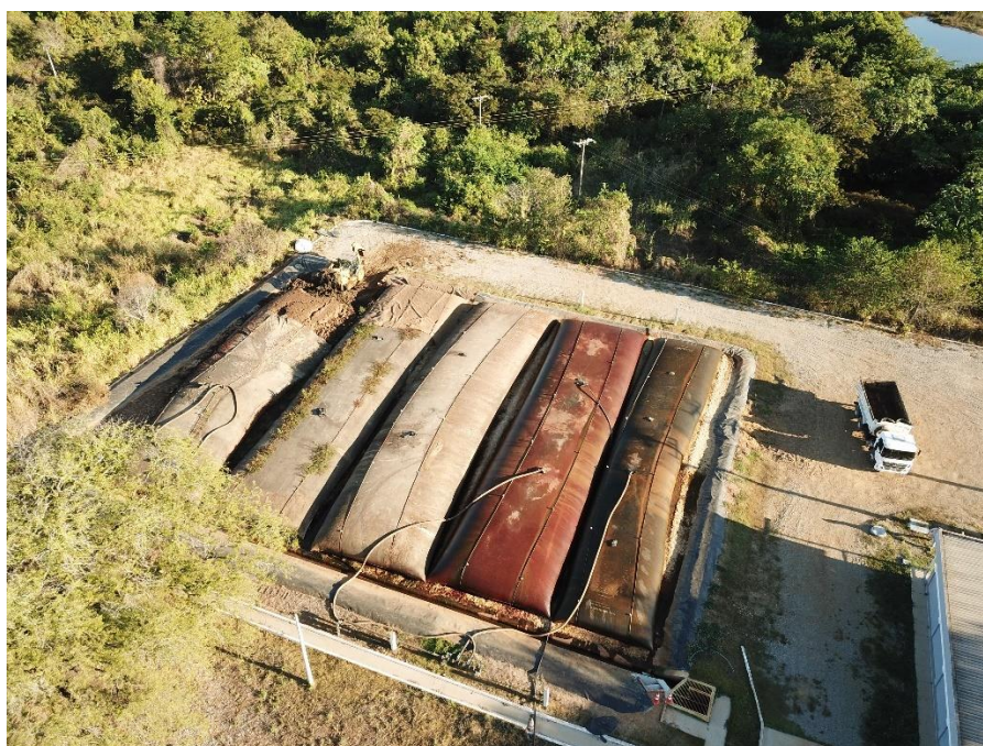
Figura 4.8 - Sistema de desaguamento de resíduos da ETA 006 em Palmas - TO
