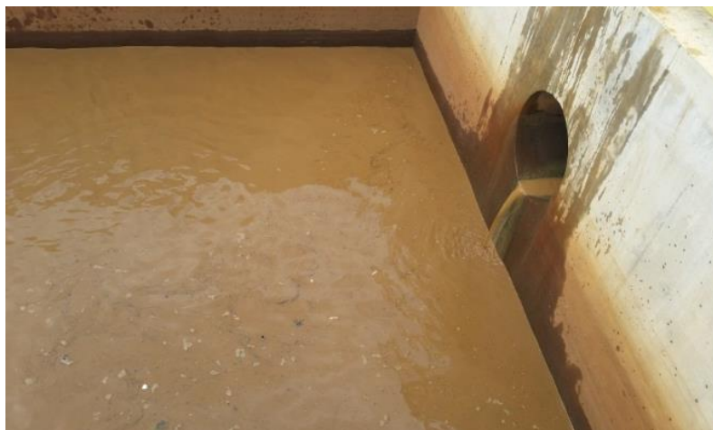
Figura 4.6 – Entrada do resíduo do decantador no TRDD/SALF
