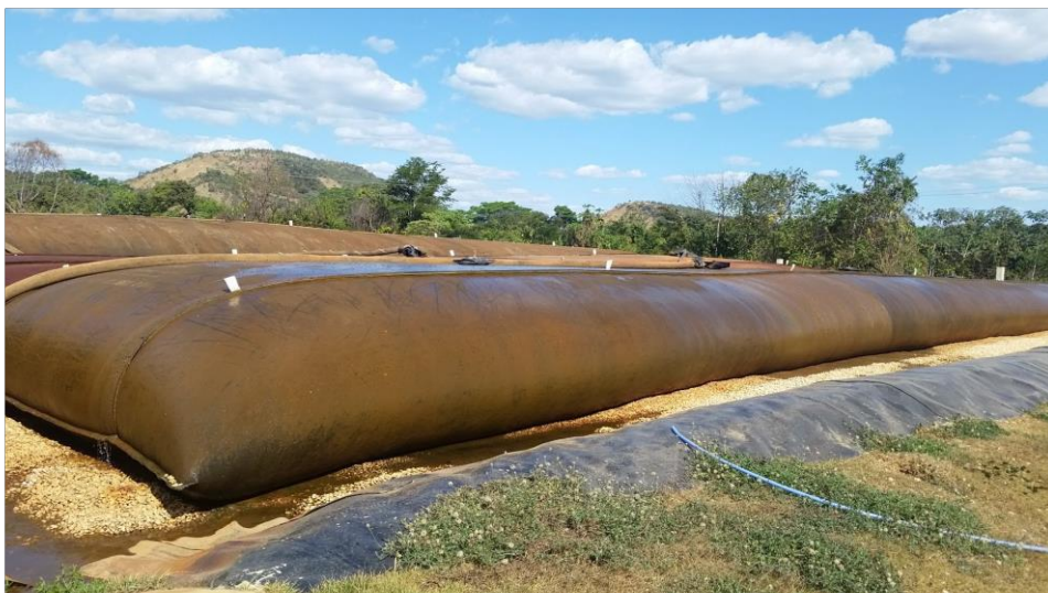
Figura 4.7 - Bag geotêxtil instalado no sistema de tratamento dos resíduos
