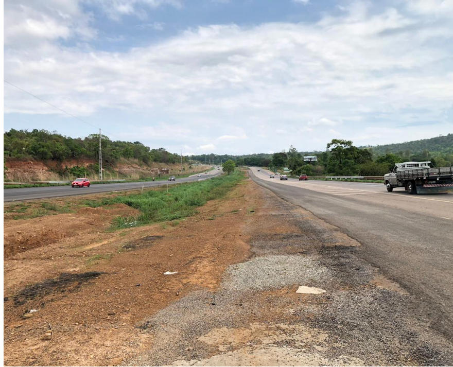
Figura 33 – Elementos de sinalização horizontal parcialmente apagados e ausência de guias e sarjetas na via.
