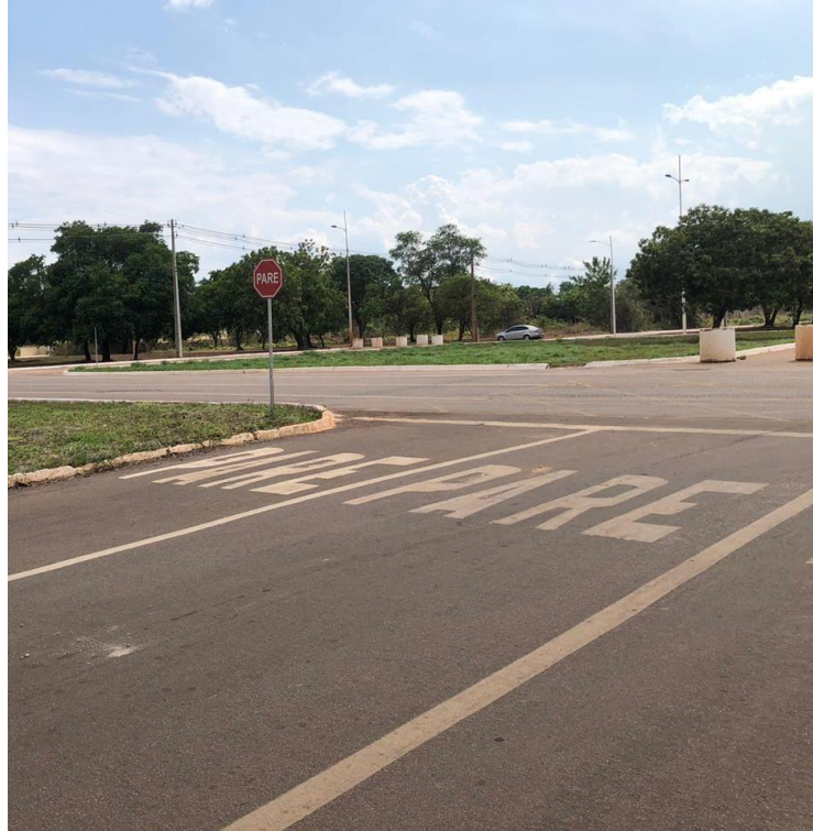
Figura 21 – Elementos de sinalização horizontais parcialmente apagados.
