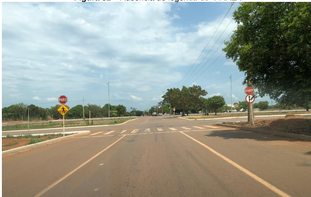
Figura 32 – Ausência de legenda de “PARE”.
