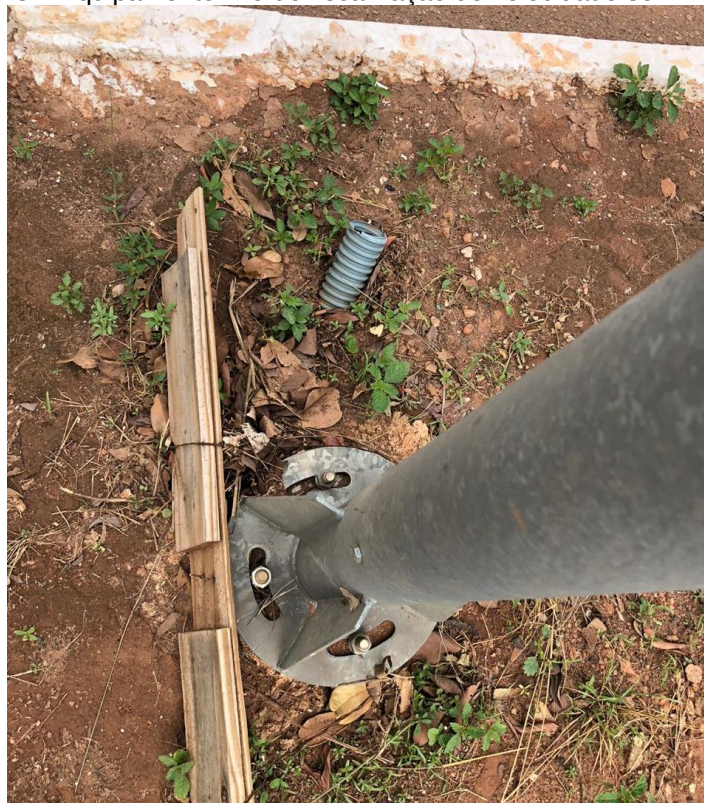
Figura 25 – Equipamento fixo de fiscalização de velocidade sem instalação.
