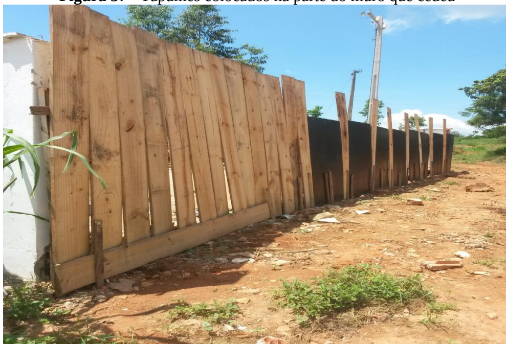
Figura 37 – Tapumes colocados na parte do muro que cedeu
