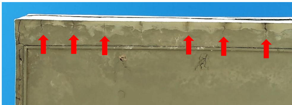
Figura 63 – Fissuras espaçadas na borda livre da marquise e destacamento de revestimento
