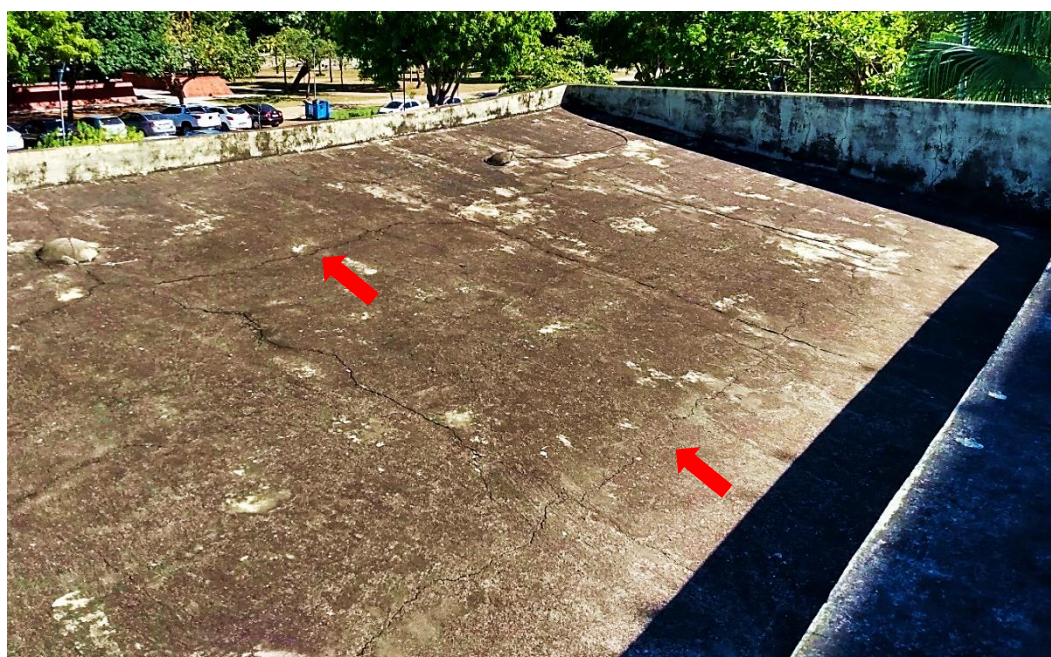
Figura 40 – Fissuras longitudinais na marquise
