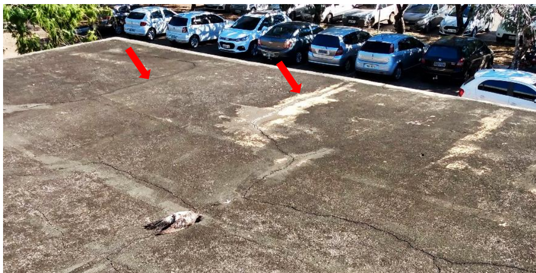
Figura 59 – Fissuras transversais na marquise do Terratins
