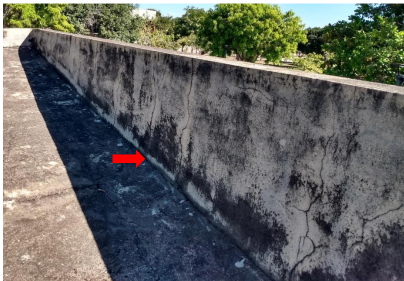
Figura 52 – Presença de bolor (mofo) na marquise da Procuradoria Geral do Estado
