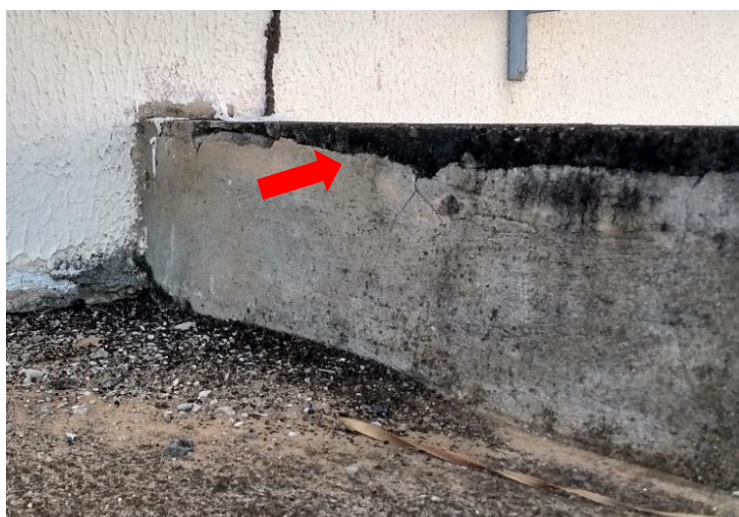
Figura 93 – Fissura no revestimento da viga
