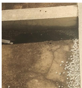
Figura 89 – Fissuras mapeadas na marquise do bloco L4
