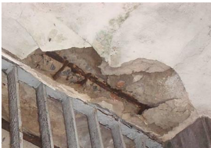
Figura 11 – Desplacamento de concreto
