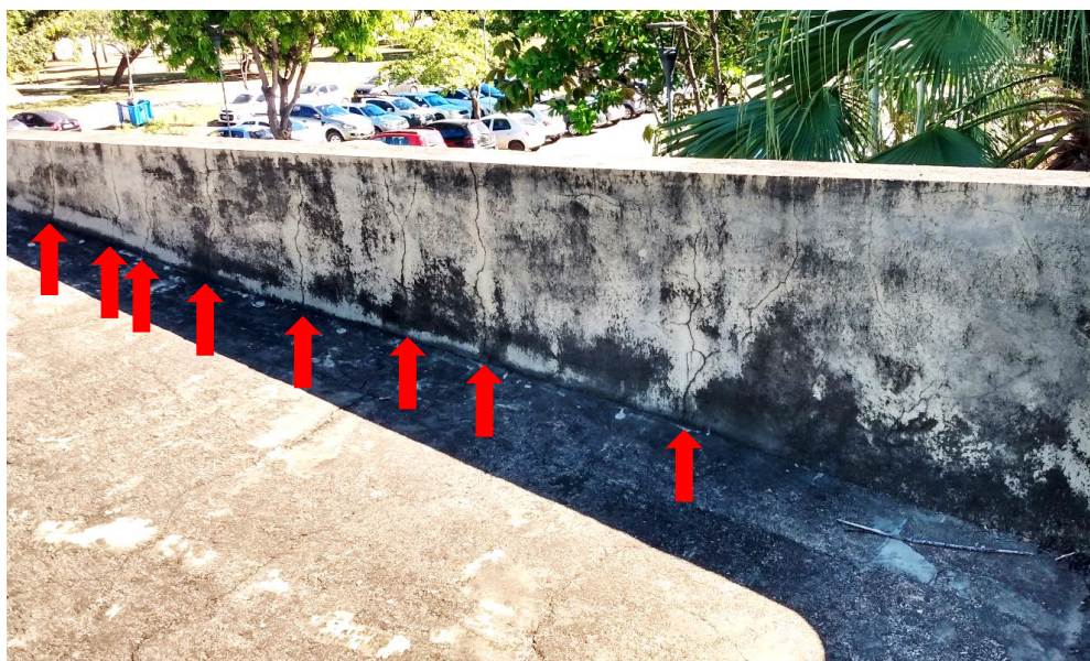
Figura 48 – Fissuras na face interna da viga lateral direita da marquise
