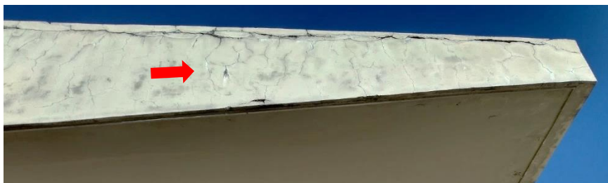
Figura 61 – Fissuras mapeadas na face externa da lateral direita da marquise
