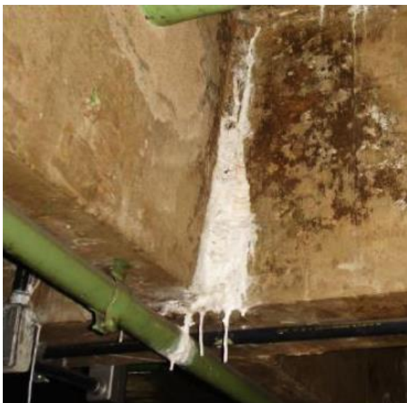
Figura 9 – Eflorescências em viga de concreto armado.
