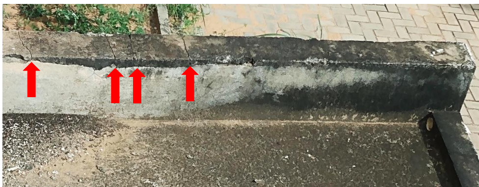
Figura 94 – Fissuras espaçadas na viga de bordo da marquise
