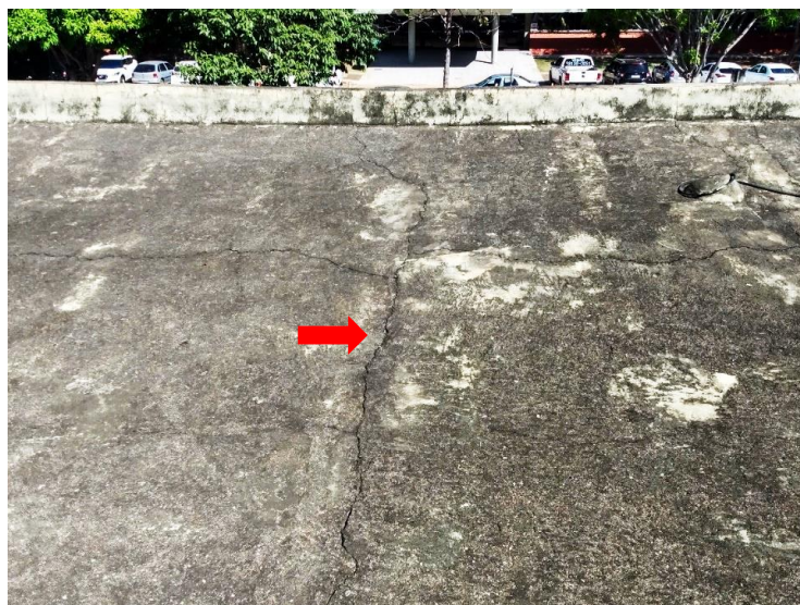
Figura 41 – Fissura transversal na marquise da Procuradoria Geral do Estado
