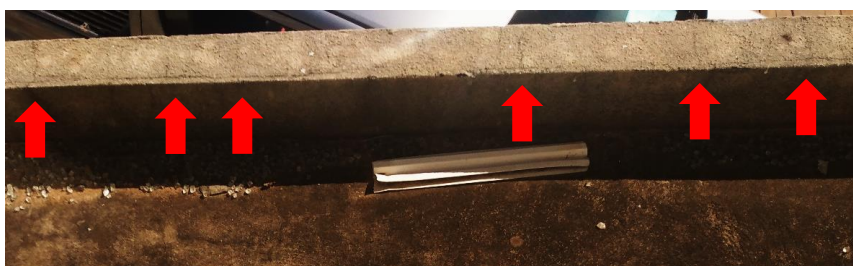
Figura 88 – Fissuras espaçadas na viga de bordo da marquise
