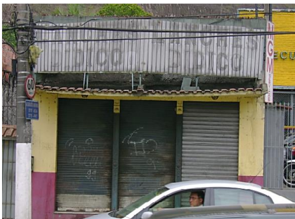
Figura 19 – Marquise deformada devido a aplicação de sobrecarga de painel publicitário
