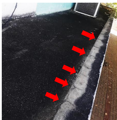
Figura 76 – Fissuras espaçadas na viga de bordo da marquise
