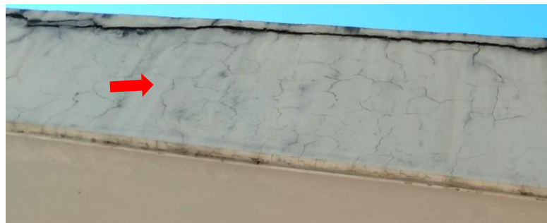
Figura 62 – Fissuras mapeadas na face externa da lateral esquerda da marquise
