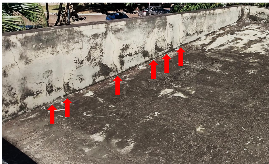
Figura 49 – Fissuras na face interna da viga lateral esquerda da marquise
