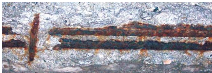
Figura 10 – Armadura de marquise com corrosão
