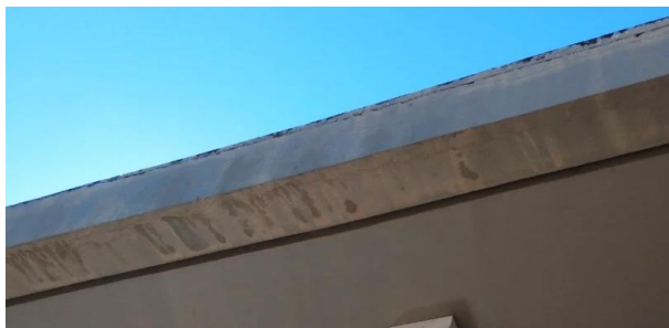
Figura 54 – Manchas de umidade na marquise
