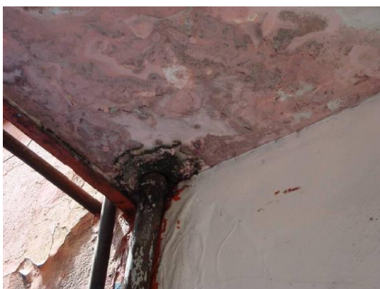
Figura 14 – Manchas de umidade na face inferior de uma marquise
