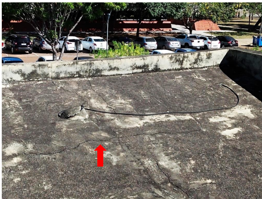
Figura 39 – Fissura longitudinal na marquise da Procuradoria Geral do Estado
