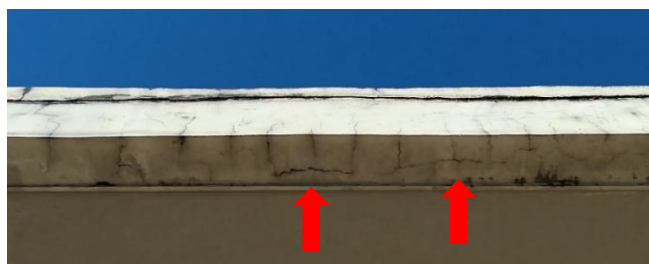
Figura 64 – Fissuras espaçadas na borda livre da marquise
