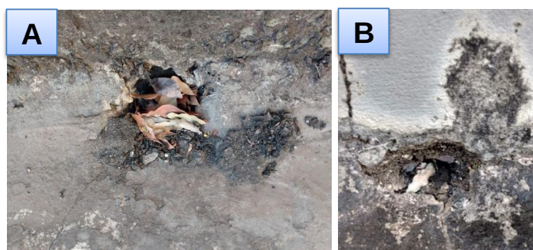
Figura 53 – Furo para drenagem na viga de bordo da marquise obstruído com material orgânico e apresentando mofo (A – Lateral direita da viga de bordo; B – Lateral esquerda da viga de bordo)
