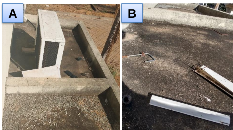
Figura 86 – Materiais sobre a marquise do bloco L4 (A – Equipamento de ar condicionado; B – Resíduos)
