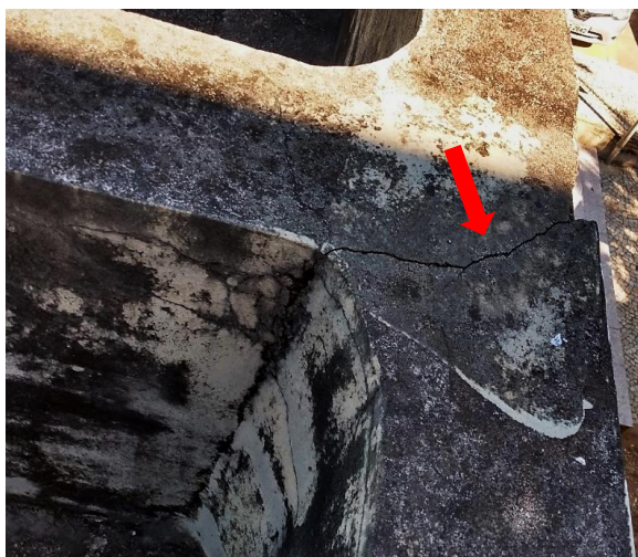
Figura 43 – Fissura inclinada na ligação entre viga lateral e viga de bordo
