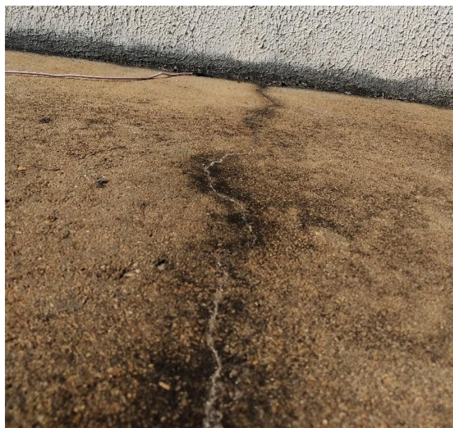
Figura 82 – Fissura transversal na marquise do bloco L2
