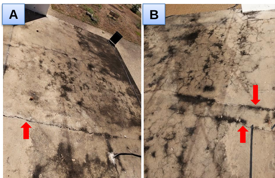
Figura 69 – Fissura transversal na marquise da biblioteca (A – Fissura no centro da marquise; B – Fissuras na lateral direita)
