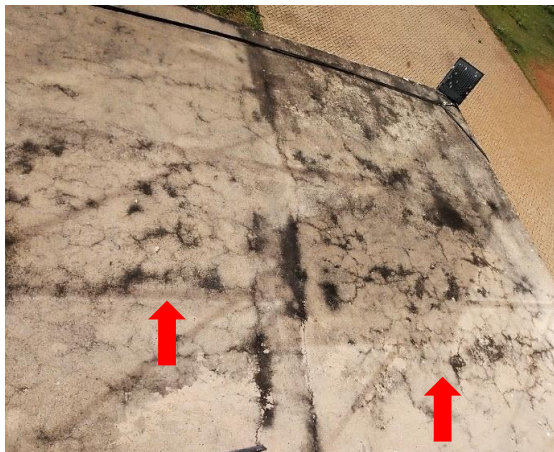
Figura 70 – Fissuras mapeadas na marquise da biblioteca
