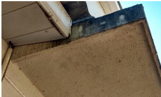
Figura 79 – Bolor na face lateral da marquise
