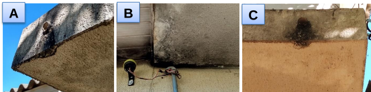
Figura 77 – Bolor na marquise (A – Bolor na região da tubulação de drenagem; B – Bolor na face inferior da marquise; C – Manchas de umidade)
