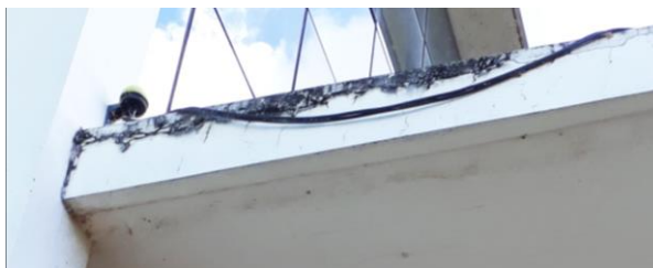
Figura 71 – Bolor na face lateral da laje
