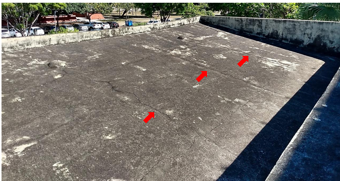
Figura 42 – Fissuras transversais na marquise da Procuradoria
