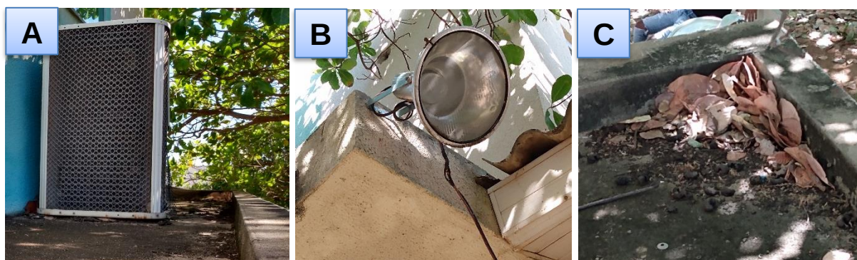
Figura 73 – Elementos sobre a marquise (A – Ar condicionado; B – Refletor; C – Material orgânico)
