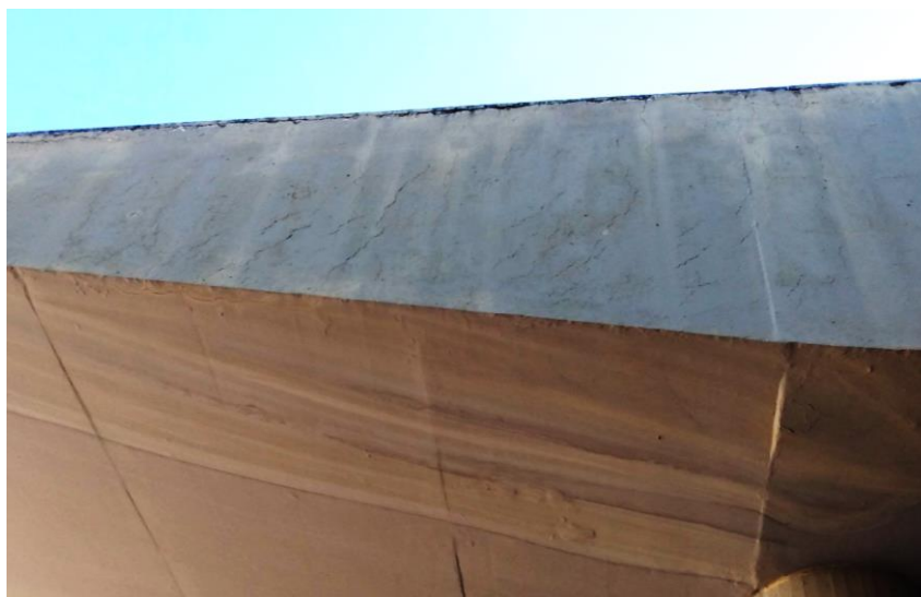
Figura 51 – Fissuras na face externa da viga lateral esquerda da marquise
