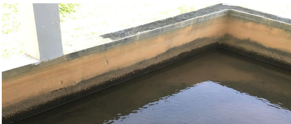
Degradação média do concreto com exposição dos agregados graúdos ocasionada pelo efeito abrasivo da água em movimento e presença de bolor/mofo nas paredes dos filtros.
