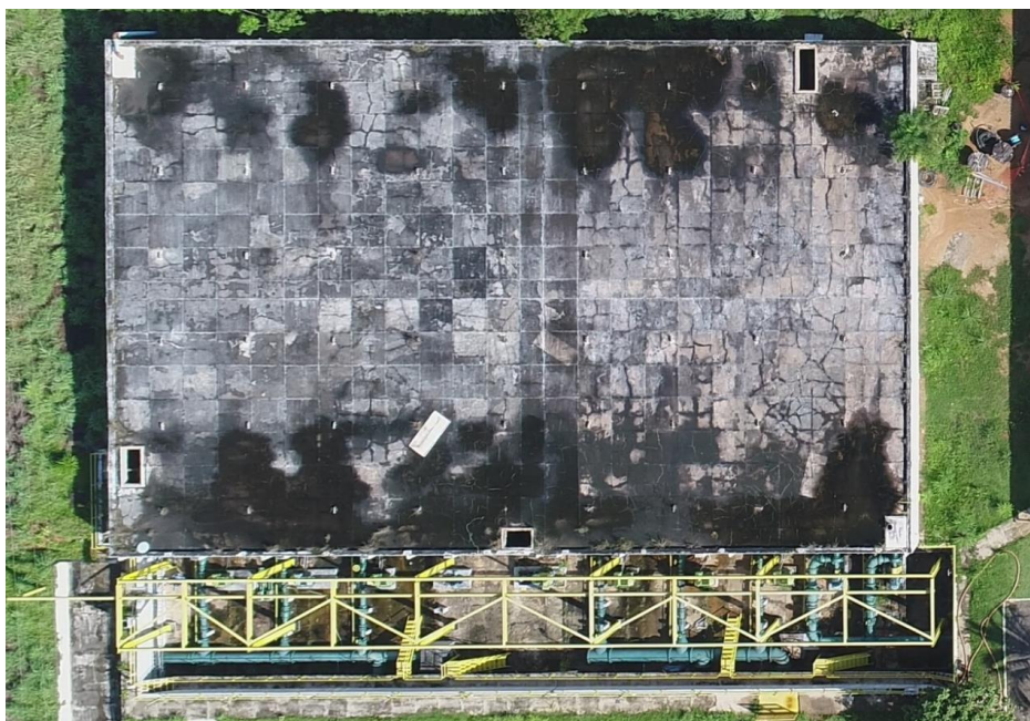
Vista aérea do reservatório com a presença de bolor/mofo, fissuras higrotérmicas e presença de vegetação de pequeno porte. Nota-se também vazamento de água nas das adutoras de distribuição de água.
