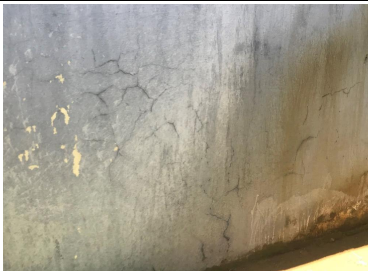
Parede com fissuras mapeadas indicativas de processo de retração hidráulica/térmica.
