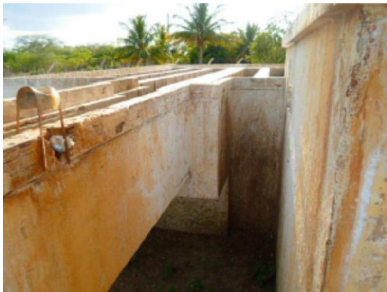
Figura 10 - Paredes com manchas de eflorescência
