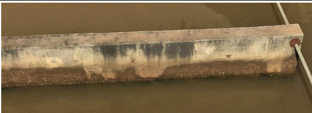
Canal de desaneração com degradação média do concreto, manchas de bolor/mofo e presença de fissuras.
