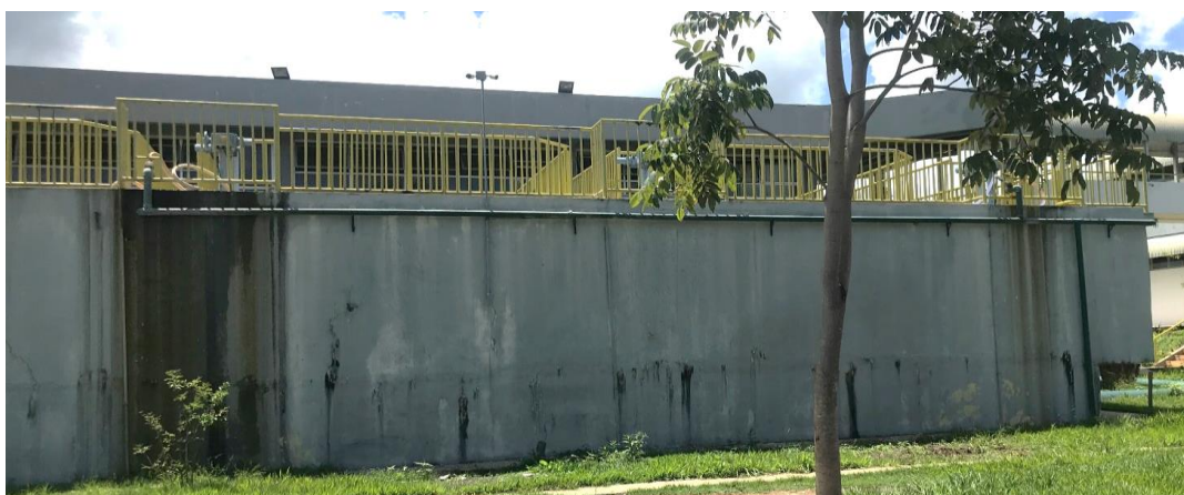
Parede externa dos filtros com presença eflorescências, fissuras e mofo/bolor.
