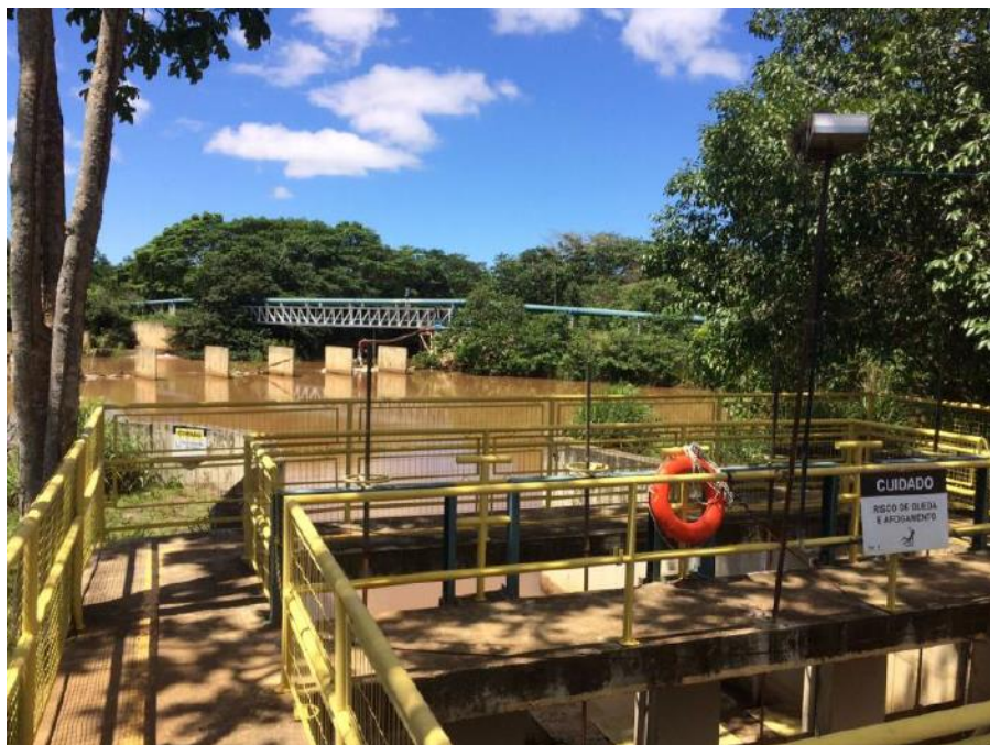
Figura 27 - Captação da água bruta
