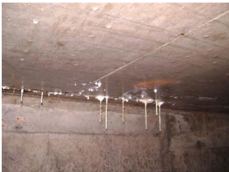
Figura 11 - Eflorescência na forma de estalactite em reservatório
