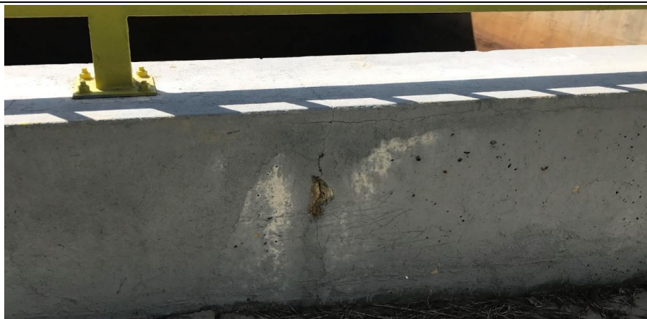
Presença de fissura de movimentação térmica e eflorescências em parede externa do tanque. Nota-se a existência de pequenos vazios de concretagem, que podem facilitar a entrada de agentes agressivos ao concreto.
