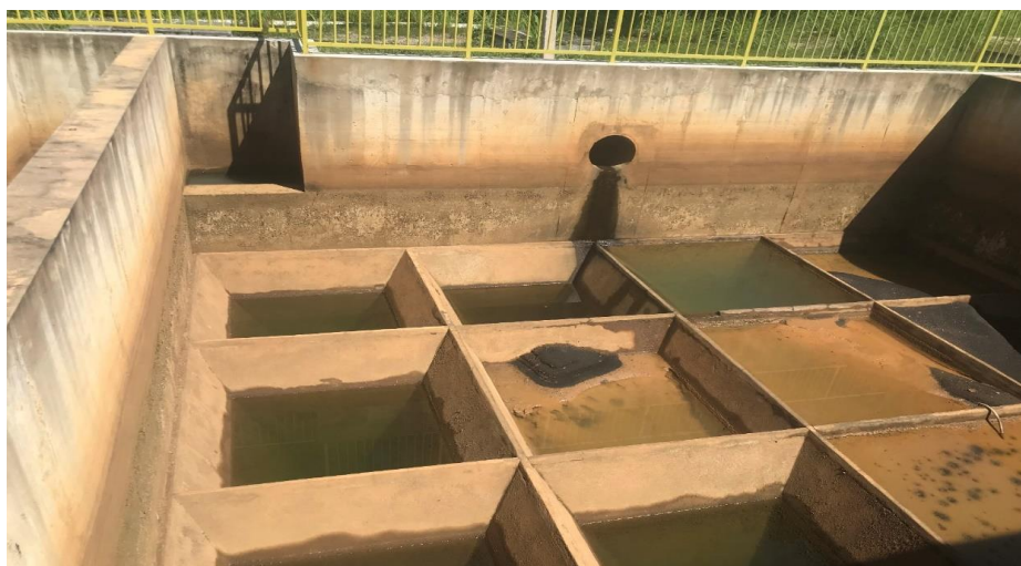
Presença de bolor/mofo nas paredes do tanque.
