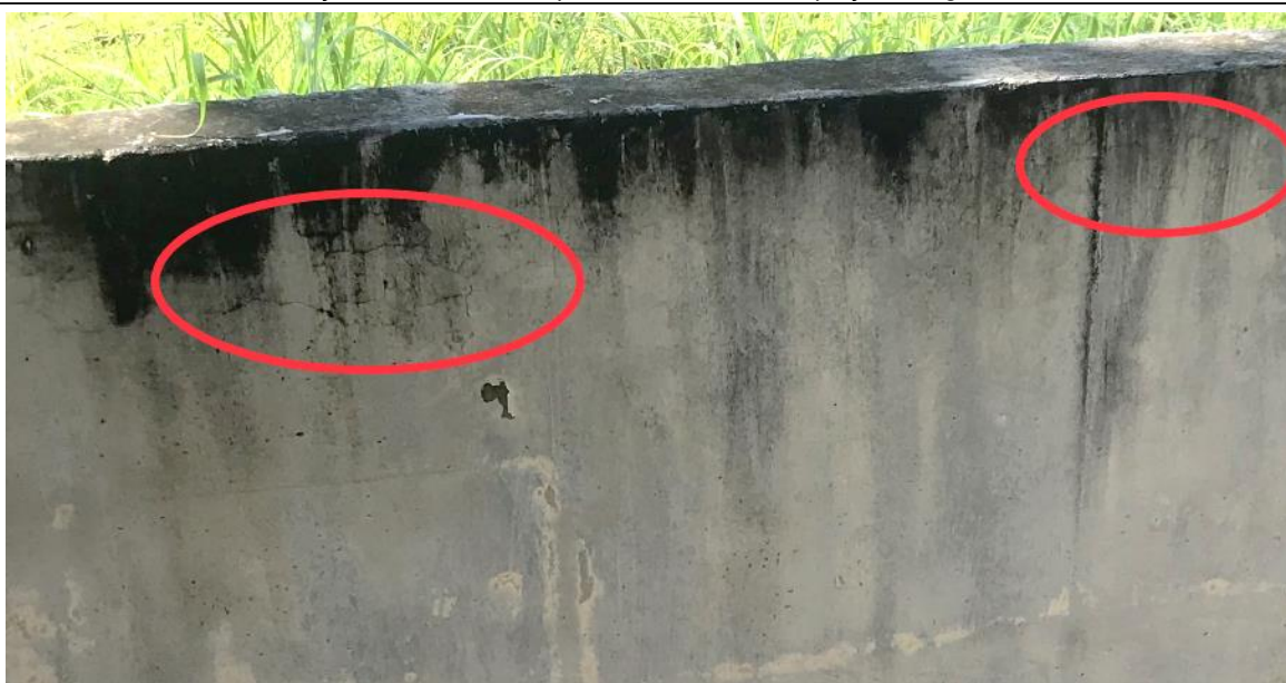
Fissuras ocasionadas por variação higrótérmica nas paredes do canal de captação de água bruta (em destaque).
