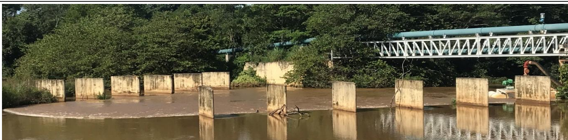
Presença de bolor/mofo nas estruturas da barragem de nível.
