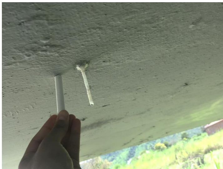
Eflorescência na forma de estalactite em laje de fundo do canal de entrada e coagulação.
