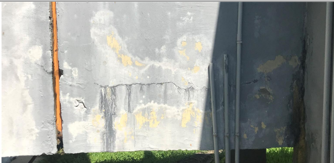
Eflorescências e machas de umidade em fissura e presença de bolor/mofo na parede do canal de entrada e coagulação.
