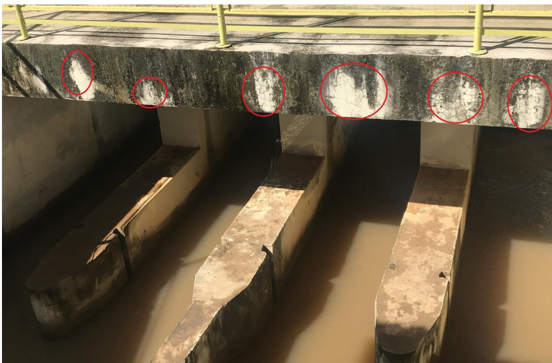
Canais de entrada do gradeamento com presença de mofo/bolor e fissuras de variação higratérmica (em destaque).
