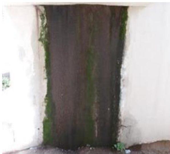
Figura 7 - Bolor em parede de estação de tratamento
