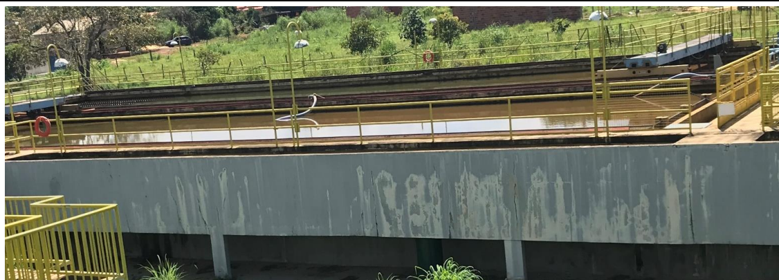
Parede externa dos decantadores com a presença de fissuras, eflorescências e bolor/mofo.
