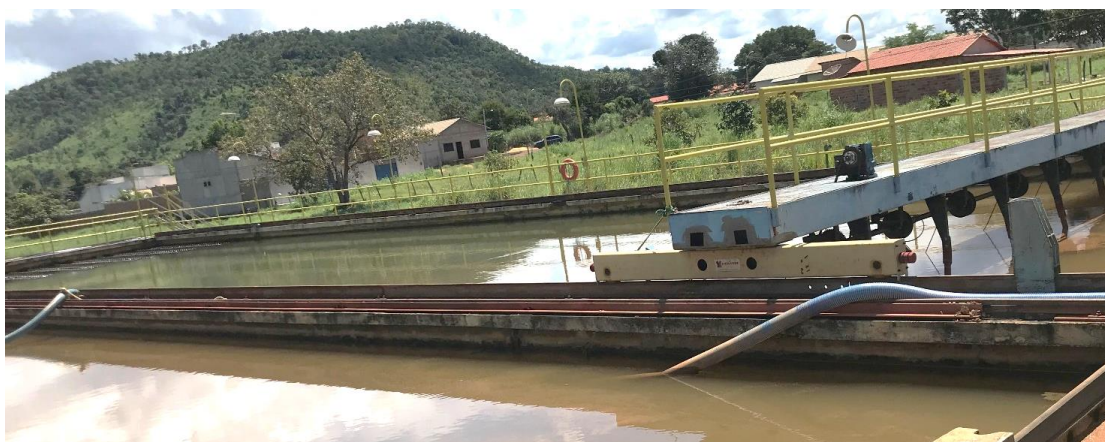
Presença de bolor/mofo nas paredes internas dos decantadores.
