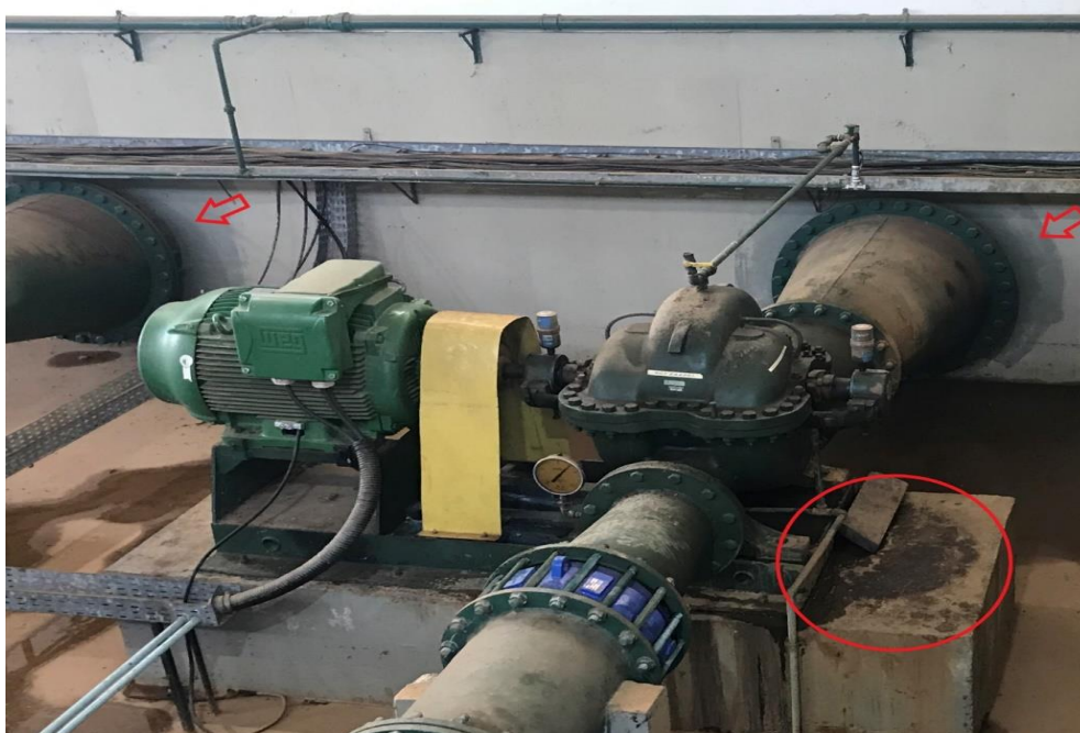
Vazamento de água proveniente das adutoras e presença de bolor/mofo na base da bomba
