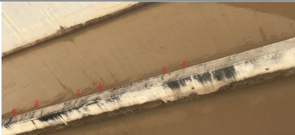
Canal de desaneração apresentando degradação média do concreto com exposição de agregados graúdos, manchas de bolor/mofo e presença de fissuras lineares indicativas de processo de corrosão por carbonatação (em destaque).
