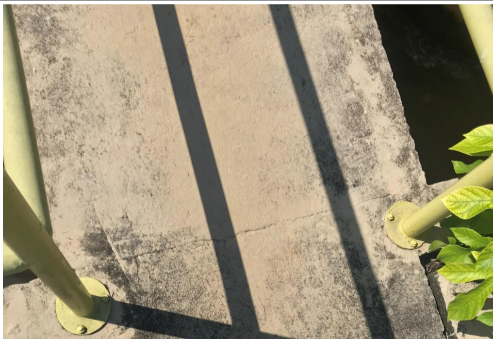
Fissura horizontal que possivelmente ocorreu devido a formação de junta fria de concretagem, por conta da concretagem de peças estruturais em diferentes etapas e/ou períodos de tempo.
