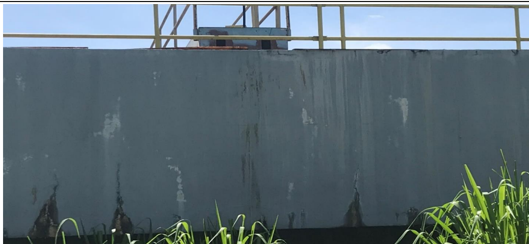
Parede externa do decantador com presença de fissuras de movimentação da estrutura, bolor/mofo e eflorescências.
