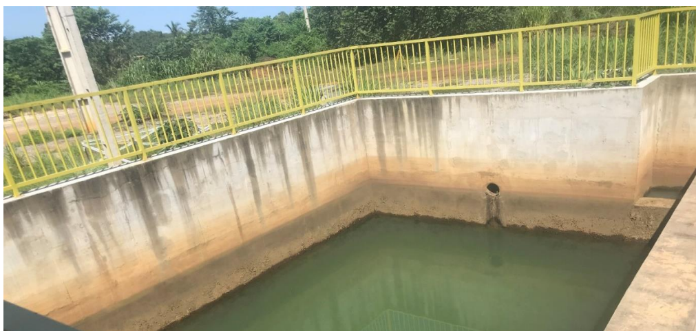
Presença de bolor/mofo nas paredes internas do tanque de água recuperada.
