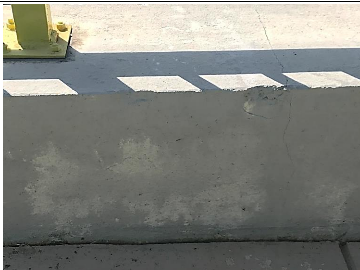
Fissura por movimentação da estrutura e eflorescência na parede externa do tanque. Nota-se a presença de um vazio no concreto, originado por provável falha durante o processo de concretagem.
