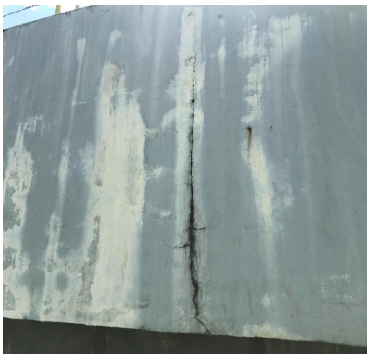
Fissura em provável junta de concretagem com presença de eflorescências e bolor/mofo devido a infiltração.
