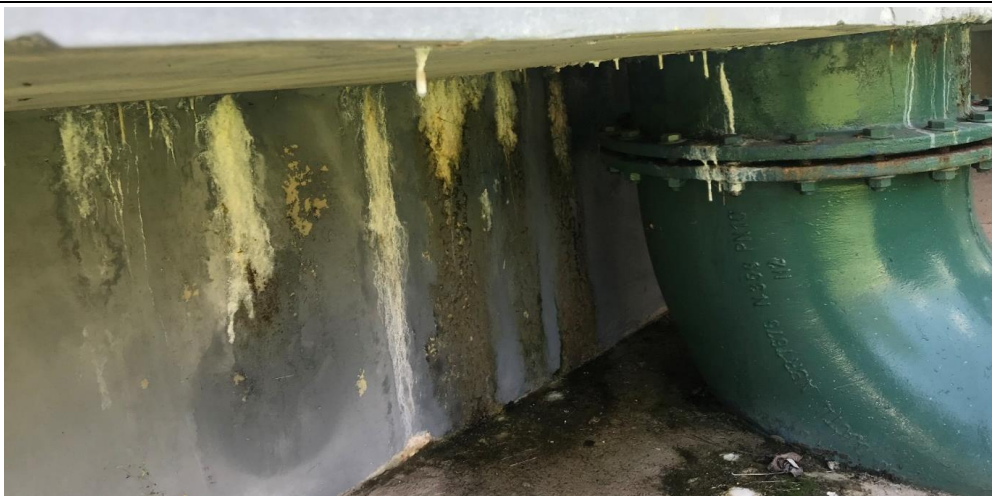
Parede externa dos filtros com presença de eflorescências, manchas de umidade e bolor/mofo.
