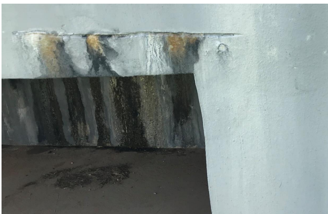
Eflorescência e bolor/mofo em provável reparo feito anteriormente.
