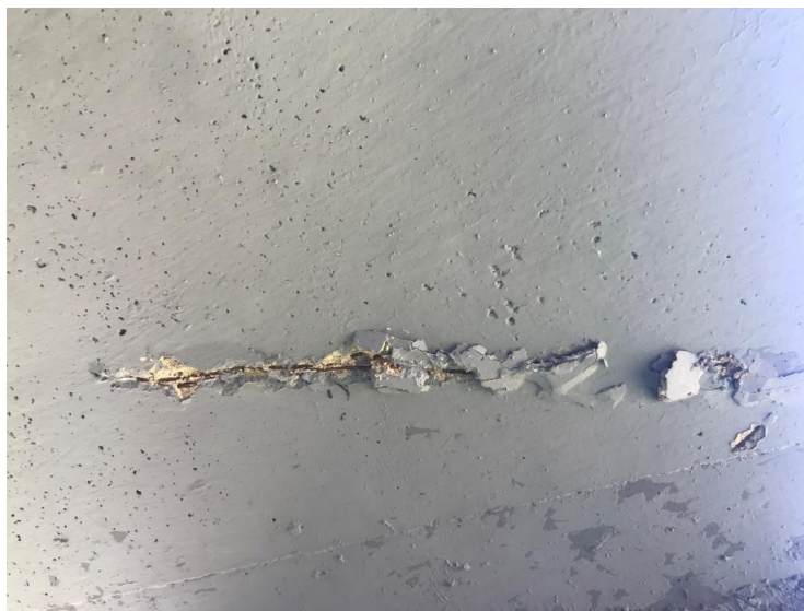
Corrosão de armadura generalizada, indicando processo de corrosão por carbonatação e deslocamento do concreto em laje de fundo do canal. Nota-se a presença de pequenos vazios de concretagem, que podem facilitar a entrada de agentes agressivos ao concreto.
