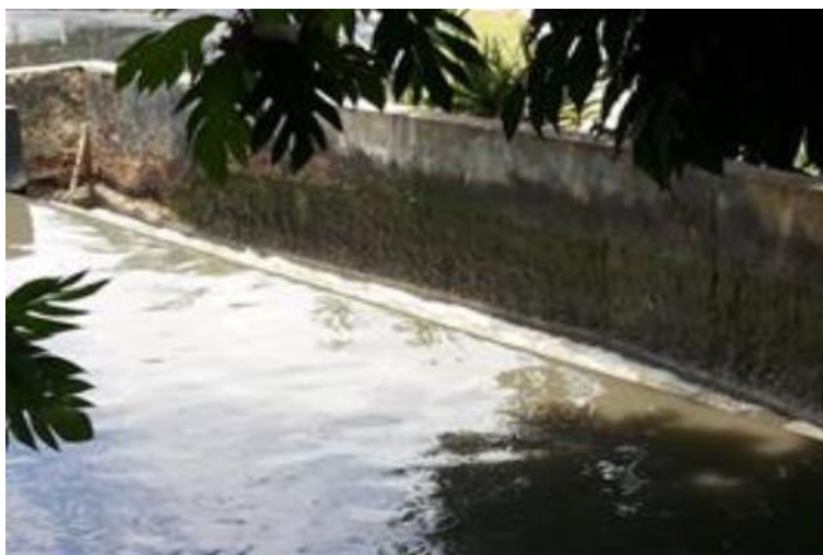
Figura 8 - Bolor em tanque de estação de tratamento
