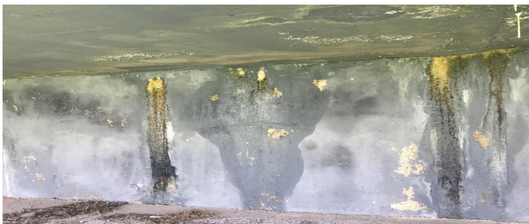
Manchas de umidade indicativas de falhas na impermeabilização, bolor/mofo e eflorescências na parede e no teto na forma de estalactites.
