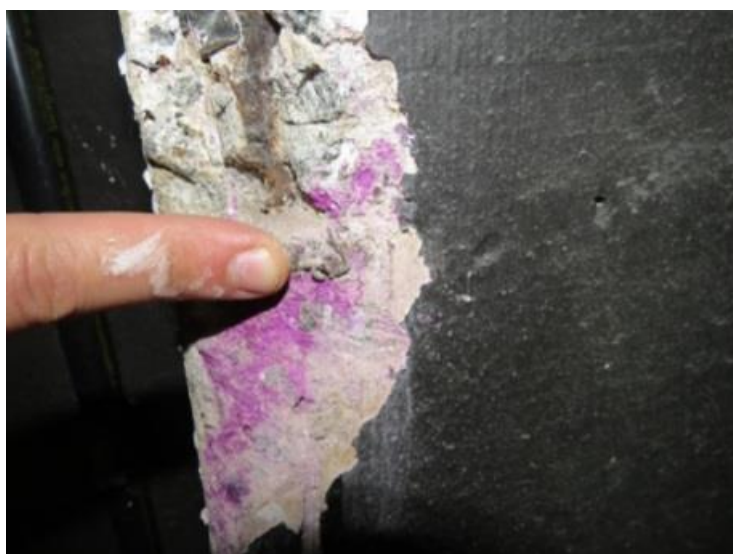
Figura 24 - Aplicação de fenolftaleína para determinação da frente de carbonatação
