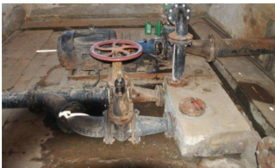
Figura 9 - Manchas de umidade provenientes de vazamentos
