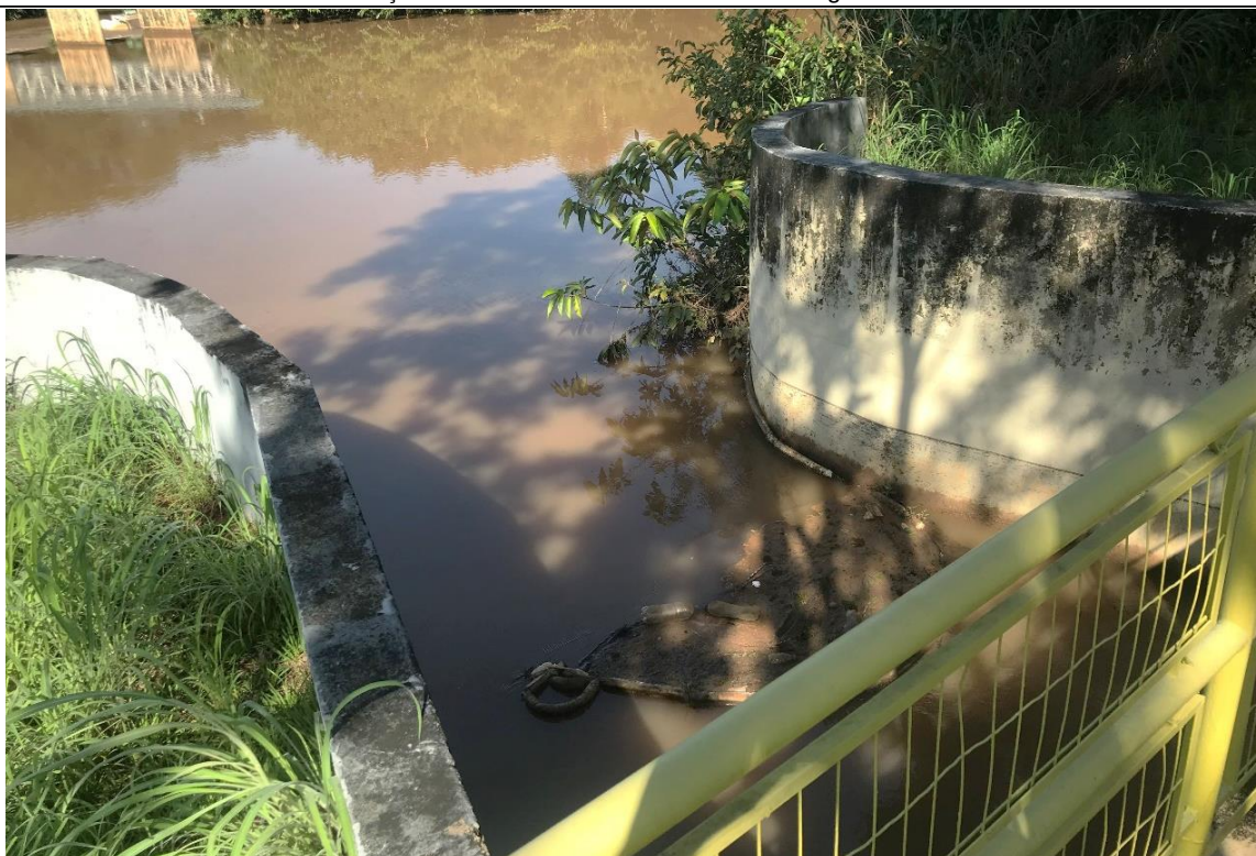
Presença de bolor/mofo nas paredes do canal de captação de água bruta.
