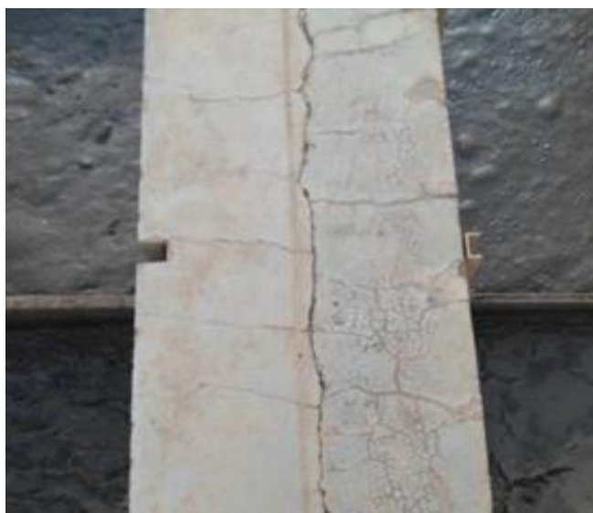
Figura 6 - Trincas e fissuras nas estruturas dos tanques
