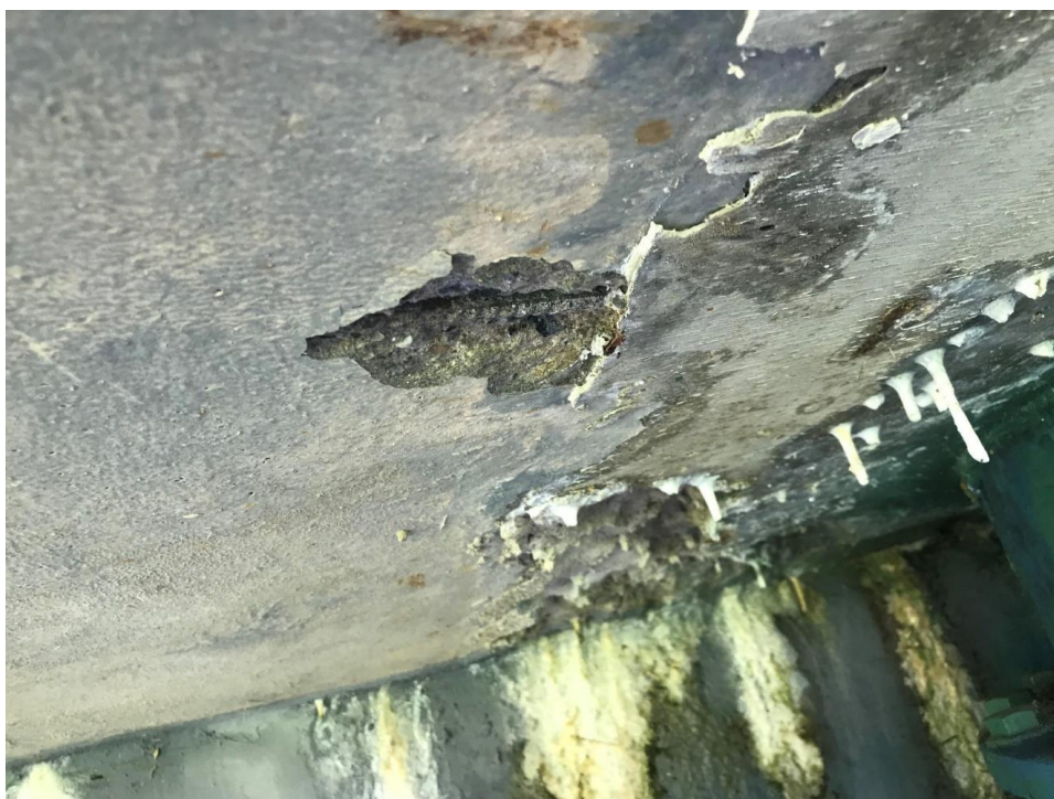
Corrosão de armadura na laje de fundo dos filtros.
