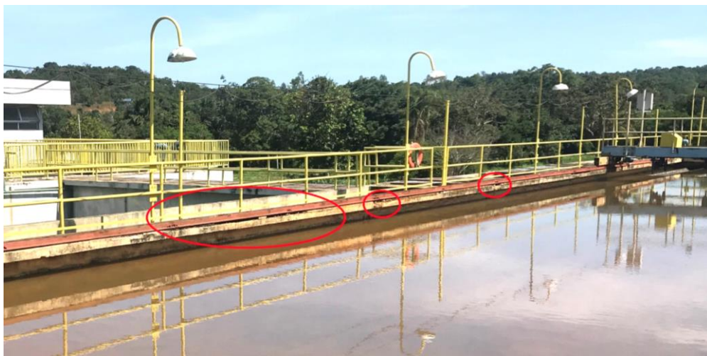
Presença de mofo/bolor nas paredes dos decantadores. Nota-se também a degradação do concreto ocasionada pela instalação e utilização dos trilhos dos removedores de lodo (em destaque).
