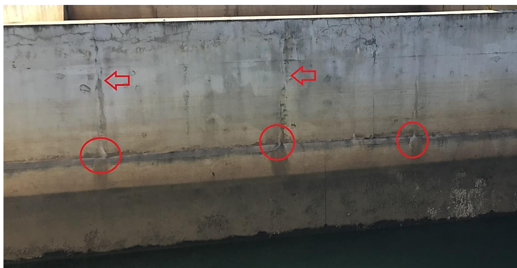
Presença de fissuras resultante de movimentação da estrutura (em destaque) e de variações higrotérmicas na parte superior. Nota-se também, a presença de eflorescências na parte inferior da parede (em destaque).
