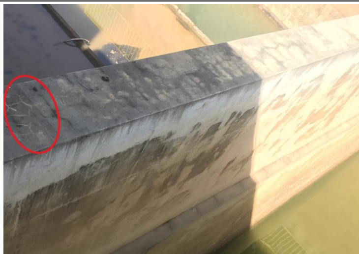
Presença de fissuras higrotérmicas (em destaque) e bolor/mofo ocasionados por umidade.
