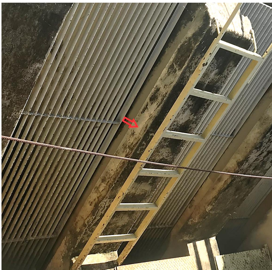
Gradeamento com bolor/mofo em sua estrutura e presença de fissura por dilatação térmica diferencial entre o aço da escada e o concreto da estrutura (em destaque).
