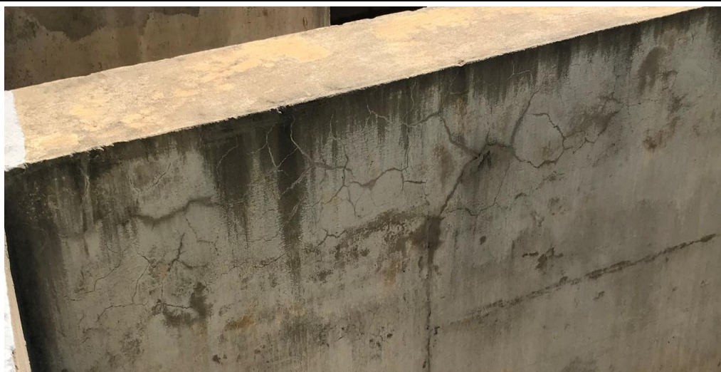
Presença de fissuras higrotérmicas devido a existência de umidade na estrutura.
