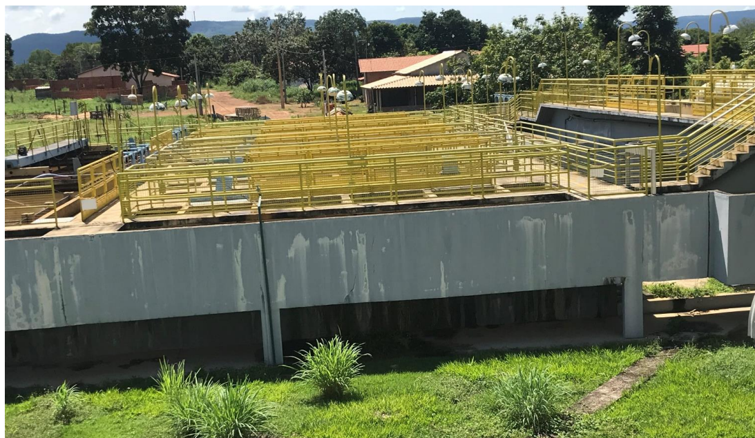
Parede externa dos floculadores com presença eflorescências, fissuras e mofo/bolor.
