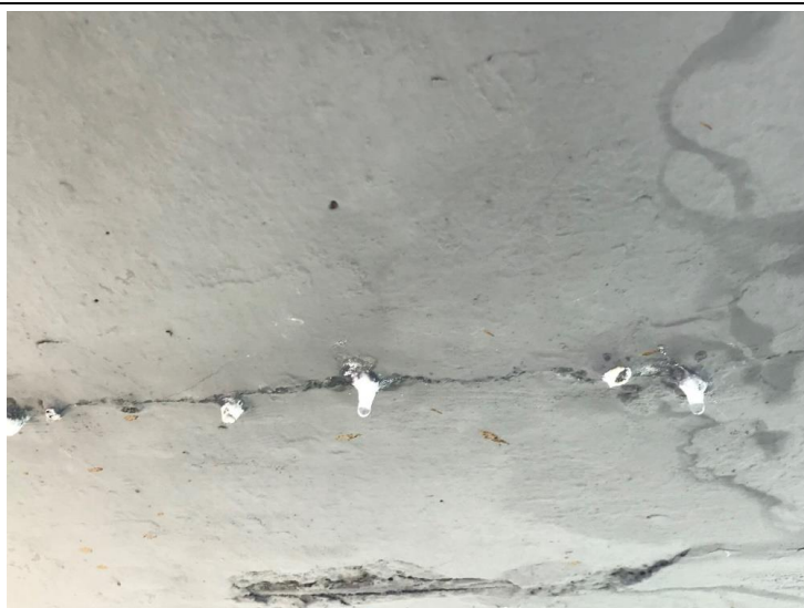
Formação de eflorescências na forma de estalactites em aparente junta fria de concretagem na laje de fundo do canal, manchas de umidade indicando falhas na impermeabilização degradação profunda do concreto com perda de cobrimento e exposição da armadura.
