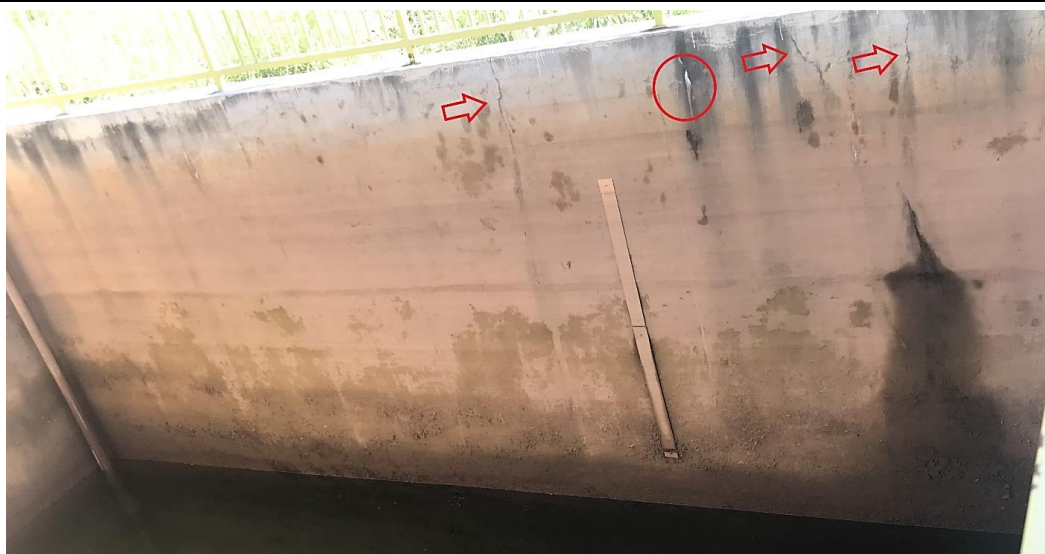
Presença de bolor/mofo, eflorescência (em destaque) e fissuras provenientes de movimentação da estrutura (em destaque) nas paredes do tanque.
