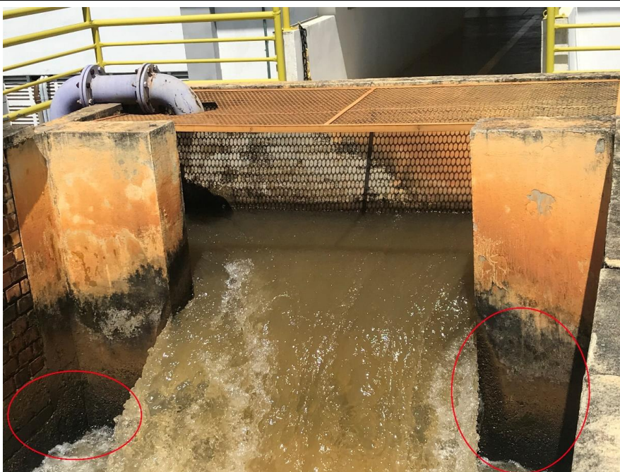
Degradação média do concreto com aparecimento dos agregados graúdos (em destaque) e presença de bolor/mofo no canal de entrada.
