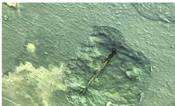
Corrosão de armadura na laje de fundo dos floculadores
