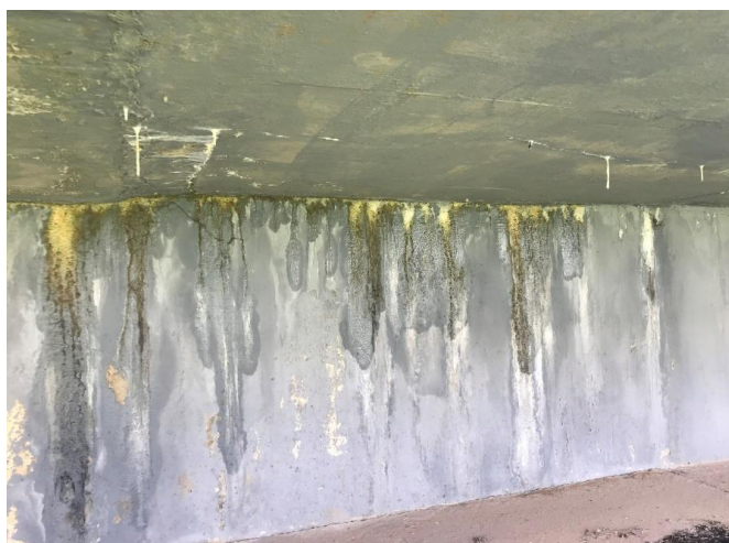
Parede externa dos floculadores com manchas de umidade, indicativas de falhas na impermeabilização, bolor/mofo e eflorescências. Presença também de eflorescências na laje de fundo em forma de estalactites.
