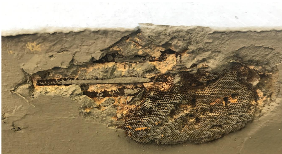
Corrosão de armaduras e deslocamento do concreto.
