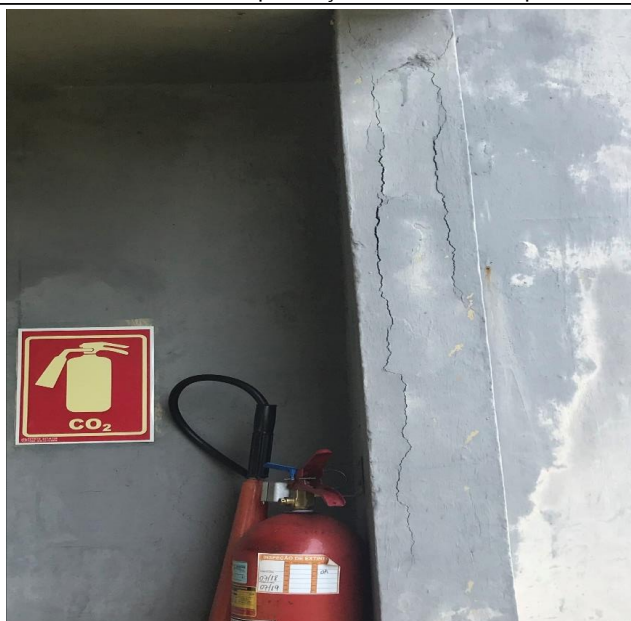
Pilar com fissuras lineares indicativas de processo de corrosão por carbonatação e parede com manchas de umidade (à esquerda) por provável falha no sistema de impermeabilização e eflorescências (à direita).
