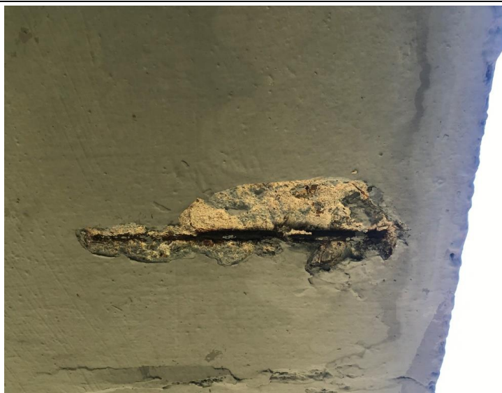
Laje de fundo do canal com corrosão de armadura generalizada, indicativa de corrosão por carbonatação, deslocamento do concreto e manchas de umidade indicando falhas na impermeabilização.
