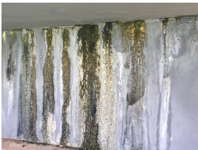
Parede externa dos floculadores com manchas de umidade, indicativas de falhas na impermeabilização, bolor/mofo e eflorescências.
