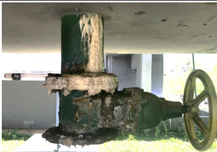
Vazamento de água junto à tubulação, eflorescência e corrosão intensa com perda de seção na tubulação.
