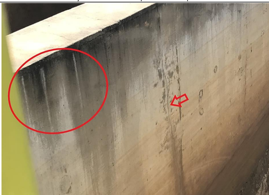
Fissura proveniente de movimentação da estrutura (em destaque), eflorescências (em destaque) e bolor/mofo em parede interna do tanque.
