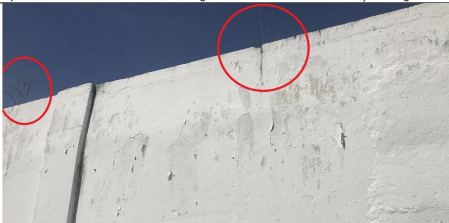
Presença de vegetação de pequeno porte se desenvolvendo no concreto (em destaque). O crescimento dessas vegetações pode gerar tensões adicionais que contribuem para a degradação do concreto e para o aumento das fissuras já existentes.
