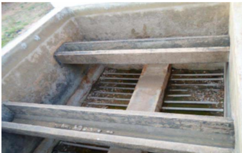
Figura 14 - Tanque de filtração com paredes de concreto degradadas
