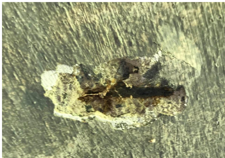
Corrosão de armadura na laje de fundo dos decantadores
