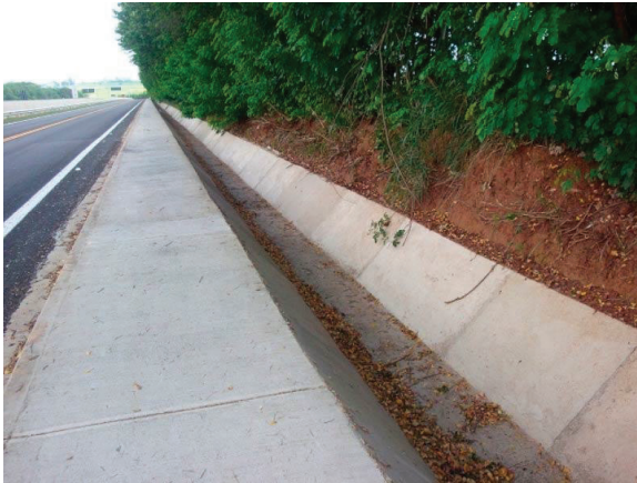
Figura 3 - Drenagem Superficial de Rodovia - Valeta
