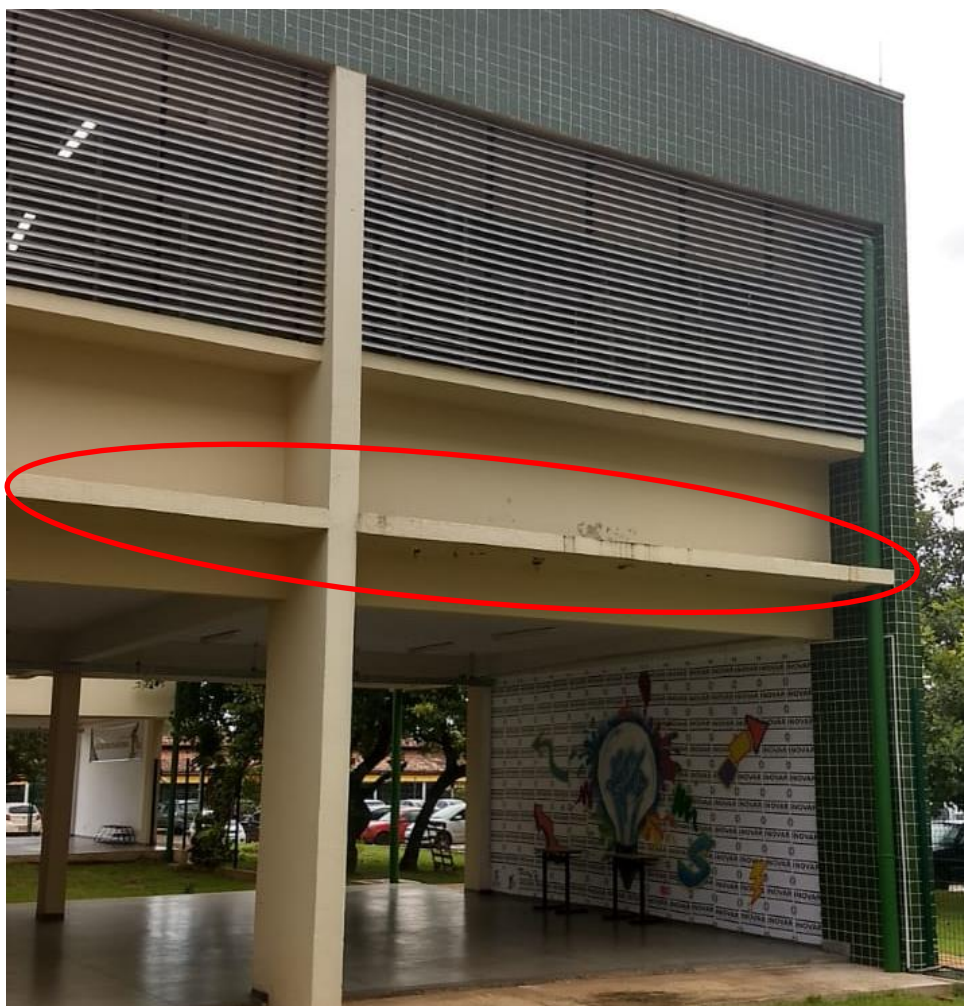
Figura 11 – Lajes abaixo das esquadrias (Bloco 16).
