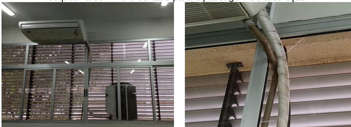
Figura 8 – Unidade condensadora disposta em frente à esquadria e canto de esquadria com vidro cortado para a passagem de tubulação.
