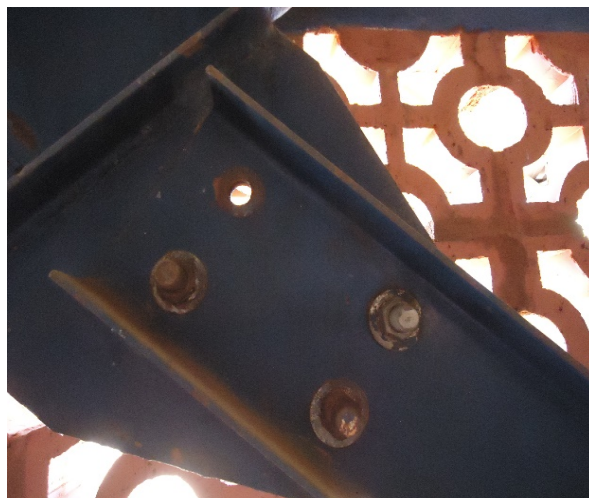
Figura 5 - Falta de elemento de ligação
