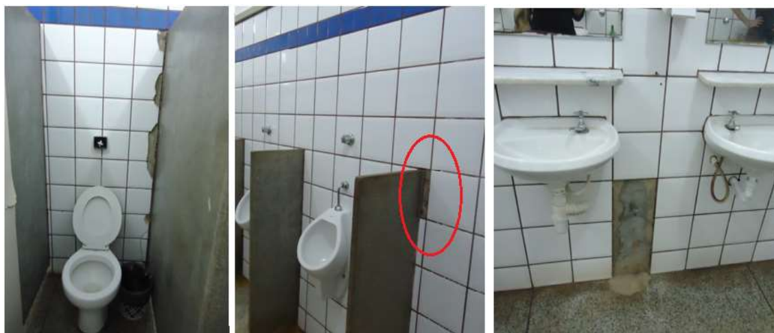
Figura 13 – Descolamento revestimento cerâmico
