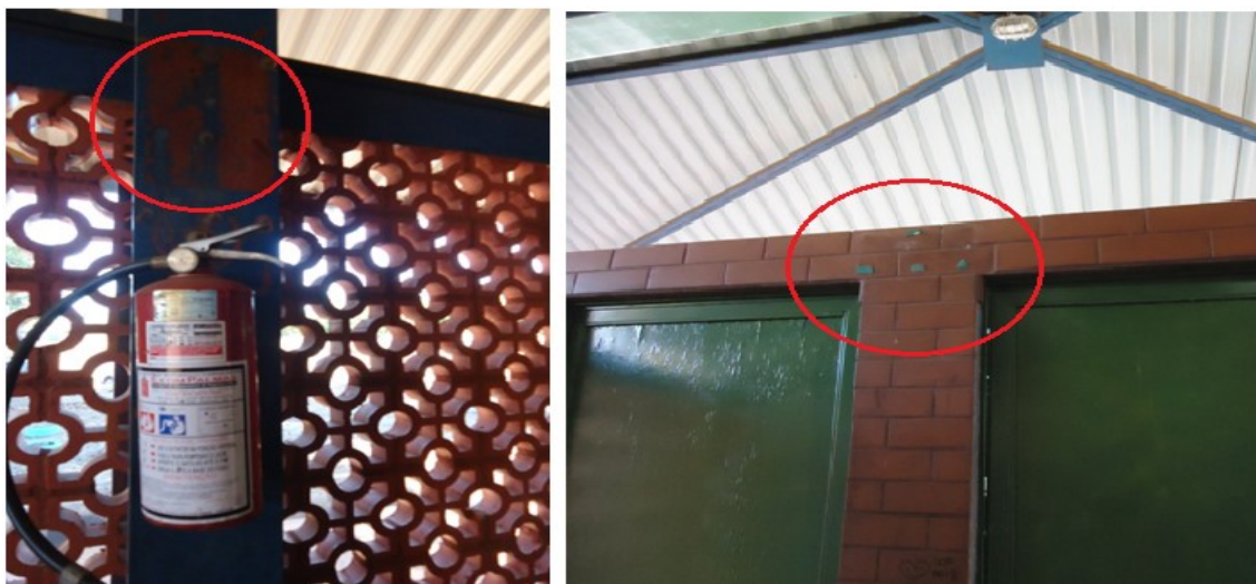
Figura 39 – Falta sinalização de emergência
