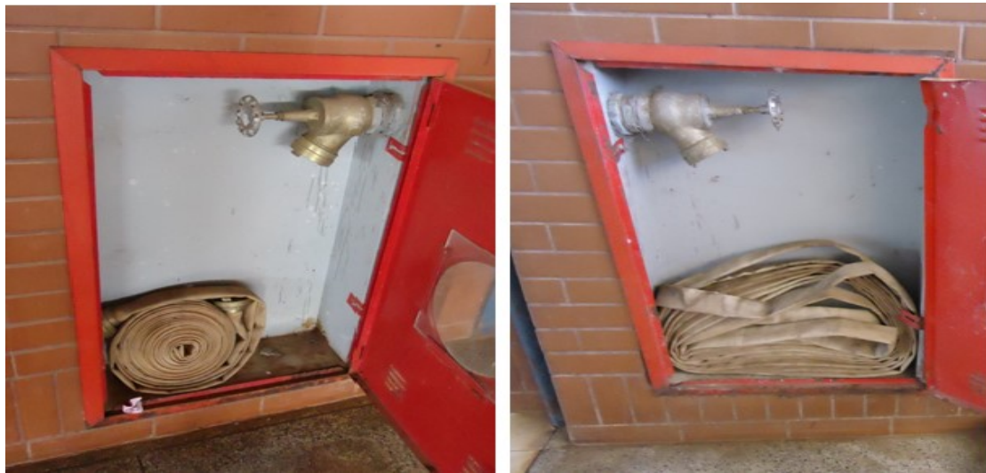
Figura 37 – Mangueiras de incêndio velhas e sujas
