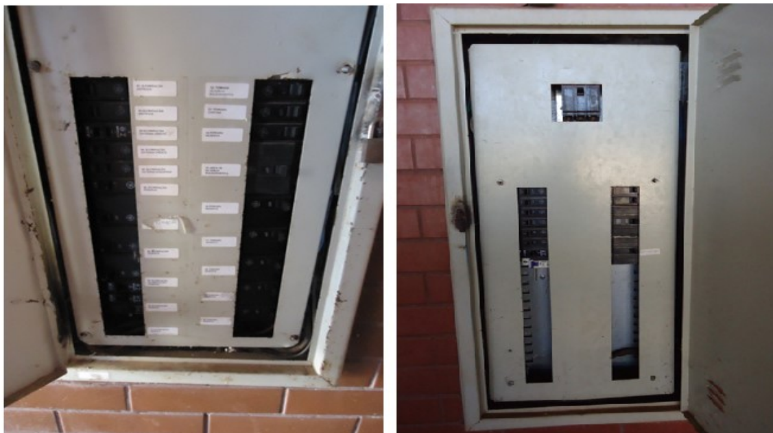
Figura 31 – Precariedade na identificação de circuitos
