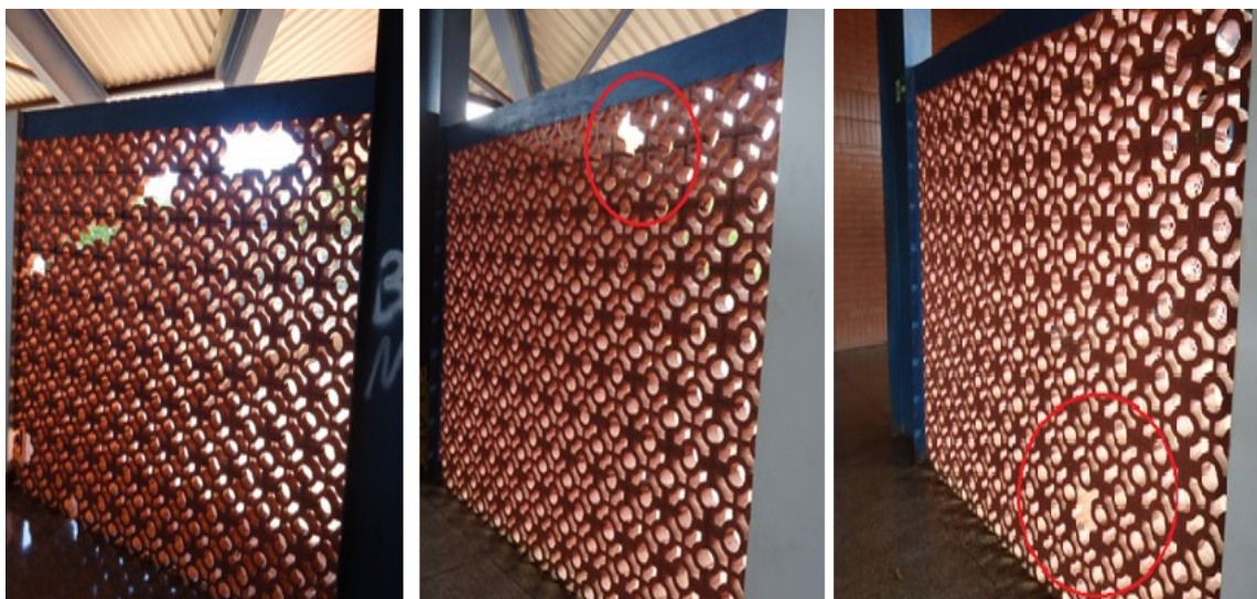
Figura 6 – Tijolos vazados quebrados
