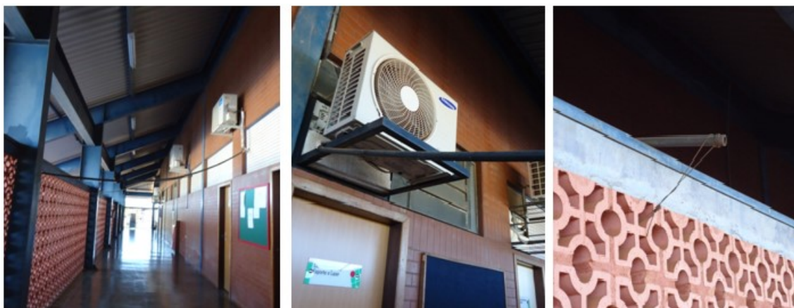
Figura 34 – Mangueiras de água que saem dos condicionadores de ar
