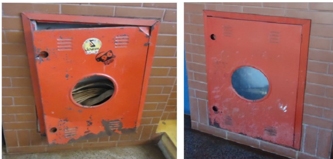
Figura 38 – Caixas de incêndio danificadas
