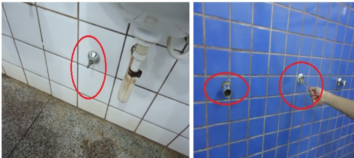
Figura 27 – Falta de acessórios sanitários
