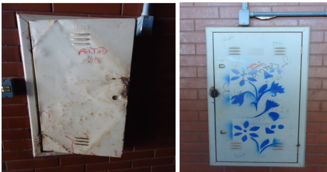
Figura 30 – Quadros de Distribuição danificados
