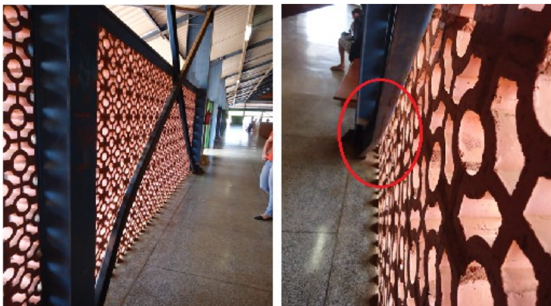
Figura 4 - Deformação localizada no contraventamento
