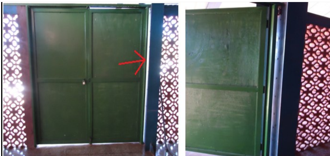
Figura 24 – Deficiência na fixação do batente
