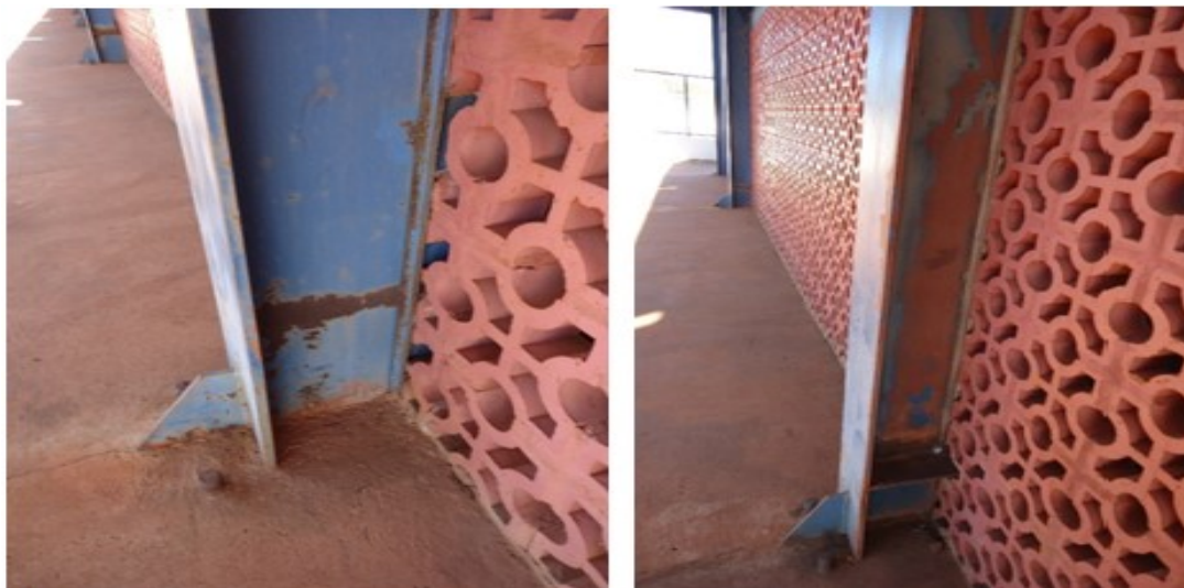
Figura 2 - Corrosão localizada e generalizada em pilares
