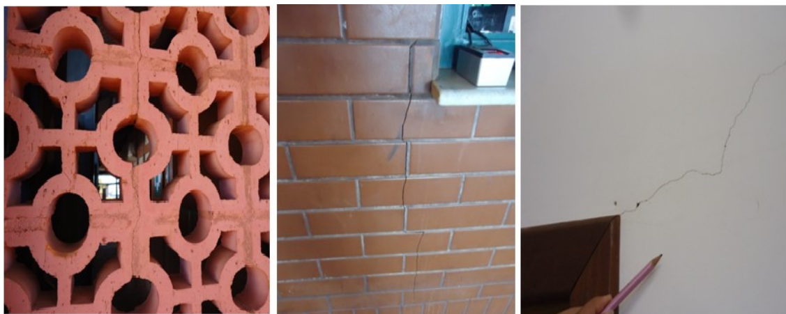
Figura 7 – Trincas e fissuras
