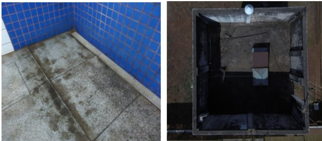
Figura 25 – Manchas de umidade
