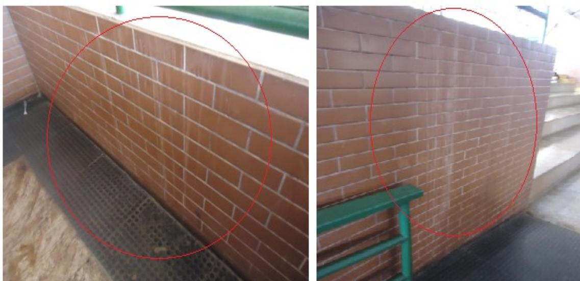
Figura 11 – Sujidades nas paredes pintadas
