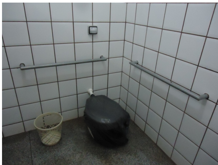
Figura 26 – Vaso sanitário interditado
