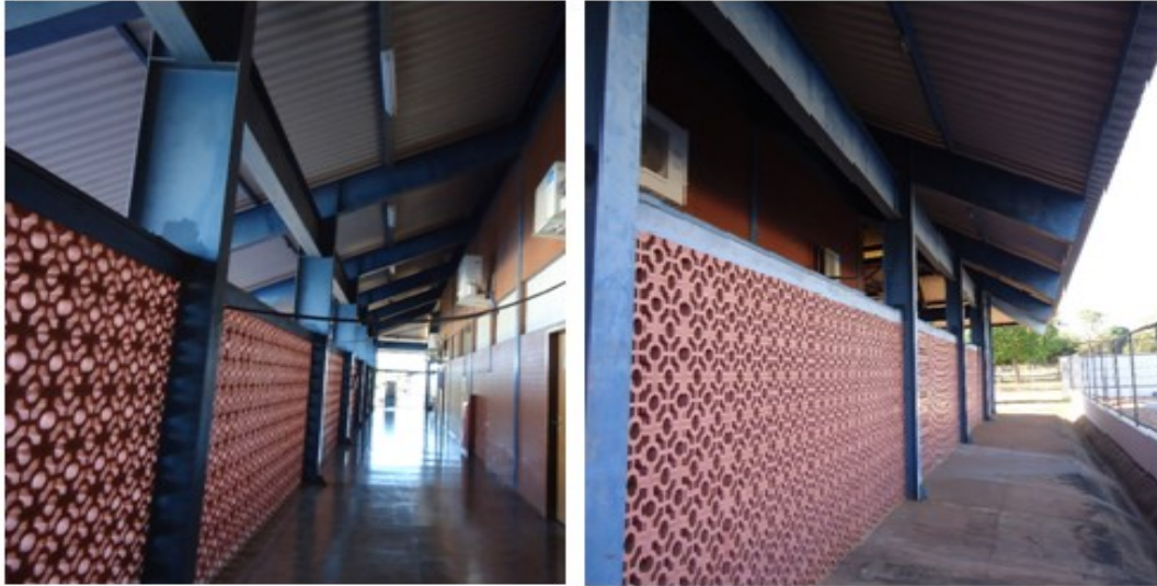
Figura 1 - Desgaste na pintura dos elementos metálicos
