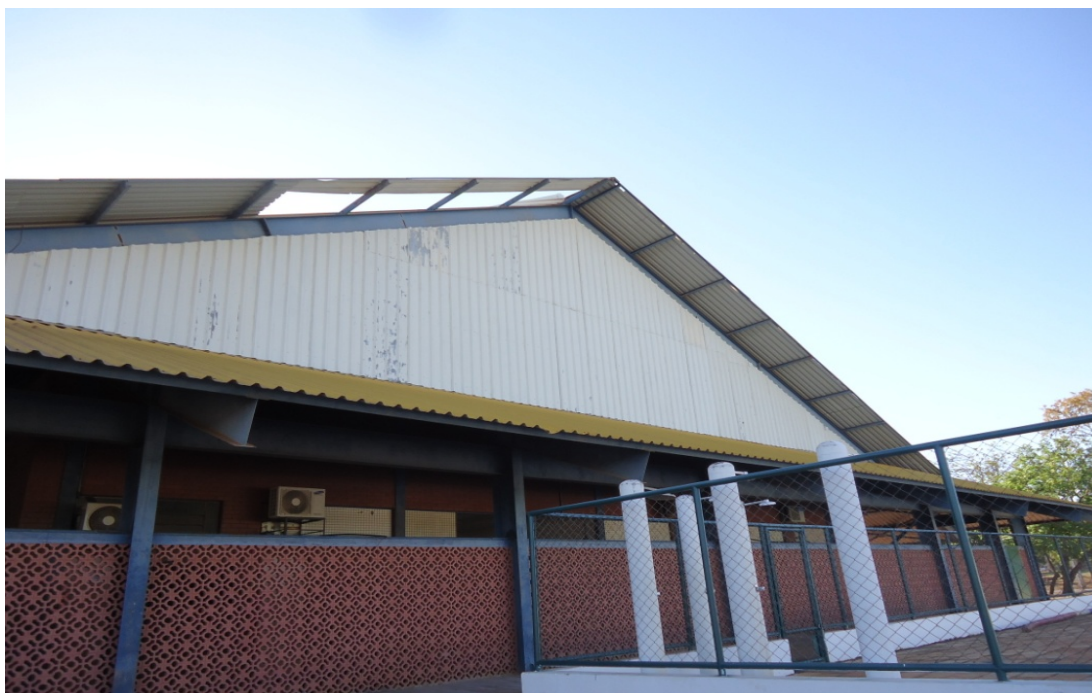
Figura 40 – Falta de peças da cobertura
