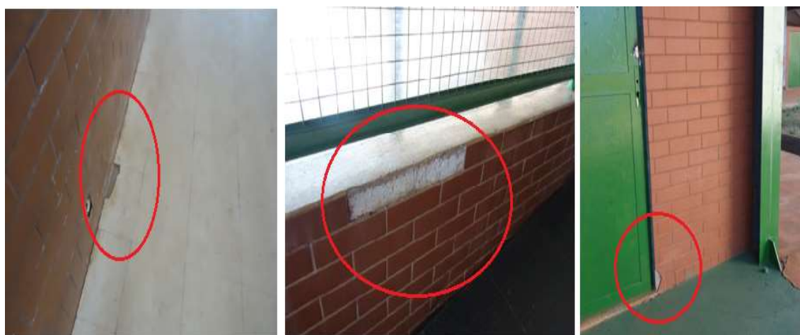
Figura 14 – Descolamento revestimento cerâmico
