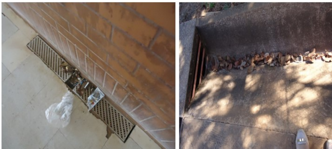
Figura 28 – Obstruções de ralos e grelhas
