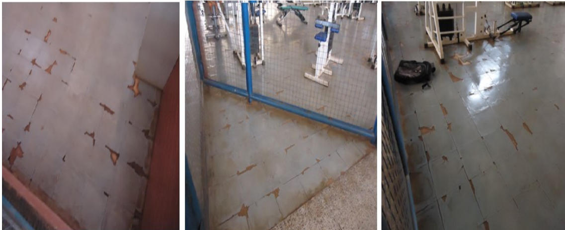
Figura 15 – Descolamento revestimento cerâmico
