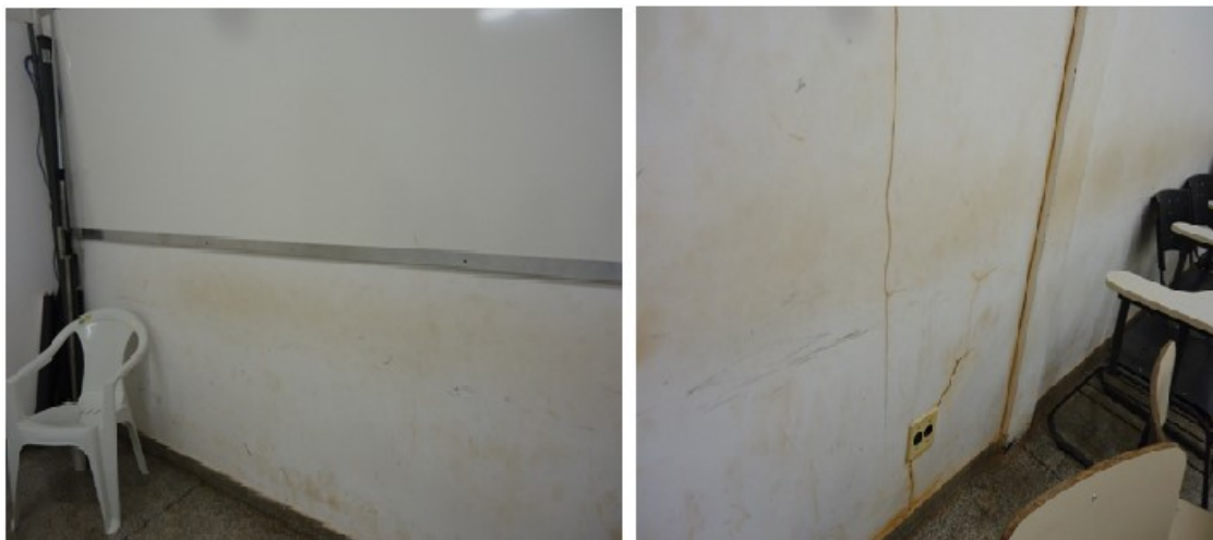
Figura 10 – Sujidades nas paredes pintadas
