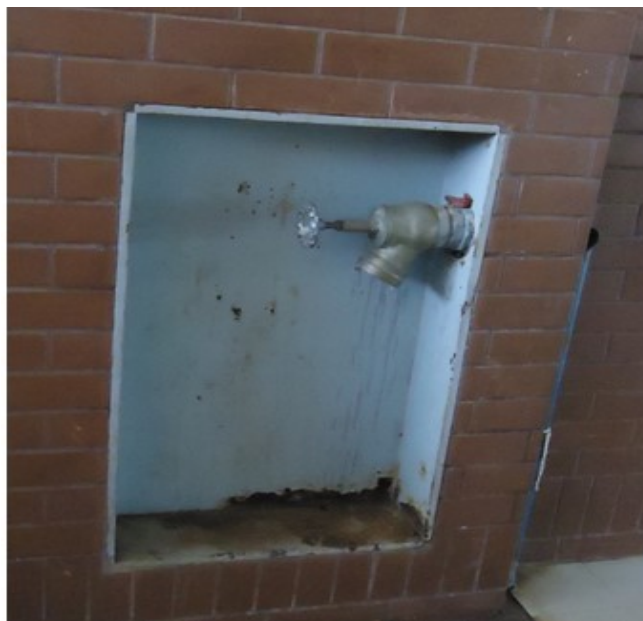
Figura 36 – Caixa de mangueira de incêndio totalmente violada
