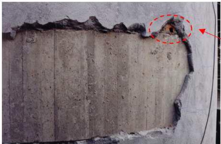
Figura 10 – Detalhe de Desplacamento somente na região de concreto
