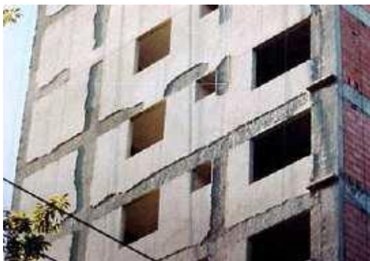
Figura 9 – Deslocamento de revestimento nas regiões de concreto armado
