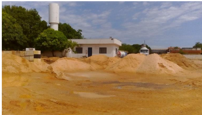
Figura 8 – Armazenamento inadequado dos agregados
