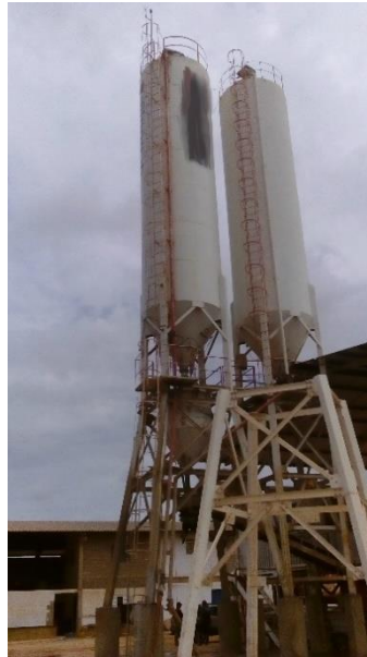
Figura 10 – Armazenamento do cimento em silos
