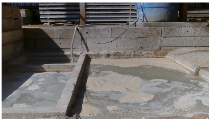
Figura 14 – Reutilização inadequada da água utilizada nos processos de preparação do concreto
