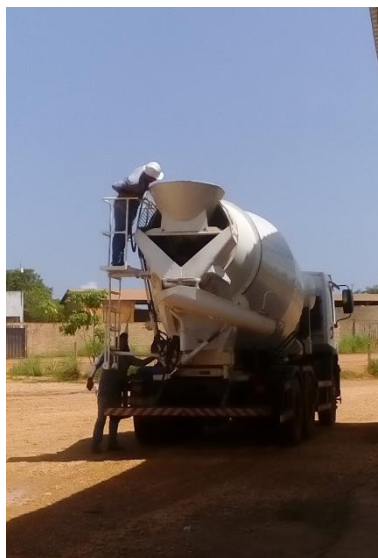
Figura 16 – Acréscimo inadequado de água ao concreto
