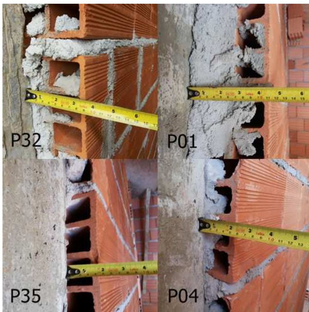
Figura 10: Incompatibilização entre Projeto Estrutural e Alvenaria.
