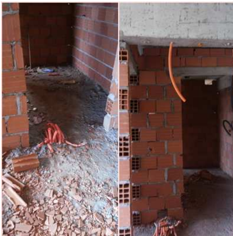
Figura 9: Ponto elétrico, antenas e telefone locados em vão de porta.
