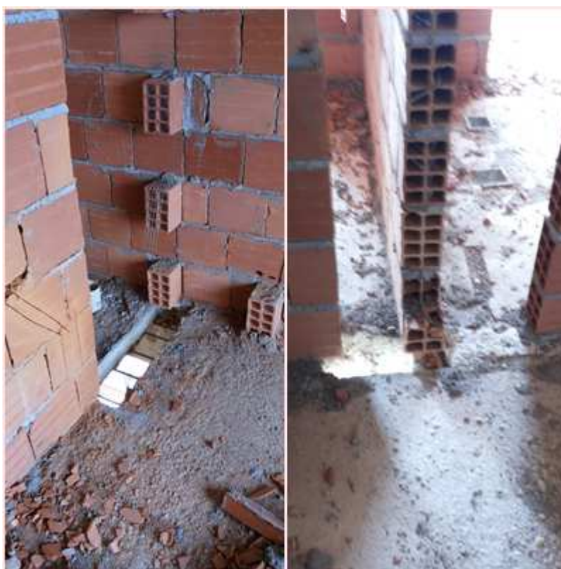
Figura 8: Shaft em local indevido.
