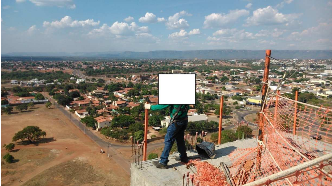
Foto9 - Falta de utilização do cinto de segurança - Empresa D
