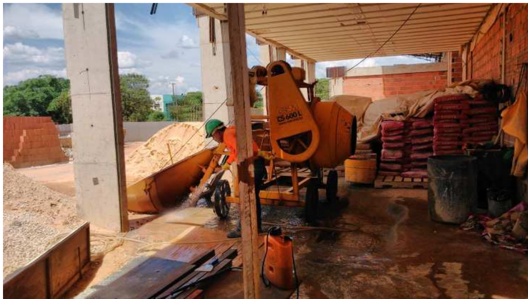
Foto5 - Acima de 10 sacos de cimento empilhados - Empresa D
