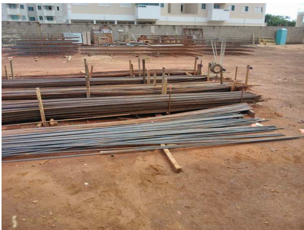
Foto8 - Pontas dos vergalhões sem proteção contra acidentes - Empresa C
