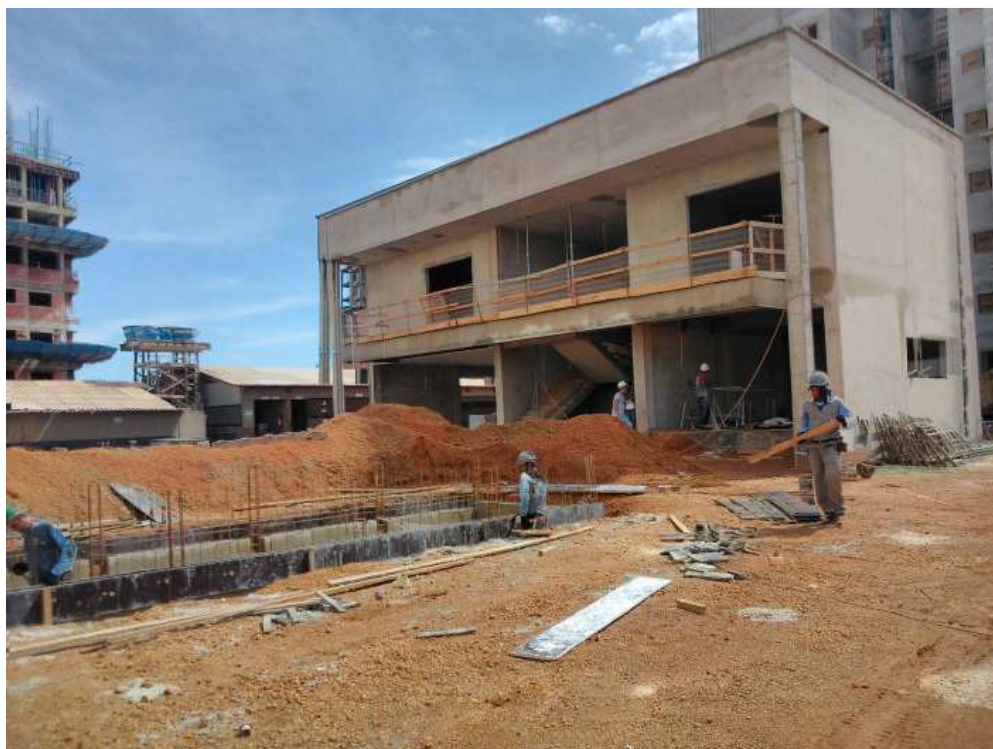
Foto7 - Pontas dos vergalhões sem proteção contra acidentes - Empresa B
