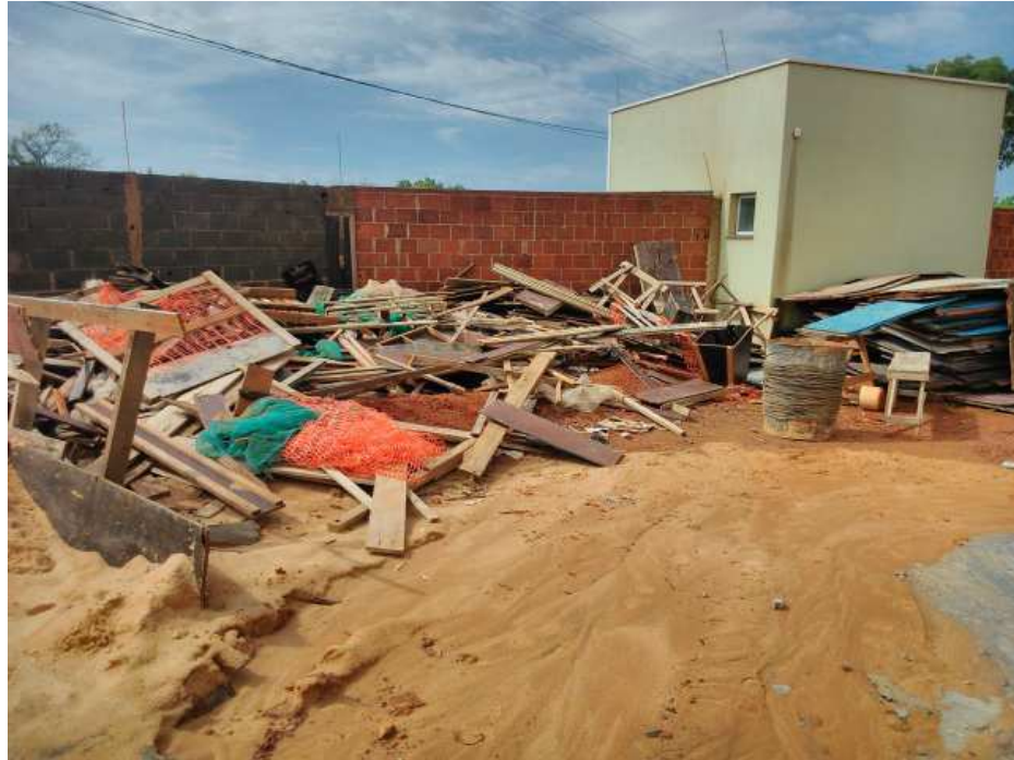
Foto2 - Armazenamento inadequado dos entulhos – Empresa C
