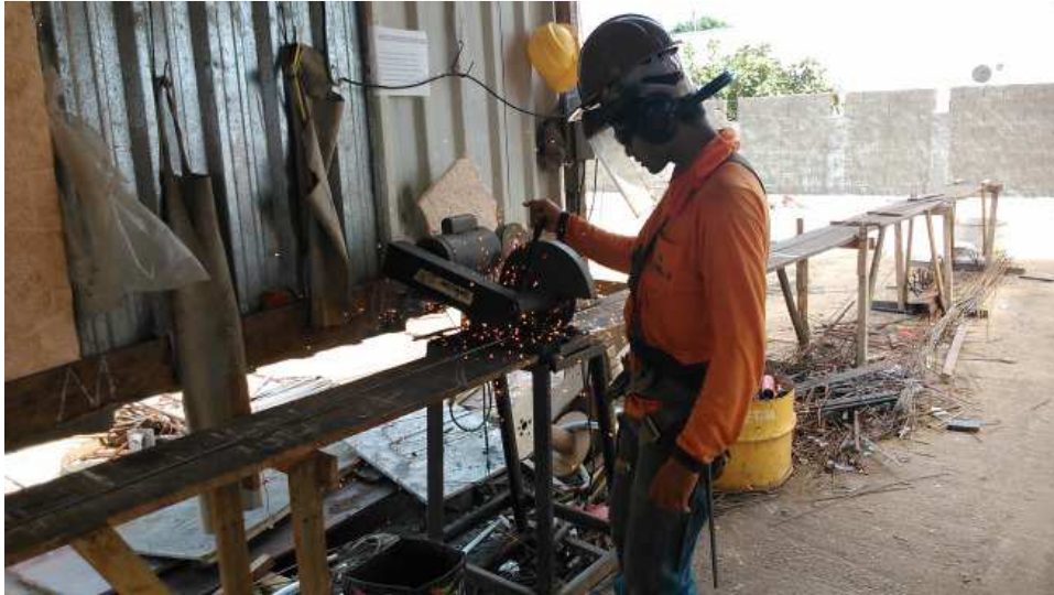
Foto9 - Falta de utilização de EPI - EmpresaD
