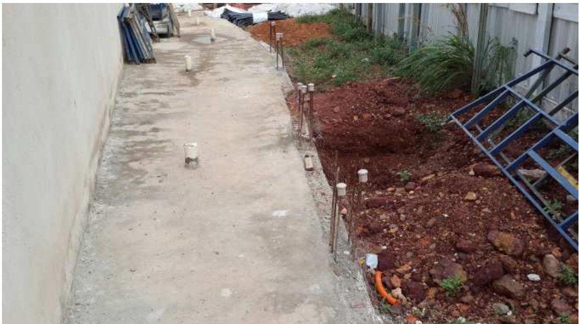
Foto6 - Pontas dos vergalhões parcialmente protegidos - Empresa A
