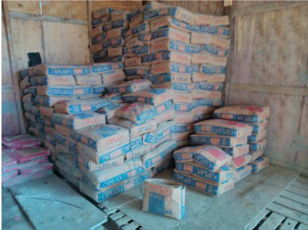
Foto4 - Acima de 10 sacos de cimento empilhados - Empresa C
