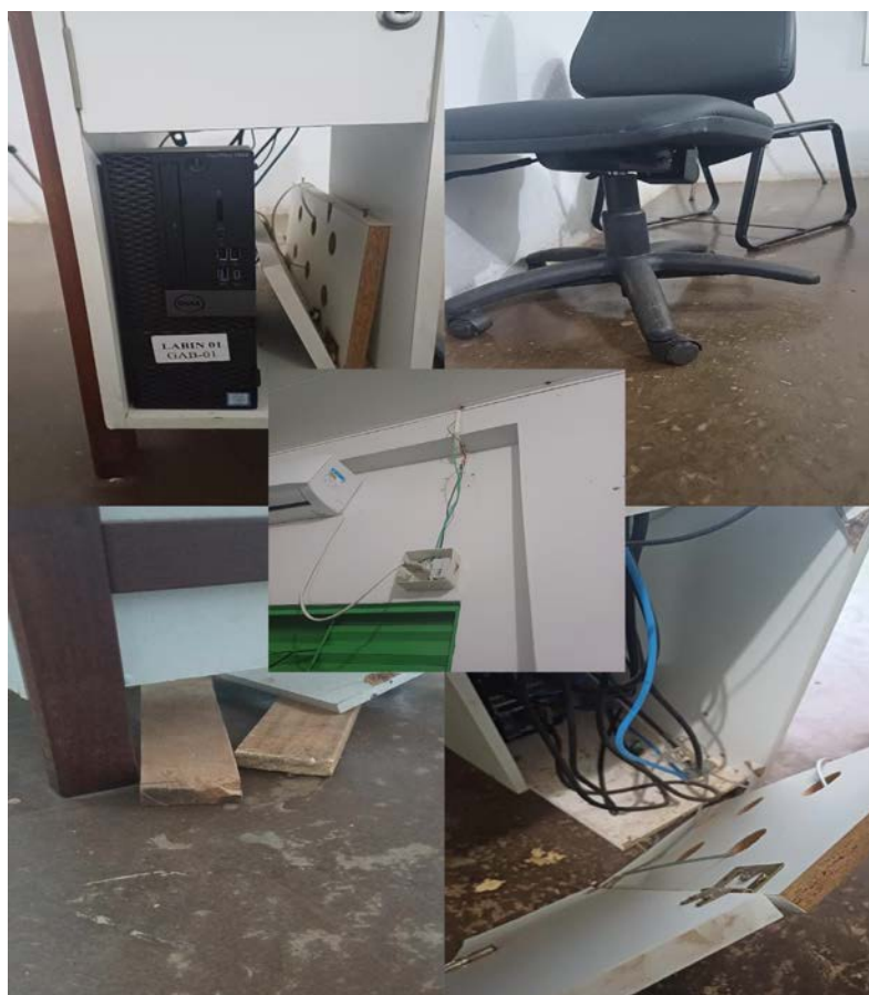
Figura 4 – Situação de bancadas, cadeiras e instalação de ar-condicionado no Laboratório de Informática 1.
