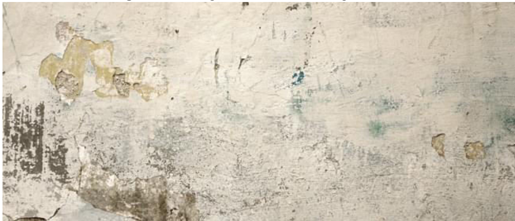
Figura 4 – Patologias em revestimentos argamassados
