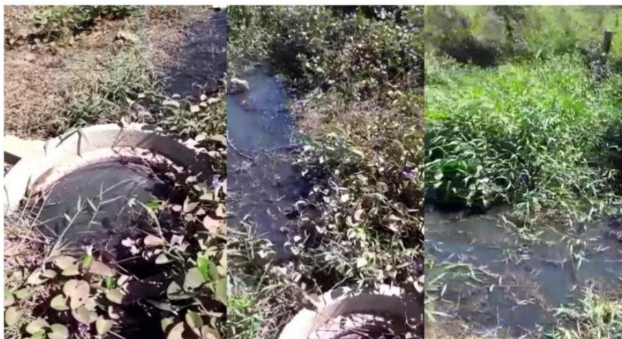
Figura 20- Problemas na estrutura da (EEE), ponto 10
