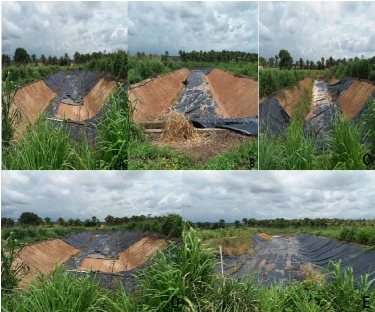
Figura 13 - Situação estrutural das valas de resíduos domiciliares do aterro sanitário da cidade de Augustinópolis -TO. A, B, C, D e E as mantas de PEAD encontram-se rasgadas e desgastadas.
