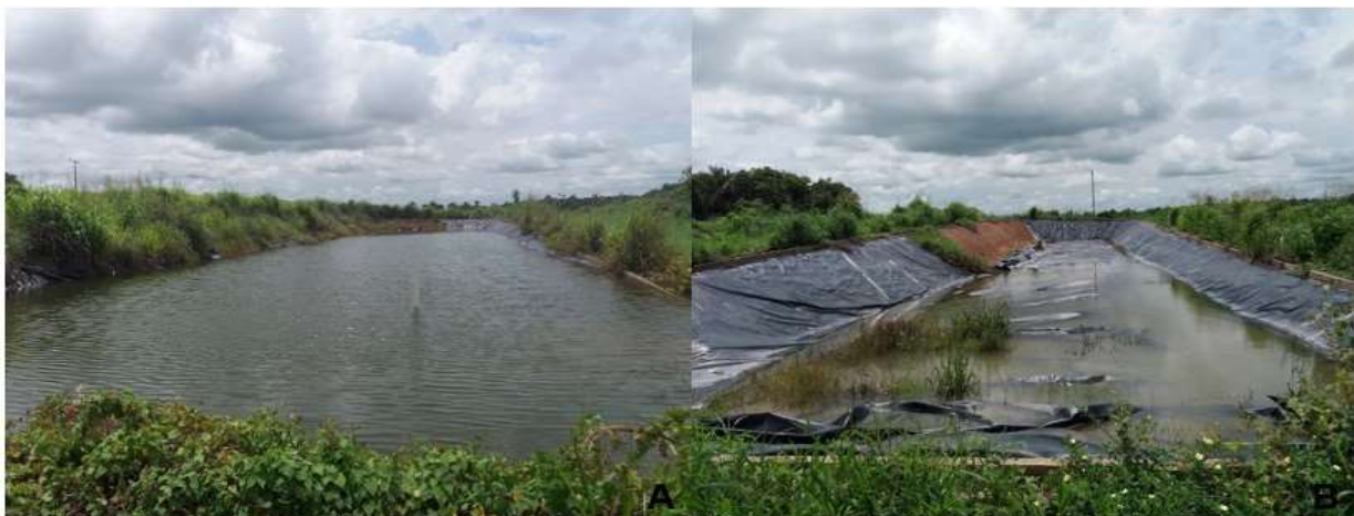
Figura 14 - Situação estrutural das valas de resíduos domiciliares do aterro sanitário da cidade de Augustinópolis -TO. A e B valas alagadas pelas águas das chuvas.
