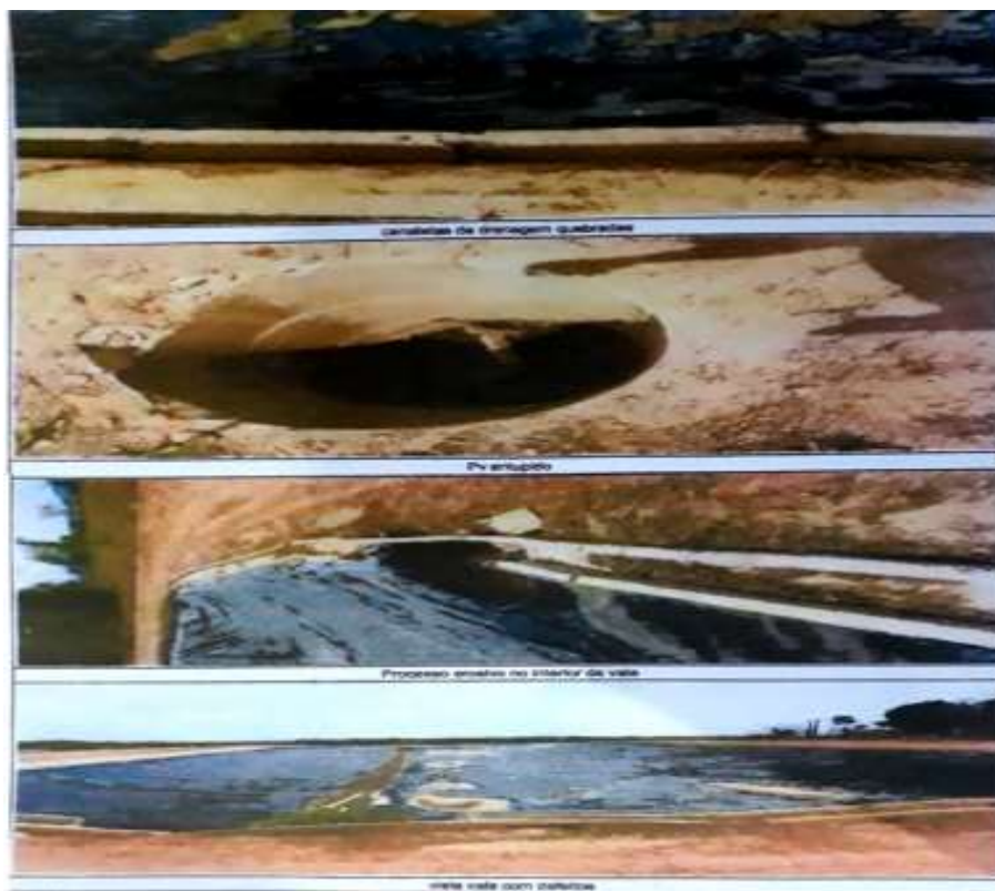
Figura 12 - Aterro sanitário da cidade de Augustinópolis -TO em estado de deterioração desde a sua conclusão em 29/11/2016.
