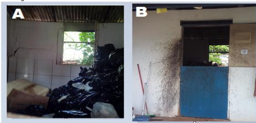
Figura 9: Fotografias do abrigo externo de resíduos; A Parte interna do abrigo externo de resíduos; B Porta do abrigo.
