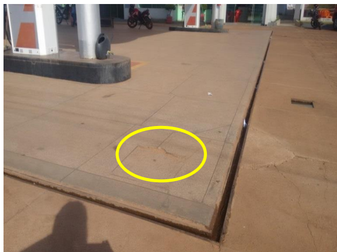
Figura 17: Desgaste no piso do postos de abastecimento
