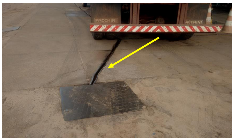
Figura 20 - Caneleta apresentando fissuras em um posto de combustíveis de Araguatins-TO
