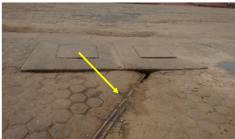
Figura 19- Obstrução de canaletas em um posto de combustíveis de Araguatins-TO.
