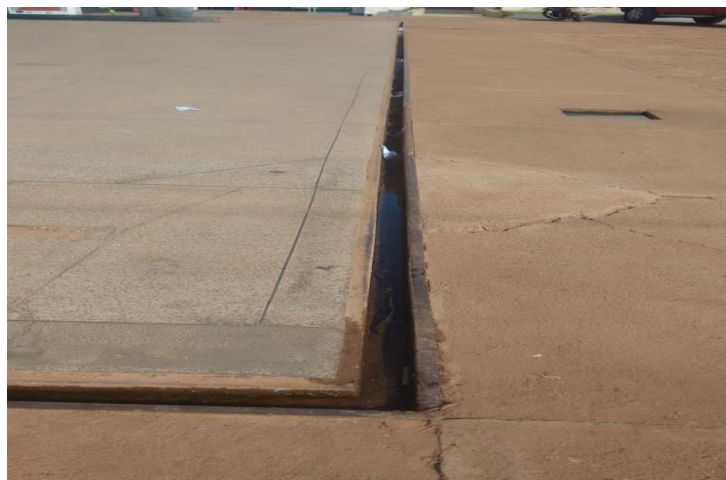
Figura 18 - Canaleta de contenção em um posto de combustível de Araguatins-TO.
